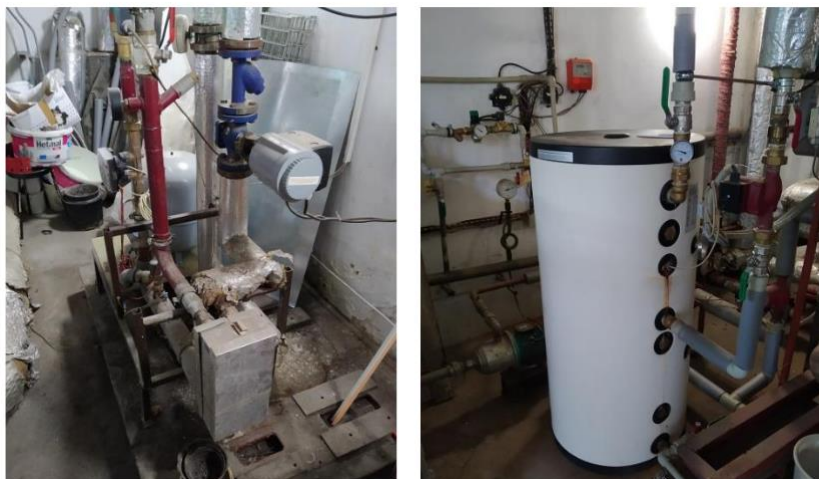
Obrázek 8: Výměňková stanice ZŠ Gorkého (vlevo výměník pro TV, vpravo zásobník TV)
