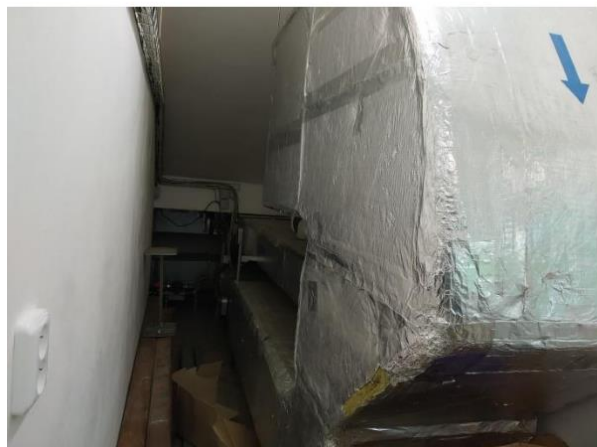
Obrázek 142: Strojovna VZT tělocvična (vlevo) a VZT kuchyně (vpravo)
