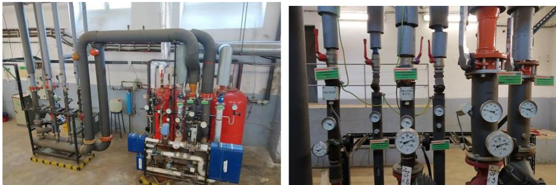
Obrázek 41: Výměníková stanice ZŠ Na Nábřeží (vlevo výměníková stanice s rozdělovačem ÚT, vpravo jednotlivé otopné větve)
