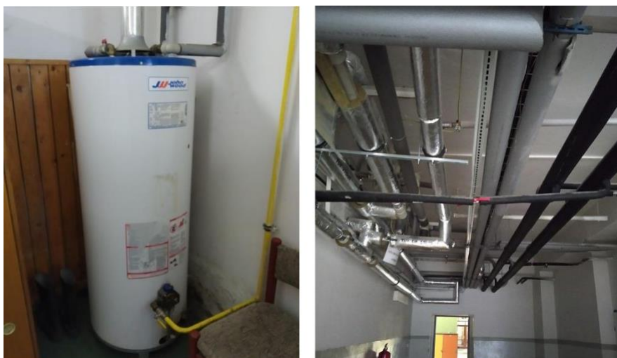
Obrázek 42: Plynový zásobníkový ohřívač TV – západní tělocvična ZŠ Na Nábřeží (vlevo), horizontální rozvody TV (vpravo)
