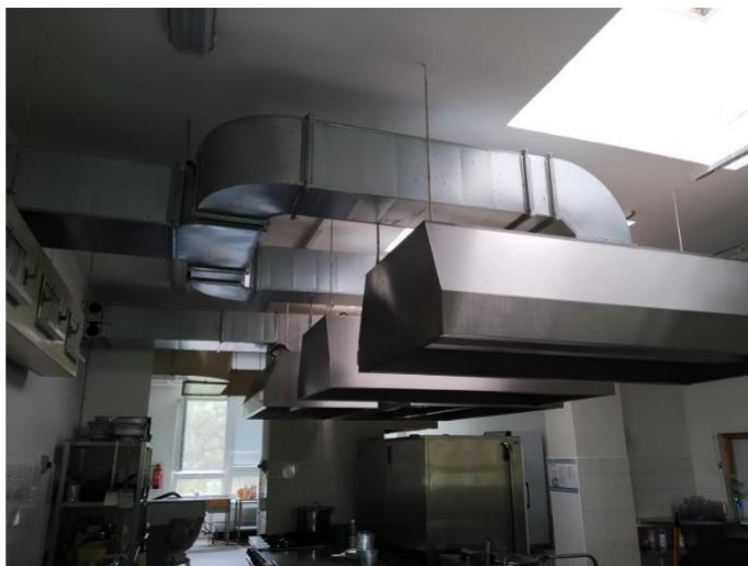
Obrázek 78: Vzduchotechnické zařízení – kuchyně
