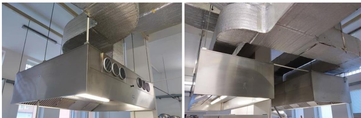
Obrázek 44: Odtahová digestoř ZŠ Na Nábřeží
