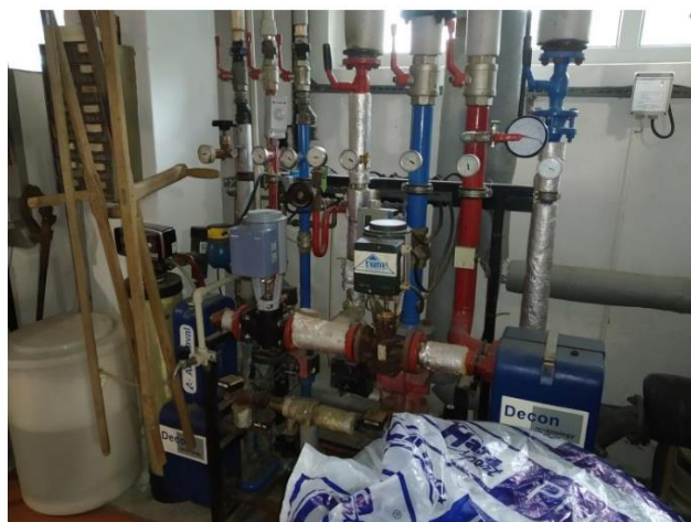
Obrázek 74: Výměňková stanice - bazén
