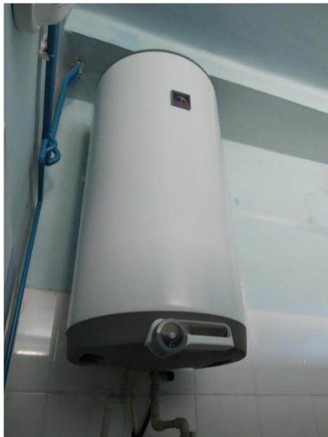
Obrázek 102: Elektrický boiler Dražice typ OKCE 125
