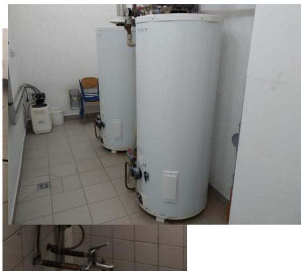
Obrázek 89: Elektrický boiler (vlevo) a plynové zásobníkové ohřívače – kuchyně (vpravo)
