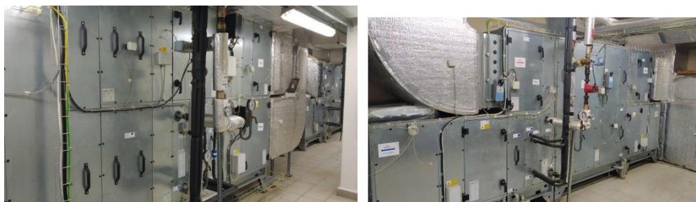
Obrázek 200: VZT zařízení KD Radost (vlevo – VZT zařízení sálu, vpravo – VZT vestibul)
