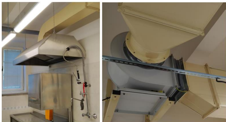
Obrázek 149: Odtahová digestoř a odsávací ventilátor VZT ZŠ Bludovice Frýdecká
