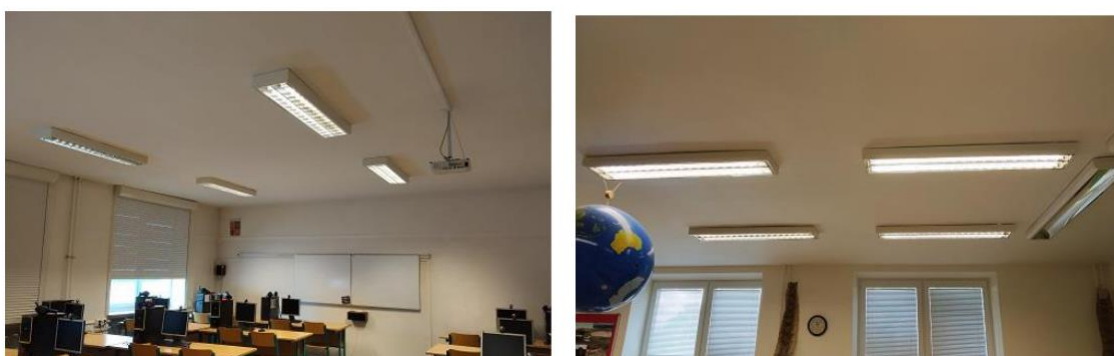
Obrázek 45: Osvětlení ZŠ Na Nábřeží (osvětlení učebny)
