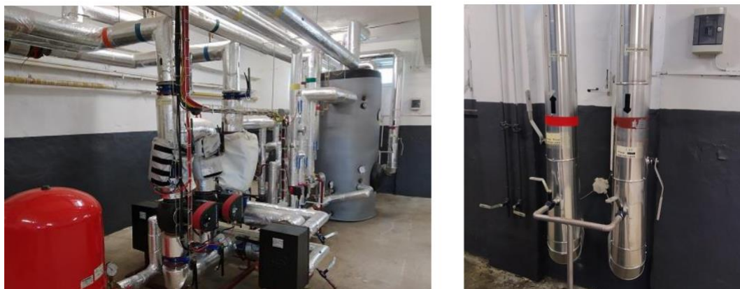
Obrázek 61: Výměňíková stanice ZŠ 1. Máje (vlevo výměňíky + zásobník TV, vpravo primární okruh horké vody)
