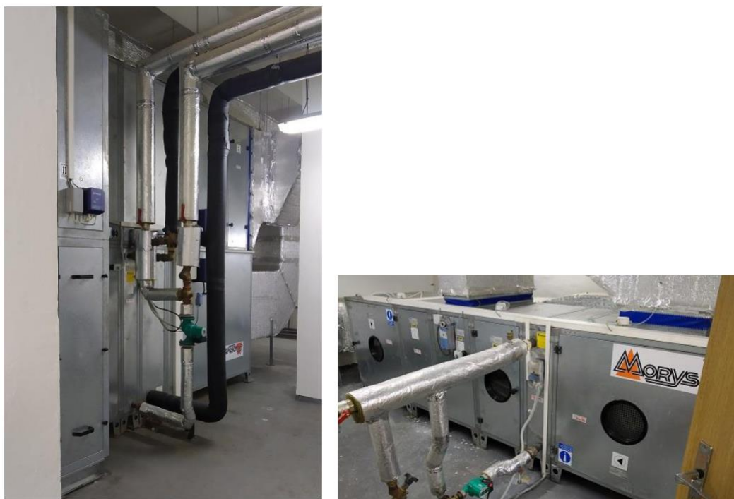
Obrázek 190: VZT zařízení KD Petra Bezruče (vlevo – VZT zařízení velkého sálu, vpravo – VZT šaten velkého sálu)
