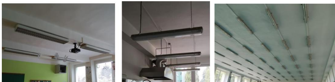
Obrázek 66: Osvětlení ZŠ 1. Máje (osvětlení učeben, osvětlení kuchyně, osvětlení tělocvičny)
