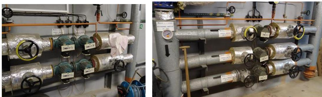
Obrázek 165: Domov seniorů LUNA – čerpací technika větve VZT (vlevo), čerpací technika přívodní větve ÚT (vpravo)
