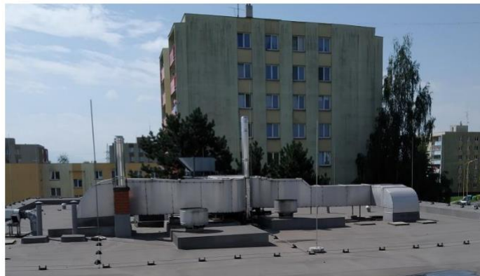
Obrázek 91: Vzduchotechnická jednotka pro větrání kuchyně
