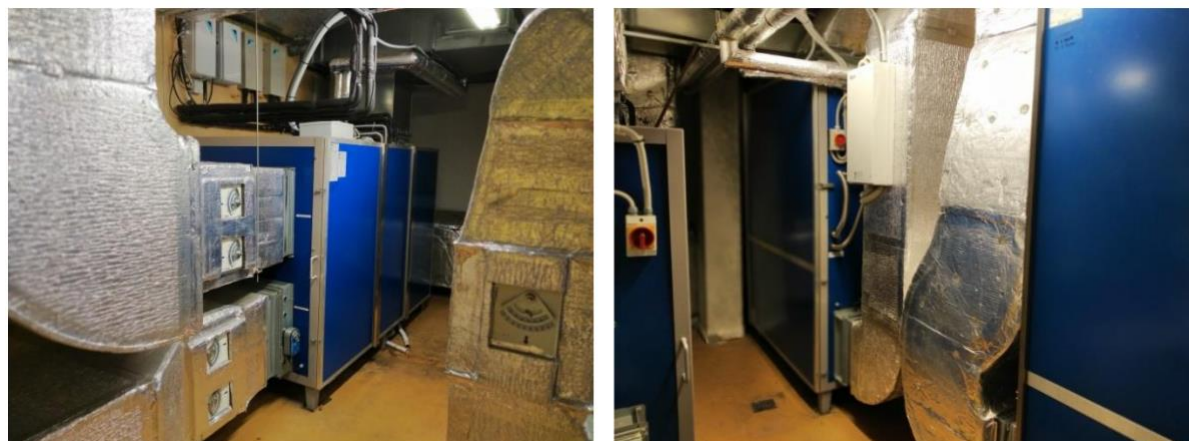
Obrázek 245: Vzduchotechnická zařízení - strojovna
