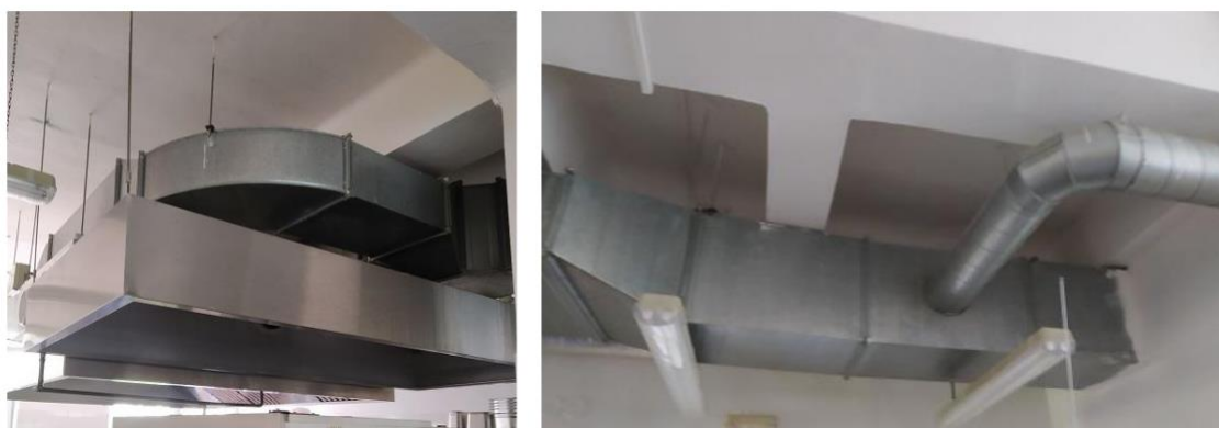
Obrázek 65: Odtahová digestoř myčky nádobí ZŠ 1. Máje
