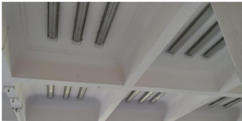
Obrázek 151: Osvětlení ZŠ Bludovice Frýdecká (osvětlení tělocvičny)
