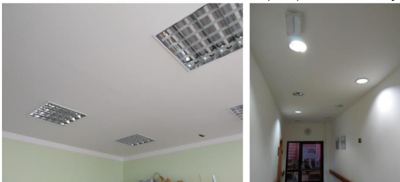
Obrázek 234: Osvětlovací zářivková tělesa kanceláře (vlevo) a osvětlení chodby (vpravo)
