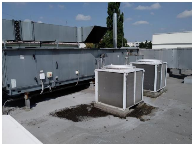
Obrázek 90: Klimatizační jednotky pro chlazení objektu jídelny
