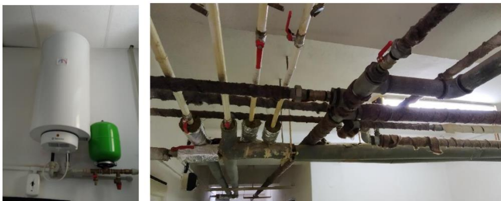
Obrázek 156: Elektrický ohřívač vody a rozvody topné vody ZŠ Bludovice Selská
