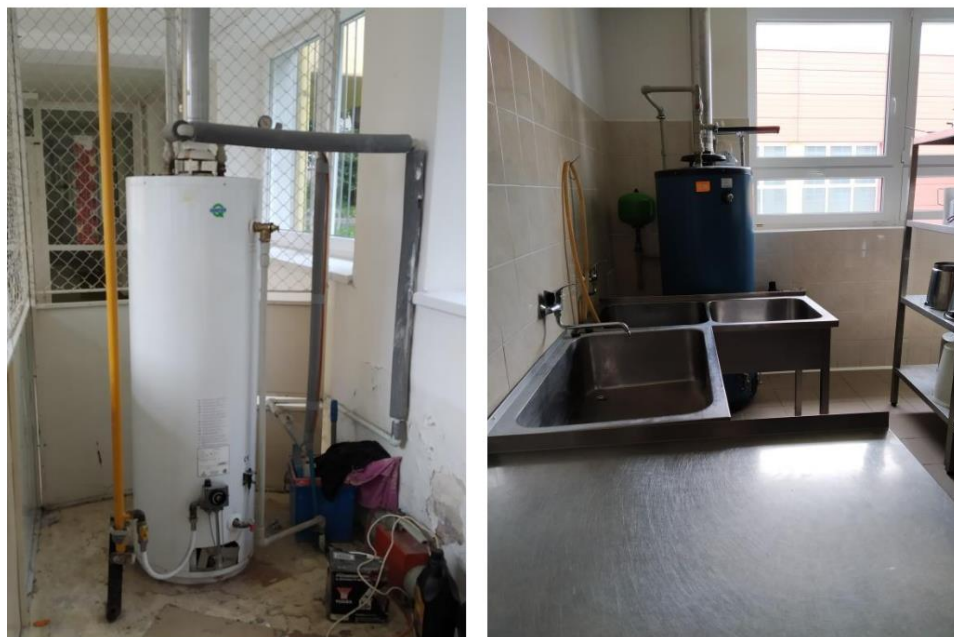
Obrázek 140: Plynový zásobníkový ohřívač – tělocvična (vlevo) a plynový zásobníkový ohřívač – kuchyně (vpravo)
