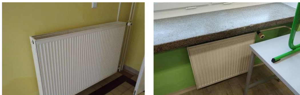
Obrázek 43: Otopné plochy ZŠ Na Nábřeží (vlevo chodba, vpravo deskové OT v suterénu)
