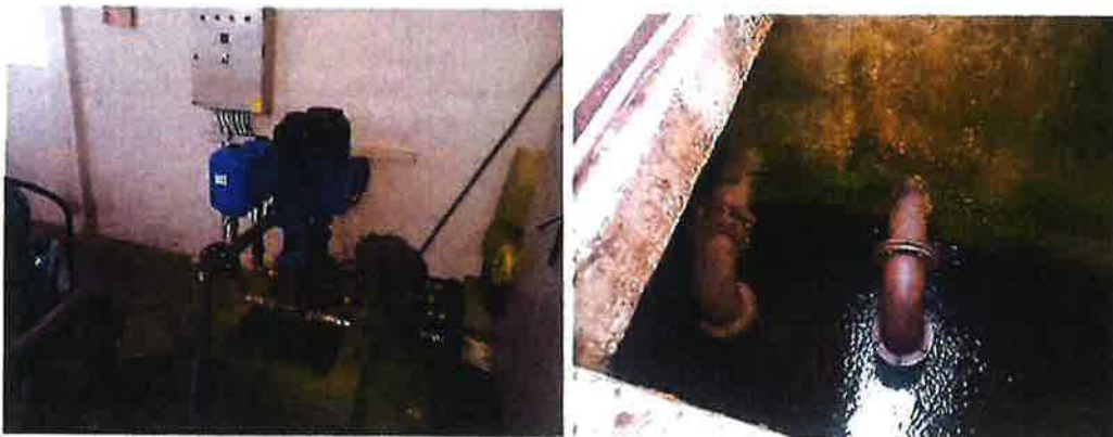
Obr. 9 Dílčí pohled na stávající původní technologické vybavení ve zdroji surové vody Bioštica
