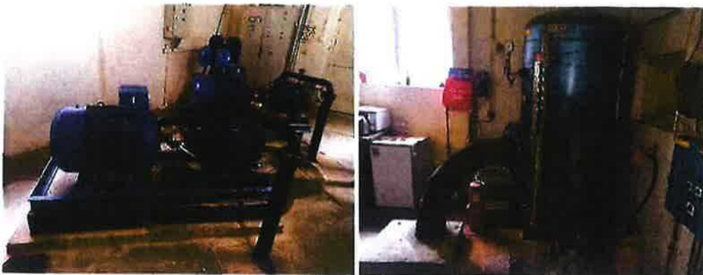
Obr. 8 Dílčí pohled na stávající původní technologické vybavení ve zdroji surové vody Bioštica
