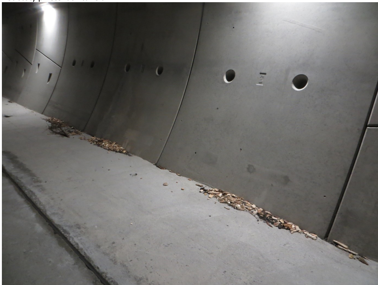
nečistoty při stěnách tunelu
