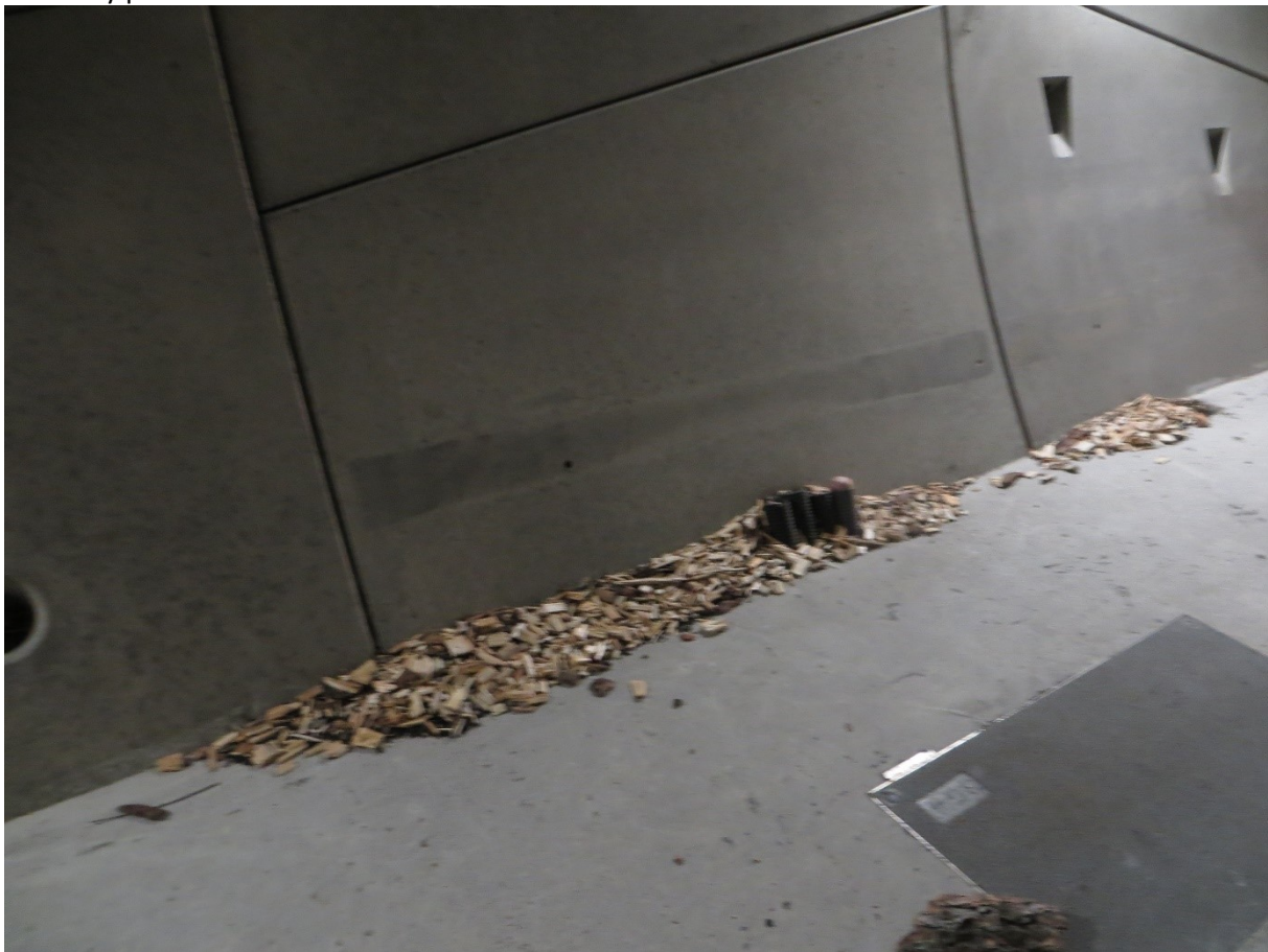
nečistoty při stěnách tunelu
