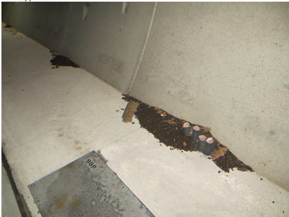
nečistoty při stěnách tunelu
