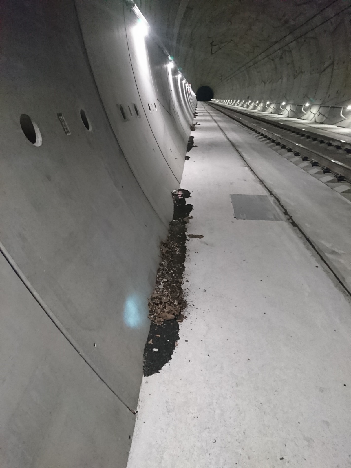
nečistoty při stěnách tunelu
