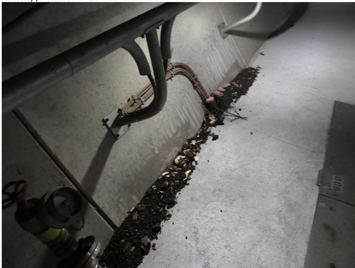
nečistoty při stěnách tunelu
