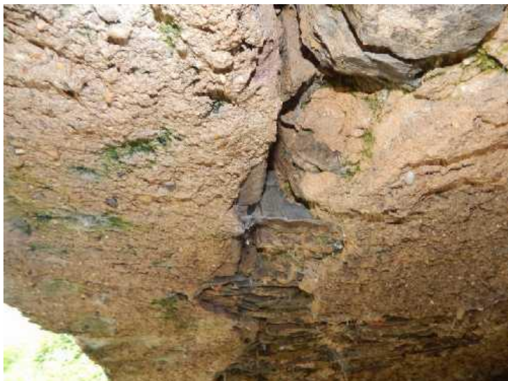
Otevřená trhлина na pravém boku nosné konstrukce.
