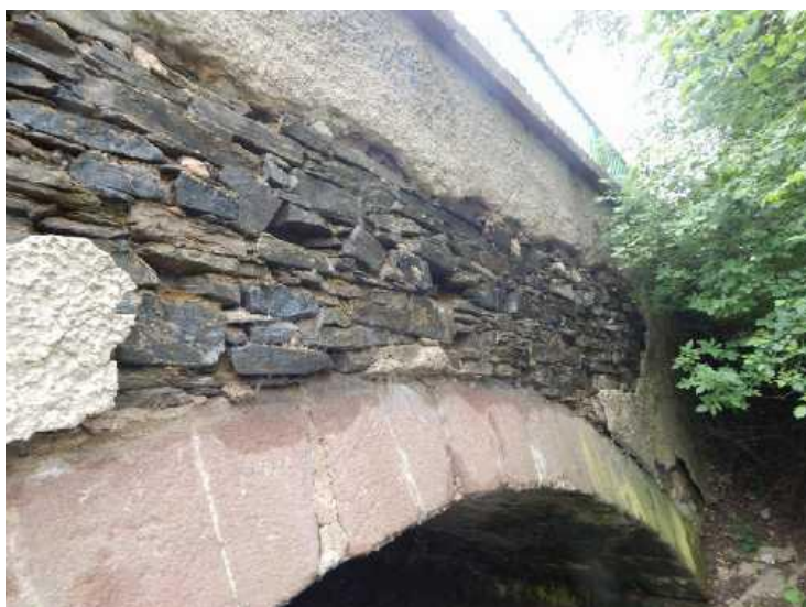
Plošně vypadlé spárování čelní zdi, jednotlivé kameny se uvolňují.
