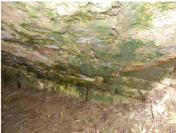
Silné zatékání na pravý bok nosné konstrukce.
