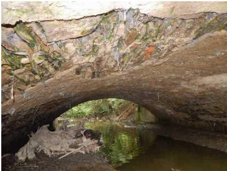
Poruchy v nosné konstrukci na pravé straně, silné zatékání, rozvolněné zdivo.
