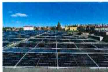
ROBE lighting s.r.o. Valašské Meziříčí 330 kWp
