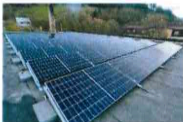
COOP Nový Hrozenkov Nový Hrozenkov 19,78 kWp
