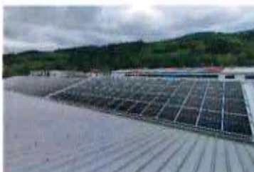
Feropol s.r.o. Bystřička 299,7 kWp
