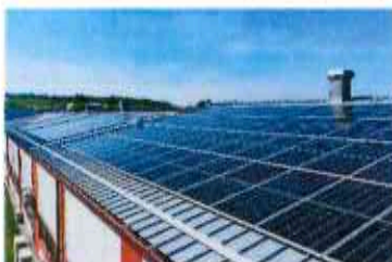
Strojírny Vehovský Otice 191,7 kWp
