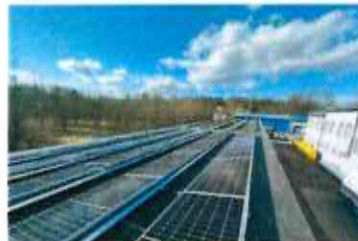
Ostravské vodárny a kanalizace a.s. Ostrava 33,75 kWp
