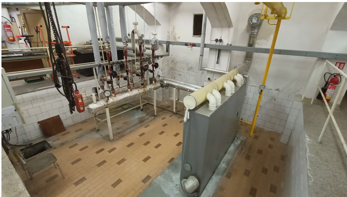
Obr. č. 1: Kaskáda kotlů Ferrol Econcept 101 a rozdělovač se sběračem umístěné na snížené úrovni podlahy
