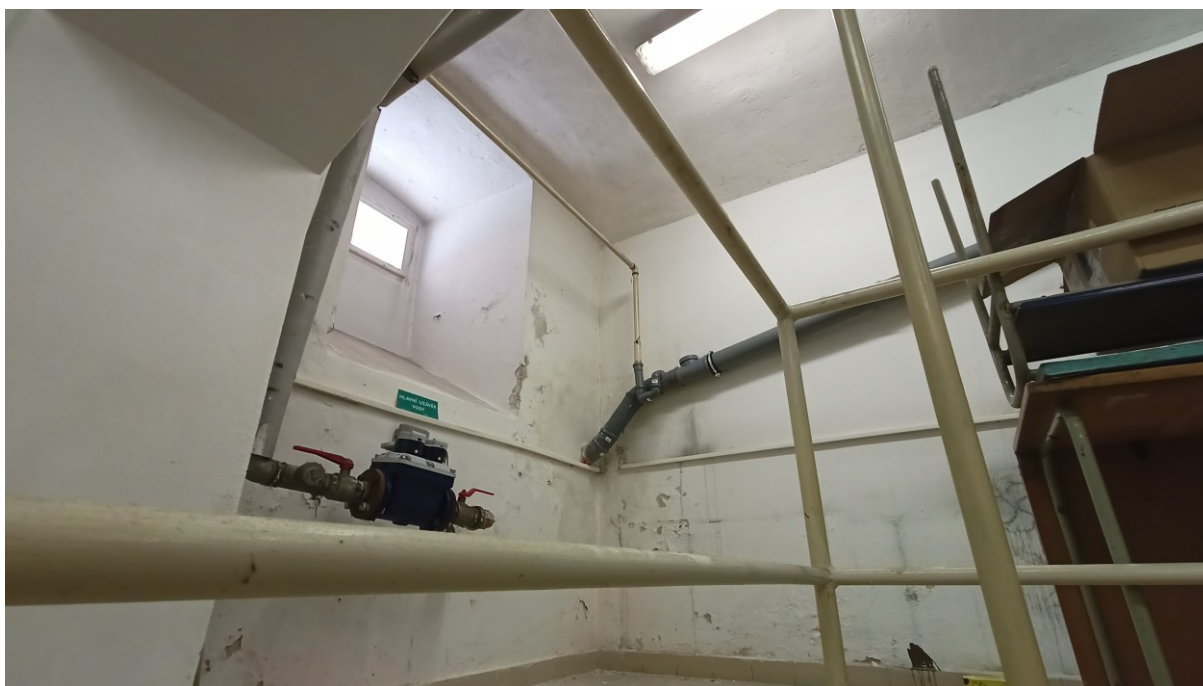
Obr. č. 4: Hlavní přívod vody do objektu a výtlak čerpadla napojený na vnitřní kanalizaci
