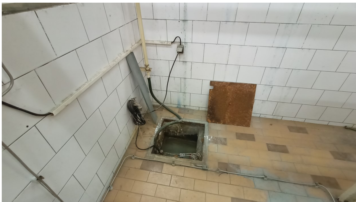
Obr. č. 3: Podlahová jímka s kalovým čerpadlem
