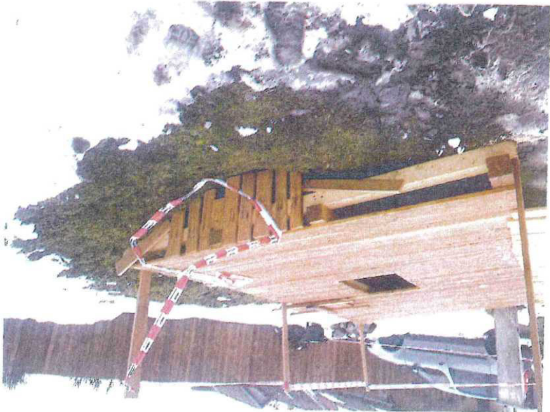
Obr. 3 – Rozšířený propad z povrchu v ploše
