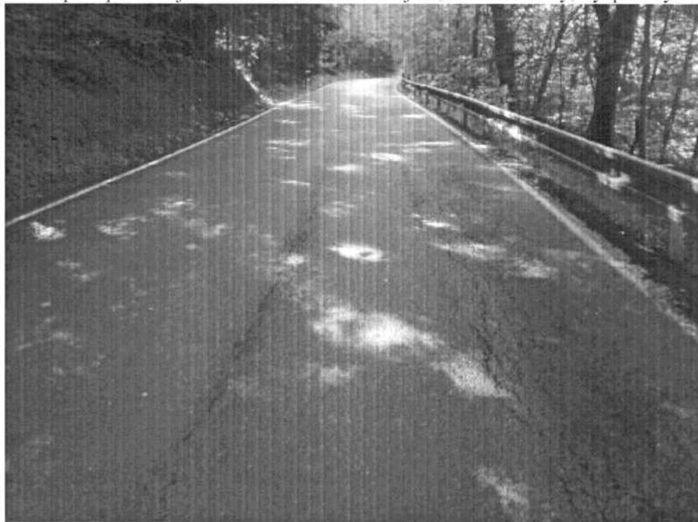
Etapa 2 za Dojetřicemi – deformace krajnic, podélné trhliny,
