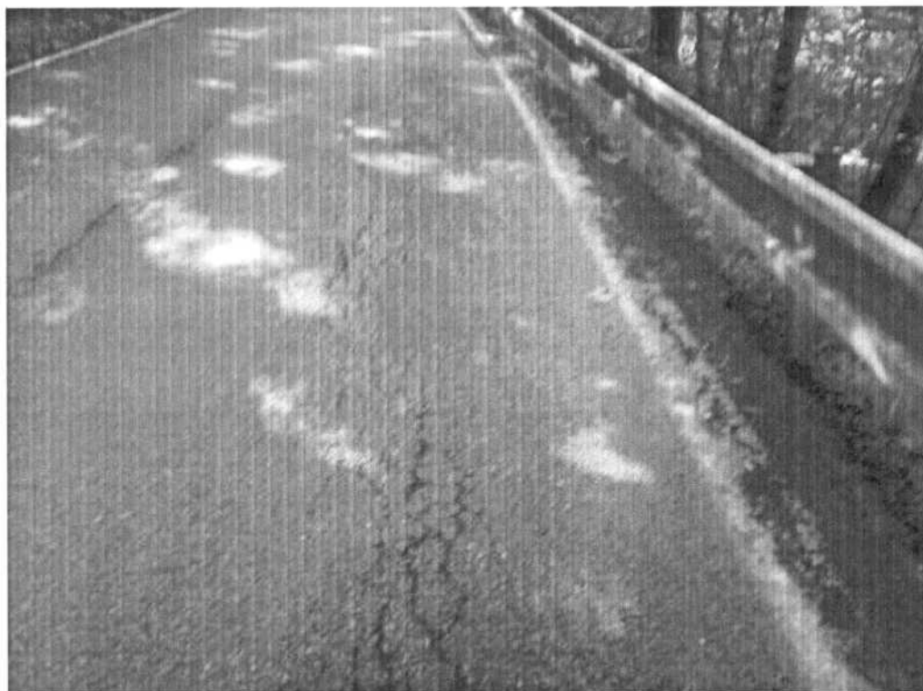
Etapa 2 za Dojetřicemi – deformace krajnic, podélné trhliny,
