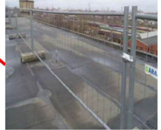
Průhledné oplocení výšky 2 m do betonových patek položených na geotextilií k zábraně vstupu dělníků mimo vyhrazený koridor pohybu
