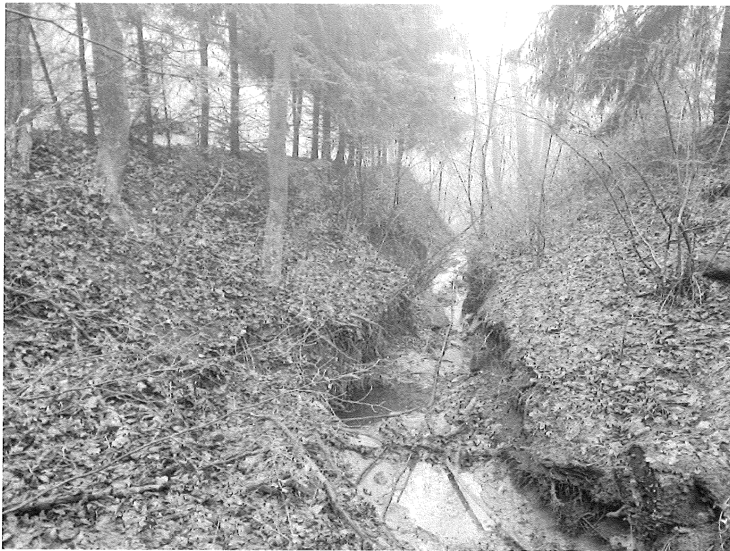
Obr. č. 1: Hluboce zařízlé koryto v předmětném úseku, dnová eroze, eroze levého svahu
