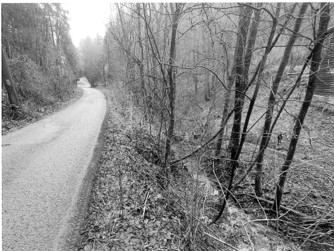
Obr. č. 3: Eroze levého svahu koryta VT, na levém břehu komunikace v souběhu s VT
