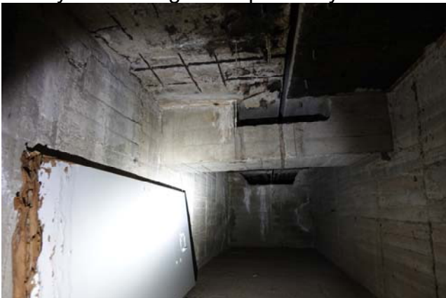
Foto 1 – Poškození desky u dilatace
