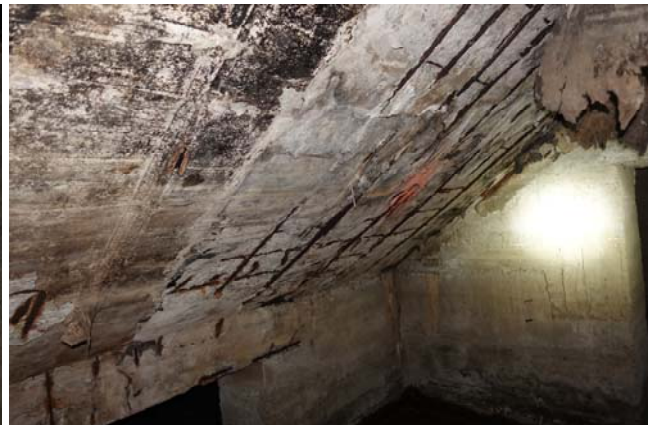
Foto 2 – Poškození desky v šikmé části dna
