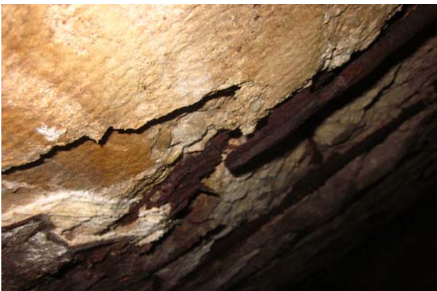
Foto 3 – Přerušení výztuže vlivem koroze
