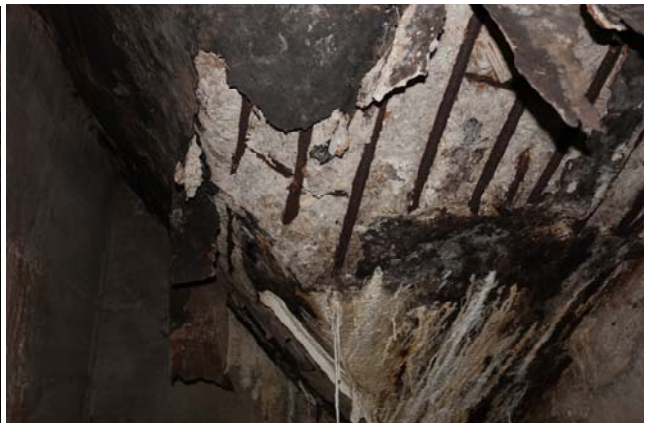
Foto 4 – Poškození desky v šikmé části dna
