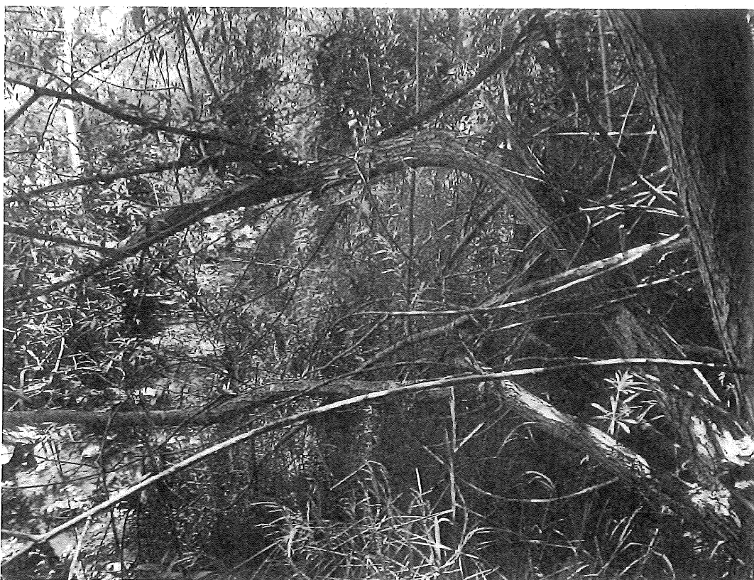
Foto č.9: Pohled z koryta proti proudu na dřeviny v průtočném profilu k odstranění
