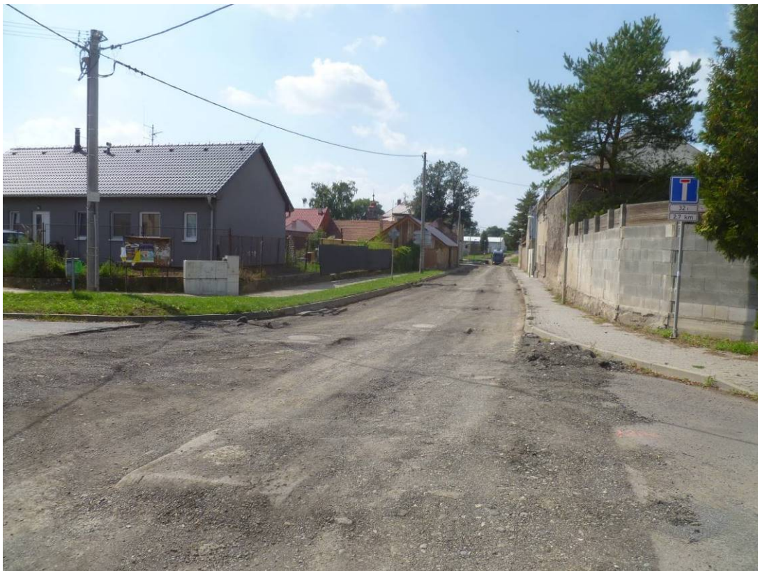
Vozovka v intravilánu obce po odfrézování
