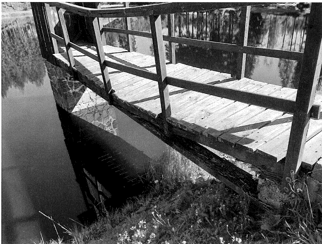
Poškozená lávka před odstraněním
