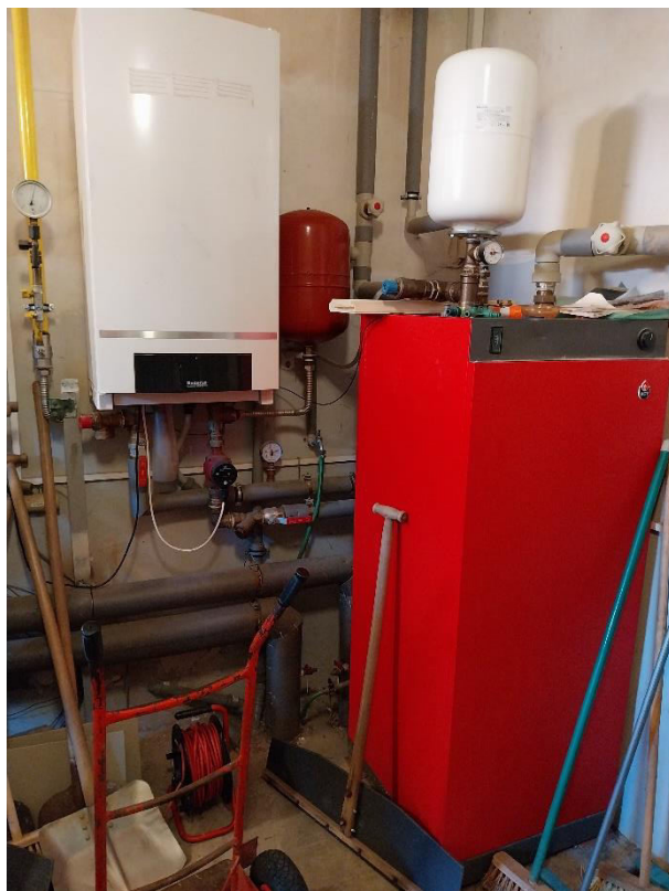
Obr. 9: Kotel a zásobník
