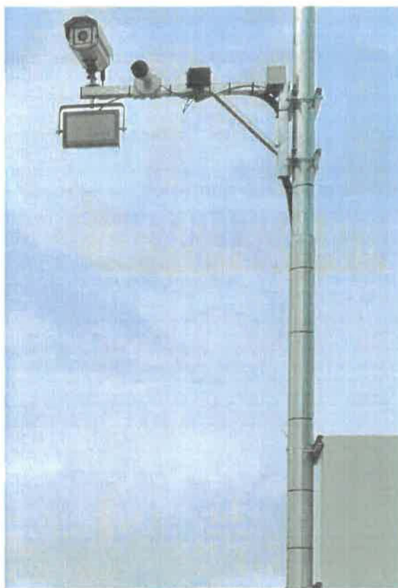
Obrázek 10 Příklad instalace rychloměru na sloupu
