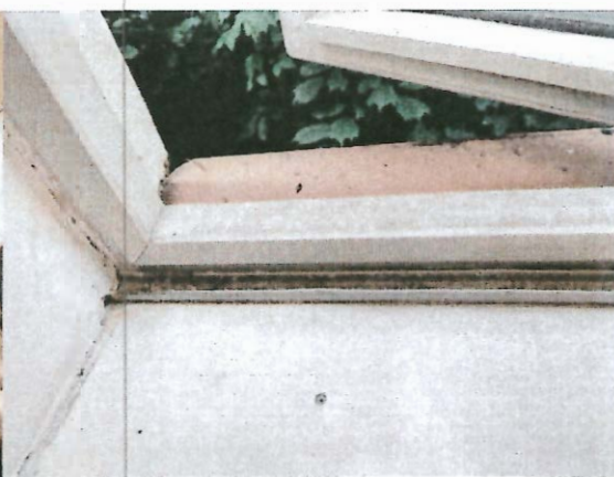
žlábek na zachyt kondenzátu, koroze
