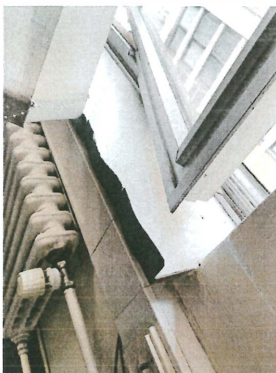
Amatérská „zábrana“ proti zatečení kondenzátu
