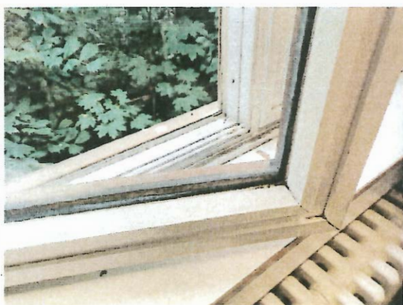
Plíseň v rohu zasklení
