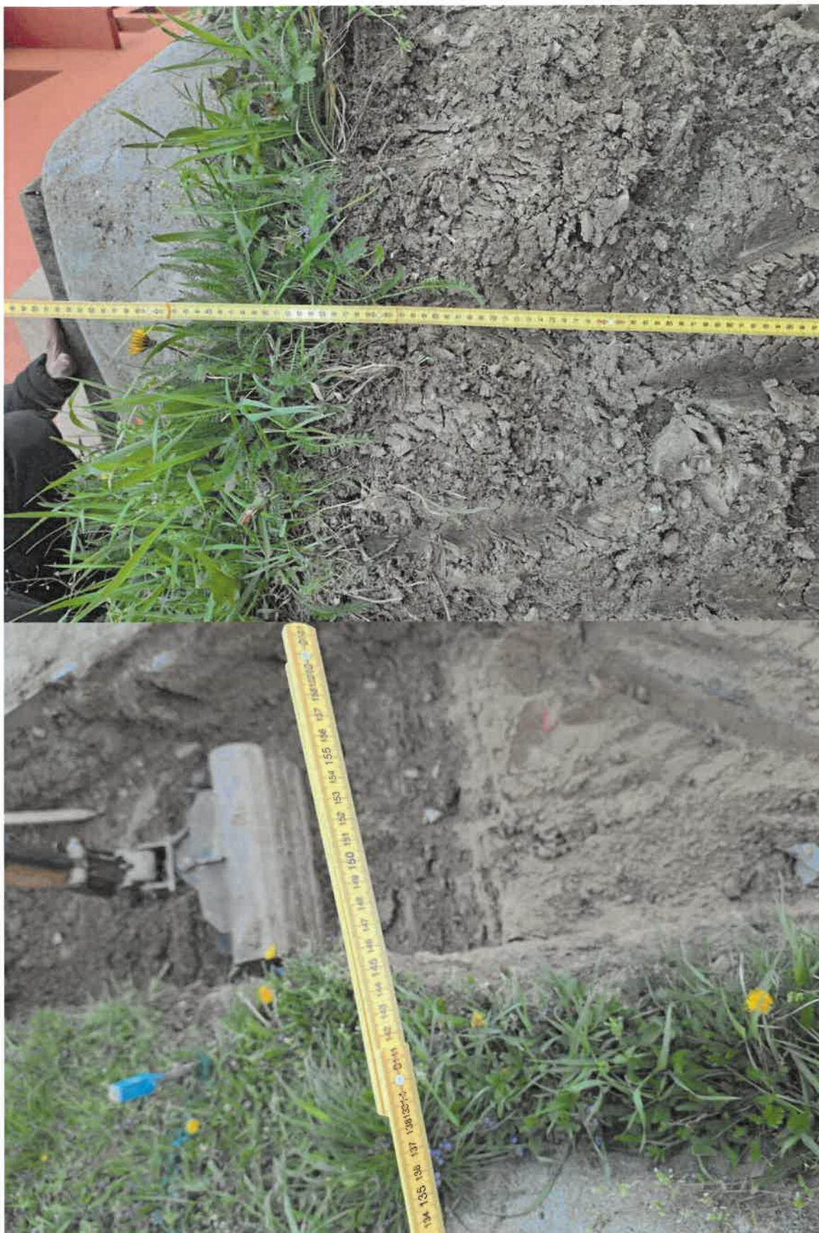
Foto hloubky výkopu a vzdálenosti hrany od domu č.911 – poskytl SVJ
