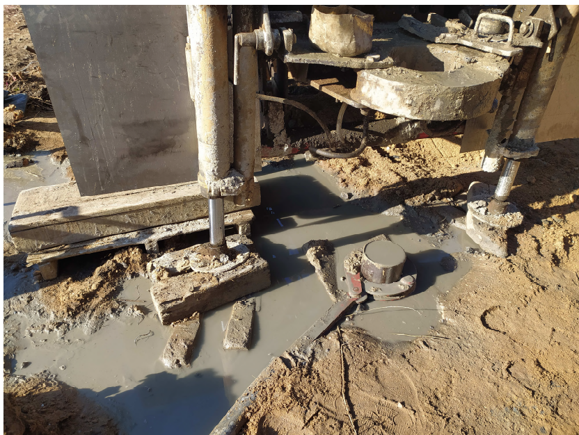
Obr.1 přetok podzemní vody přes ústí vrtu J1
