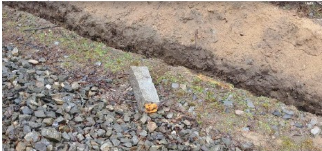
Obrázek 46 Vedení výkopu přes původní polohu geodetického bodu - bod musí být znovu osazen a zaměřen polohově i výškově
