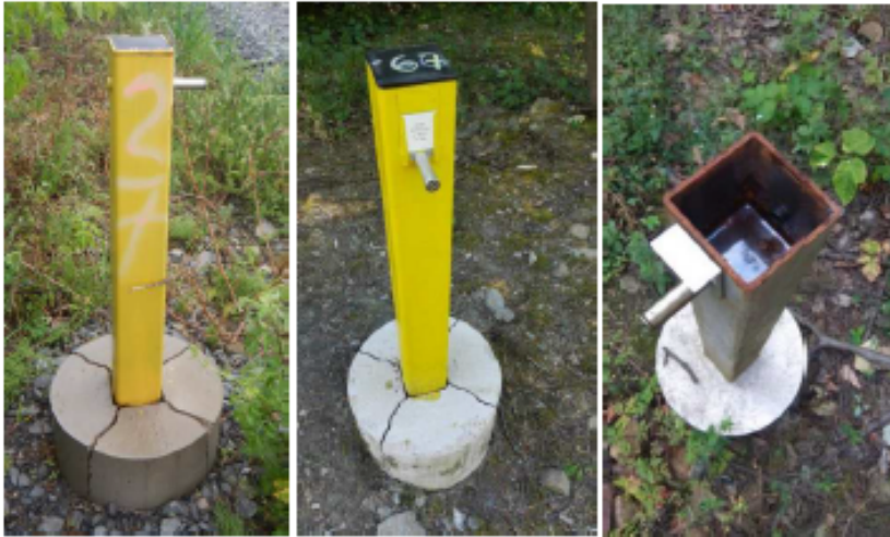
Obrázek 19 Popraskané betonové základy zajišťovacích značek ŽPSV
