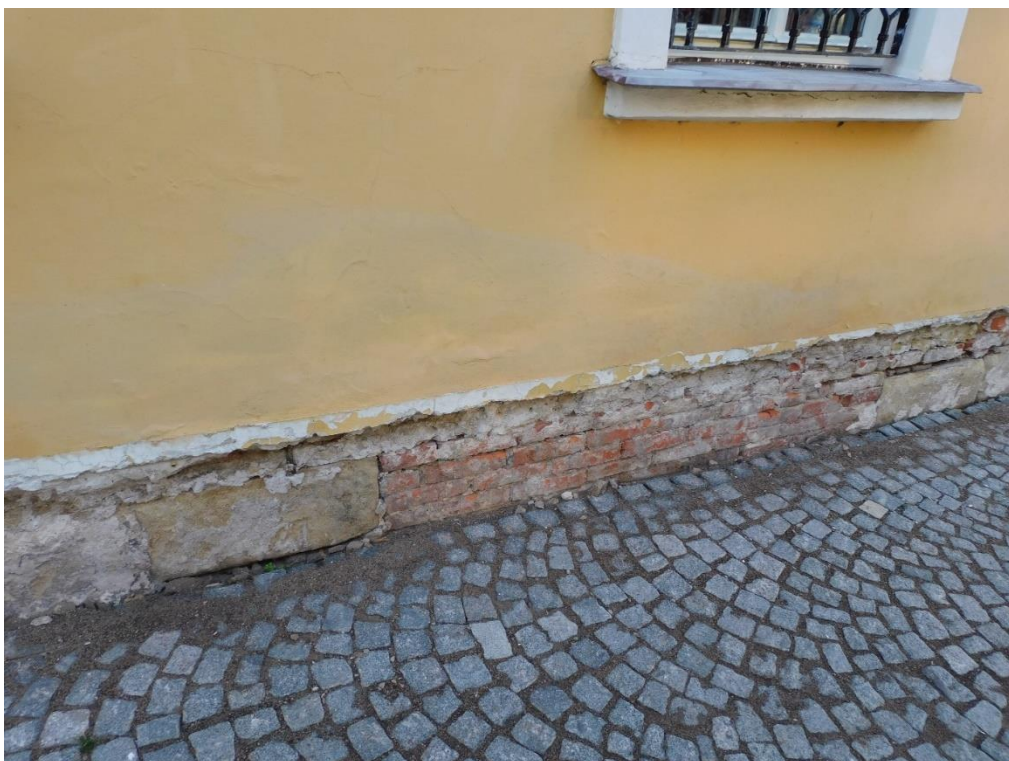
Pohled na chybějící část soklu
