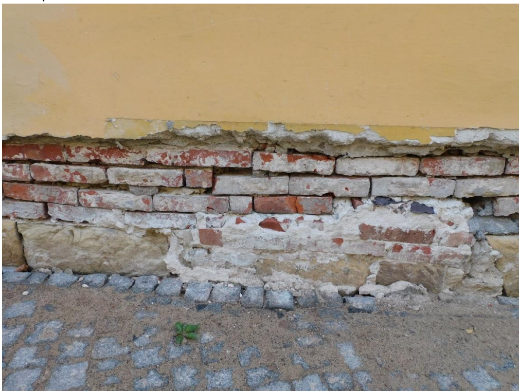
Chybějící části soklu, byly v minulosti doplněny cihlou
