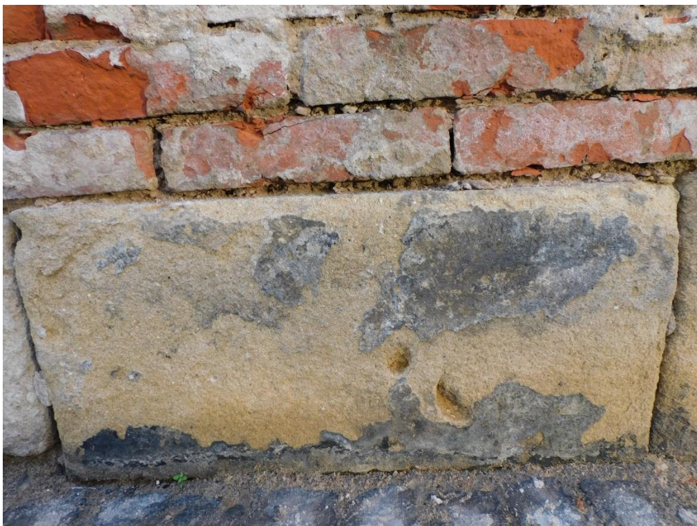
Detail tmavé, velmi tvrdé nátěrové vrstvy, pravděpodobně cementové
