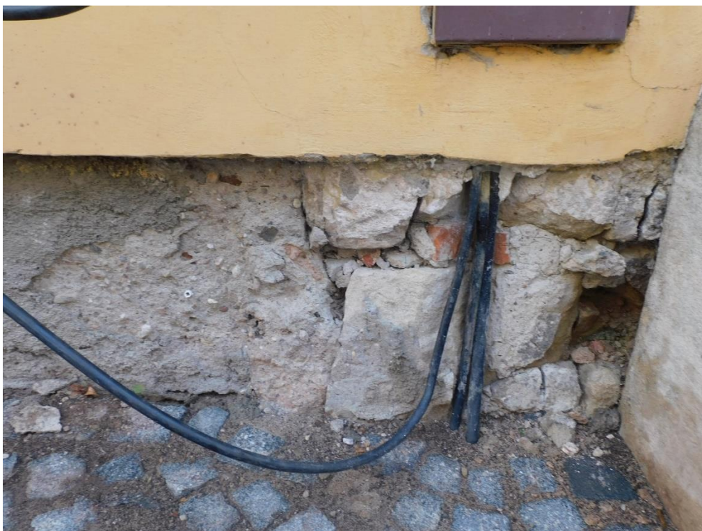
Detail poškození soklu u patníku elektroinstalací
