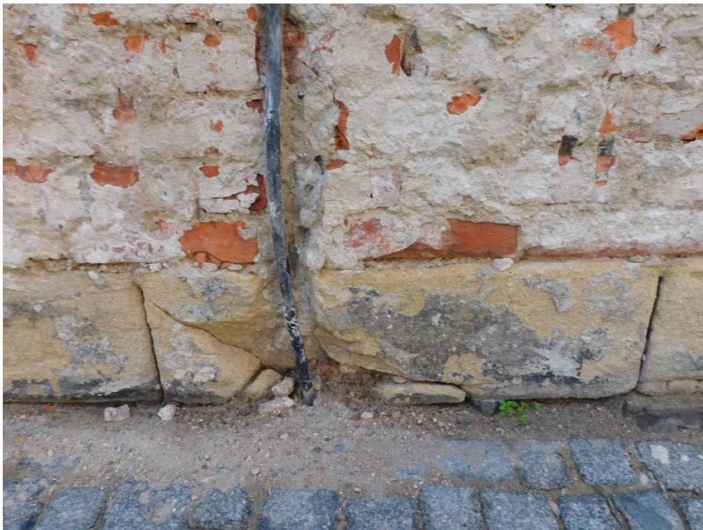
Detail poškození haklíků elektroinstalací
