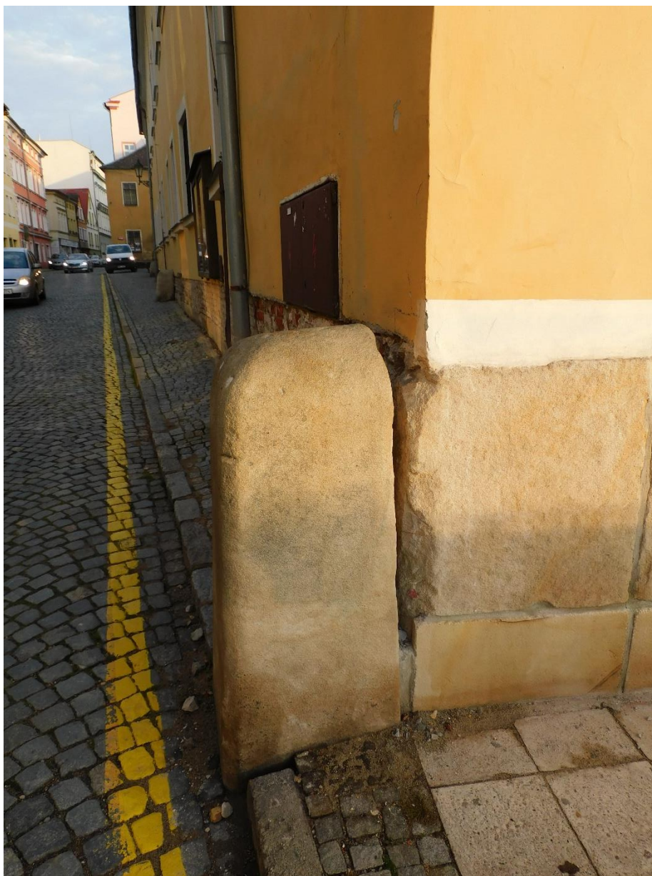
Detail rohové části soklu, poškození hrany kamene
