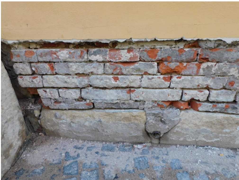
Detail poškození soklu
