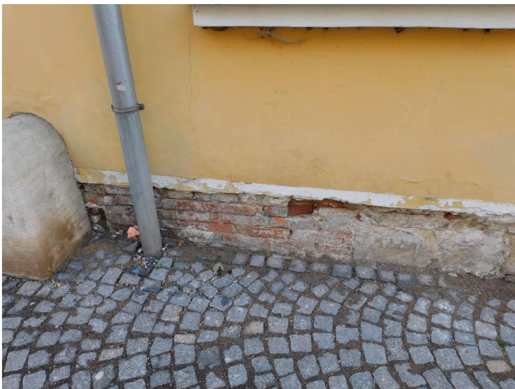
Pohled na chybějící část soklu
