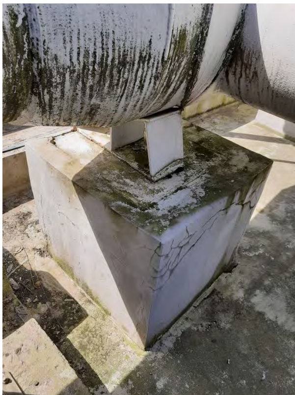
Fotografie č.4: Pohled na porušené zhlaví základové patky pod potrubím v záchytné vaně
