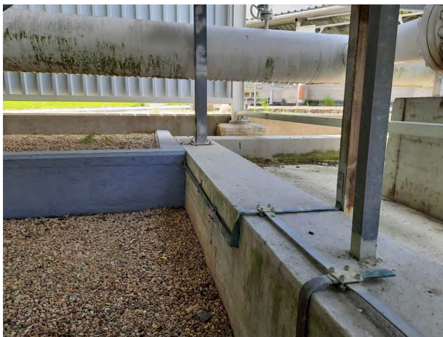
Fotografie č.7: Pohled na část záchytné vany pod zastřešující halou potrubního dvora. Na stěně záchytné vany probíhá vedení uzemnění a jsou ukotveny podpěrné sloupky kabelové trasy.
