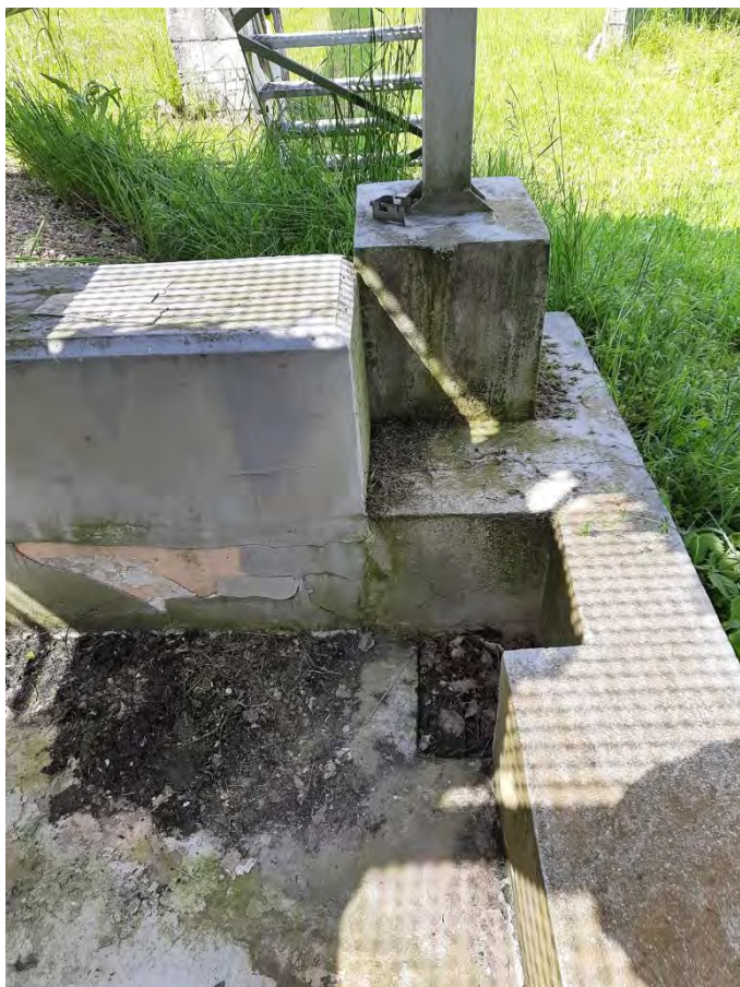
Fotografie č.6: Pohled na vtok do kanalizace v rohu na dně záchytné vany, zanesený nečistotami.
