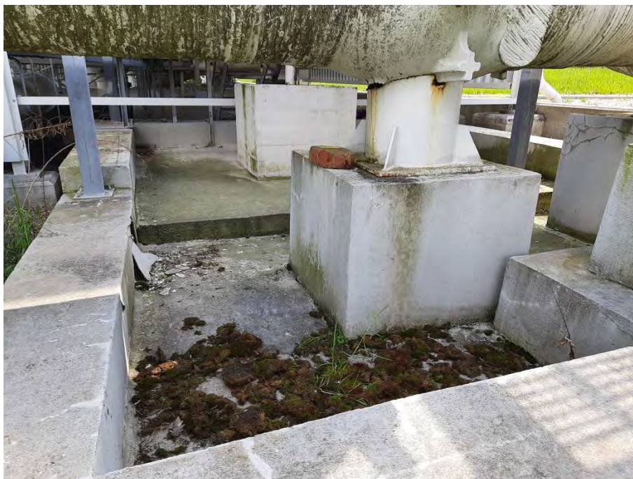
Fotografie č.3: Pohled na záchytnou vanu směrem na zastřešující halu potrubního dvora. Nánosy lišejníků a odpadlé zvětralé vrstvy stěrkového povrchu záchytné vany.
