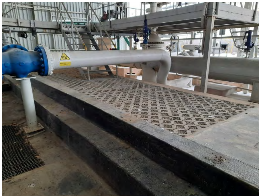
Fotografie č.3: Pohled na stěny záchytné vany u sběrné jímky č.1 a oddělovací pás mezi záchytnými vanami, pod kterým probíhá propojující potrubí mezi sběrnými jímkami č.1 a č.2.
