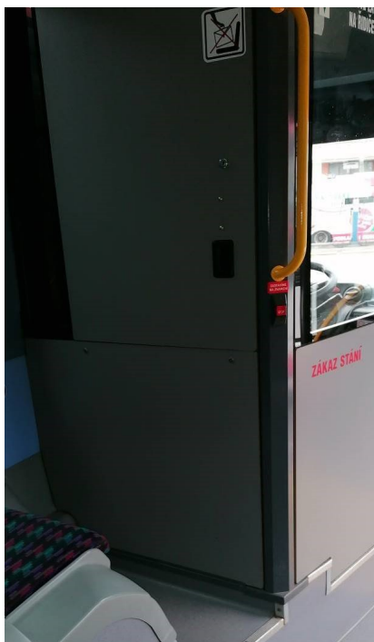
Crossway: rozvodná deska za kabinou řidiče
