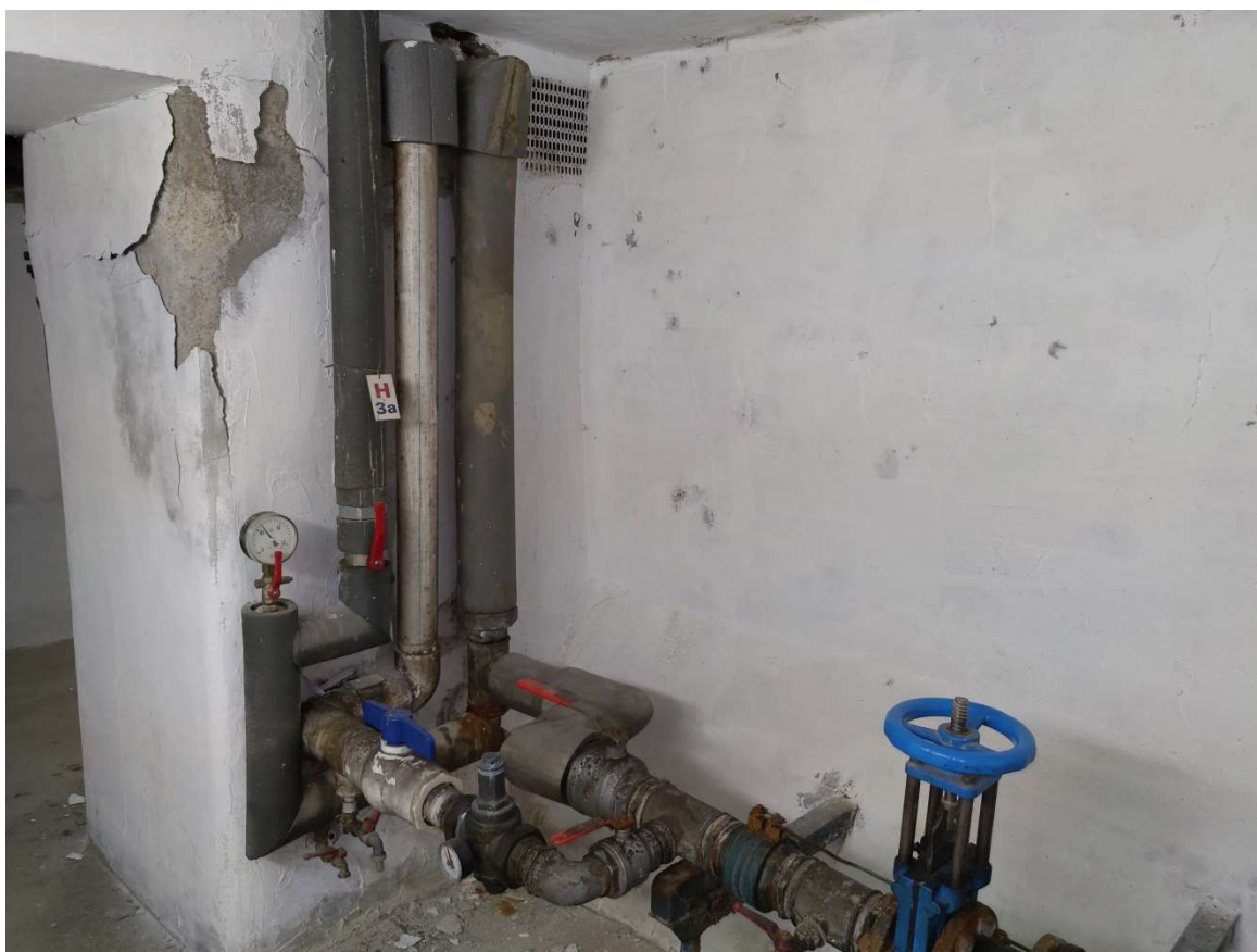
Místnost hlavního uzávěru vody
