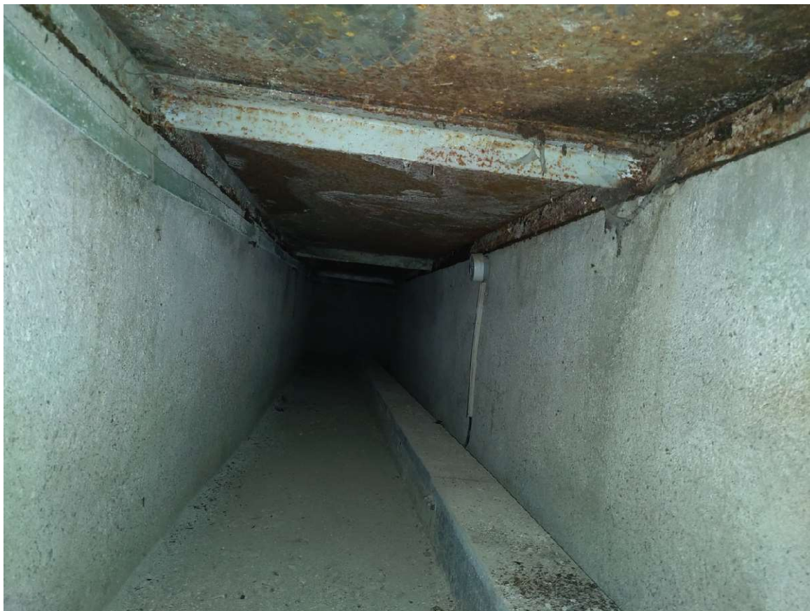
Kotelna (m.č. 065a) – kanál
