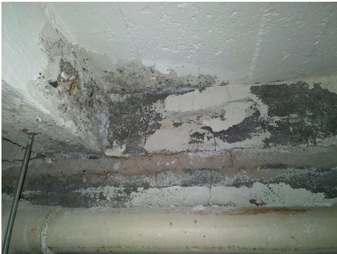
Kotelna (m.č. 065a) – zasolení ŽB konstrukce
