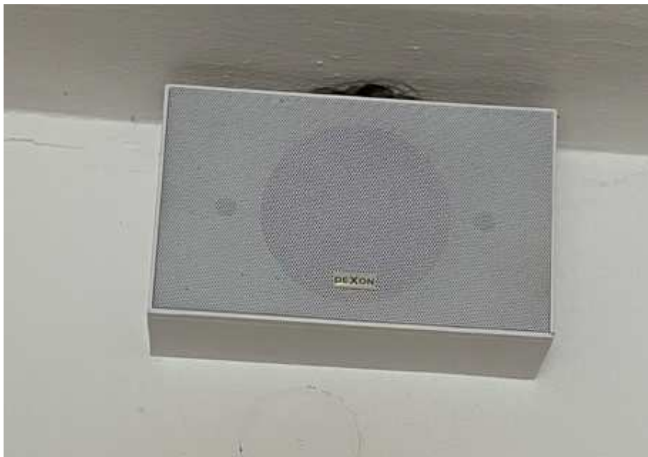
Obr. 72. Reproduktor instalovaný na chodbě.
