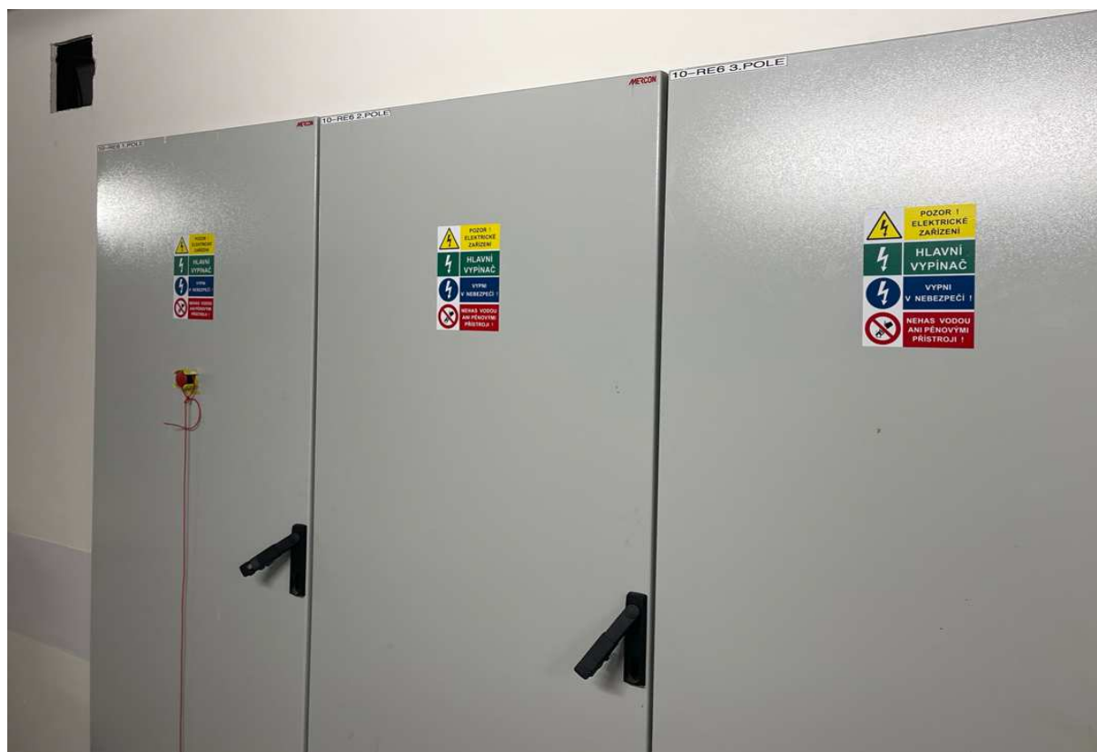
Obr. 40. Nový rozvaděč, kuchyně, odpovídající technický stav.
