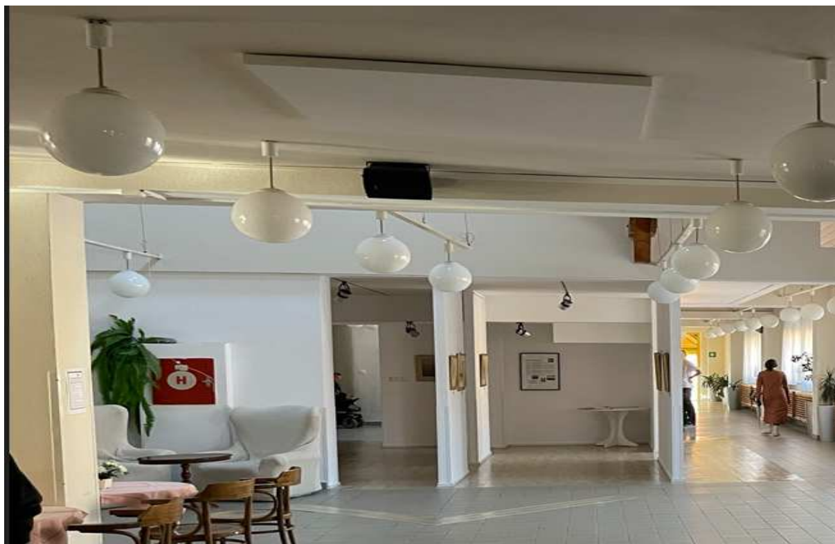
Obr. 54. Osvětlení chodby, svítidla s výměnnými LED zdroji.
