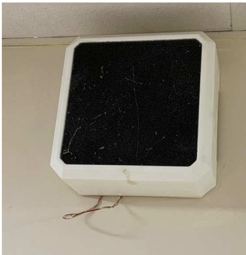
Obr. 74. Reproduktor instalovaný na chodbě.
