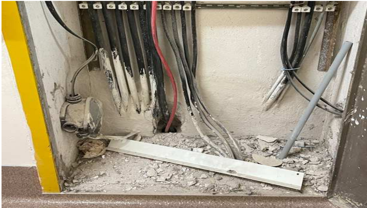
Obr. 33. Protipožárně nechráněný prostup mezi jednotlivými podlažími.
