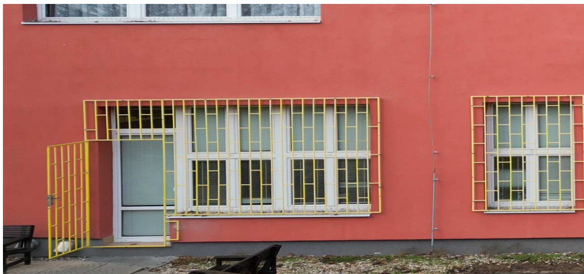
Obr. 5. Hromosvod obj. A vnější strana, provedení svodu na fasádě.
