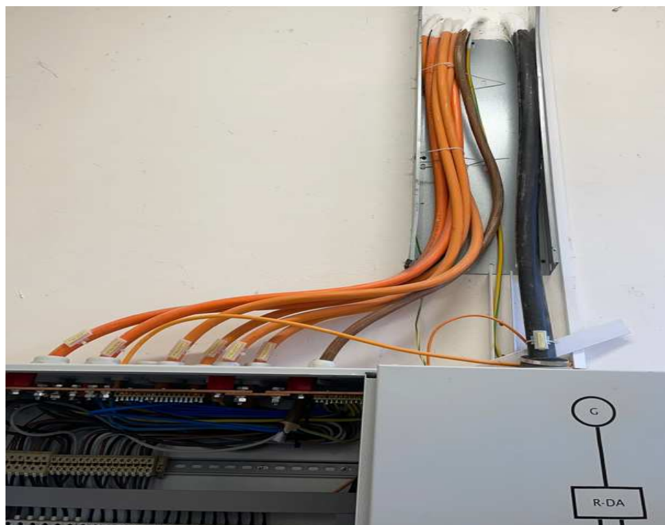
Obr. 61. Rozvaděč RMS-DA přívodní kabeláž.
