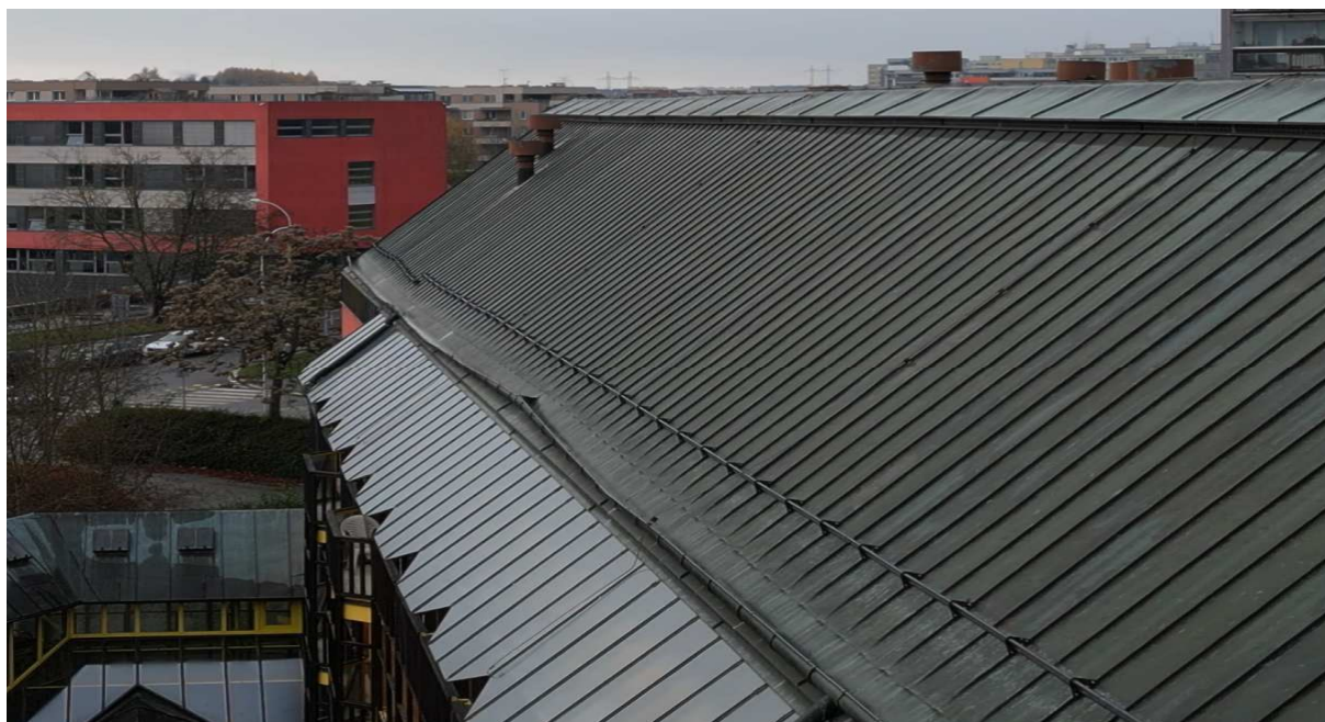
Obr. 11. Hromosvod obj. B vnitřní strana, zjištěna závada – s ohledem na předchozí uvedenou závadu chybí spodní vodorovné vedení hromosvodu pro připojení chybějících jímačů na výustcích VZT.
