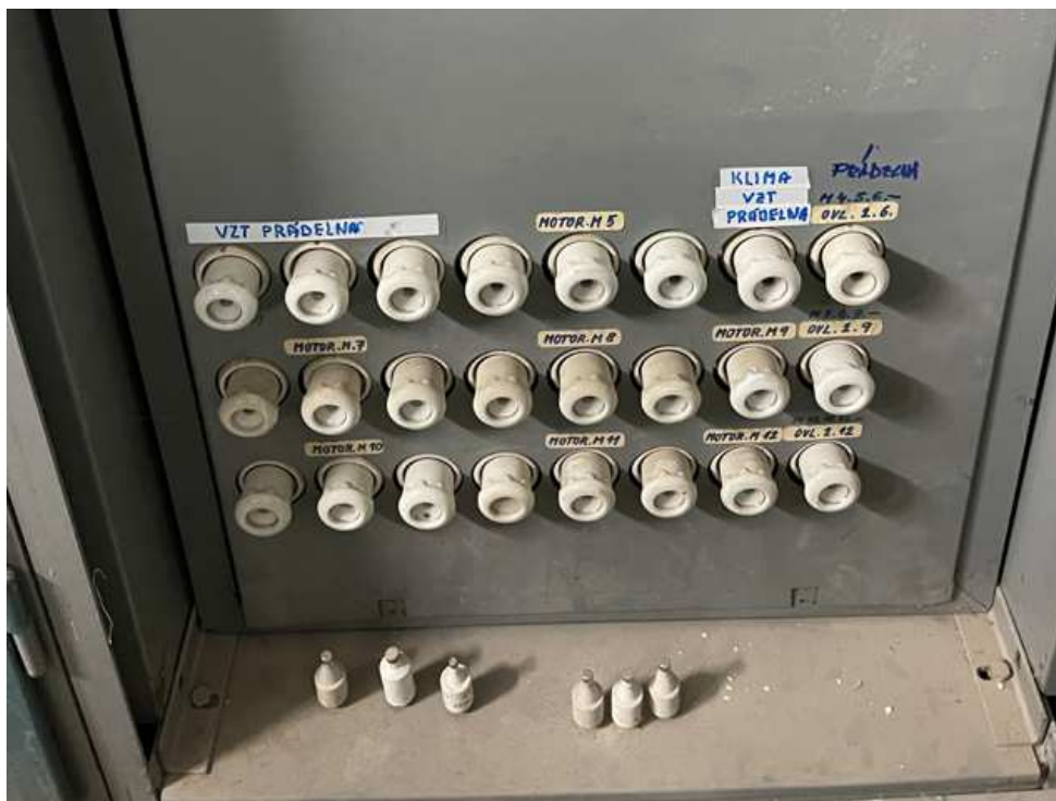
Obr. 47. Původní rozvaděč VZT, vnitřní část.
