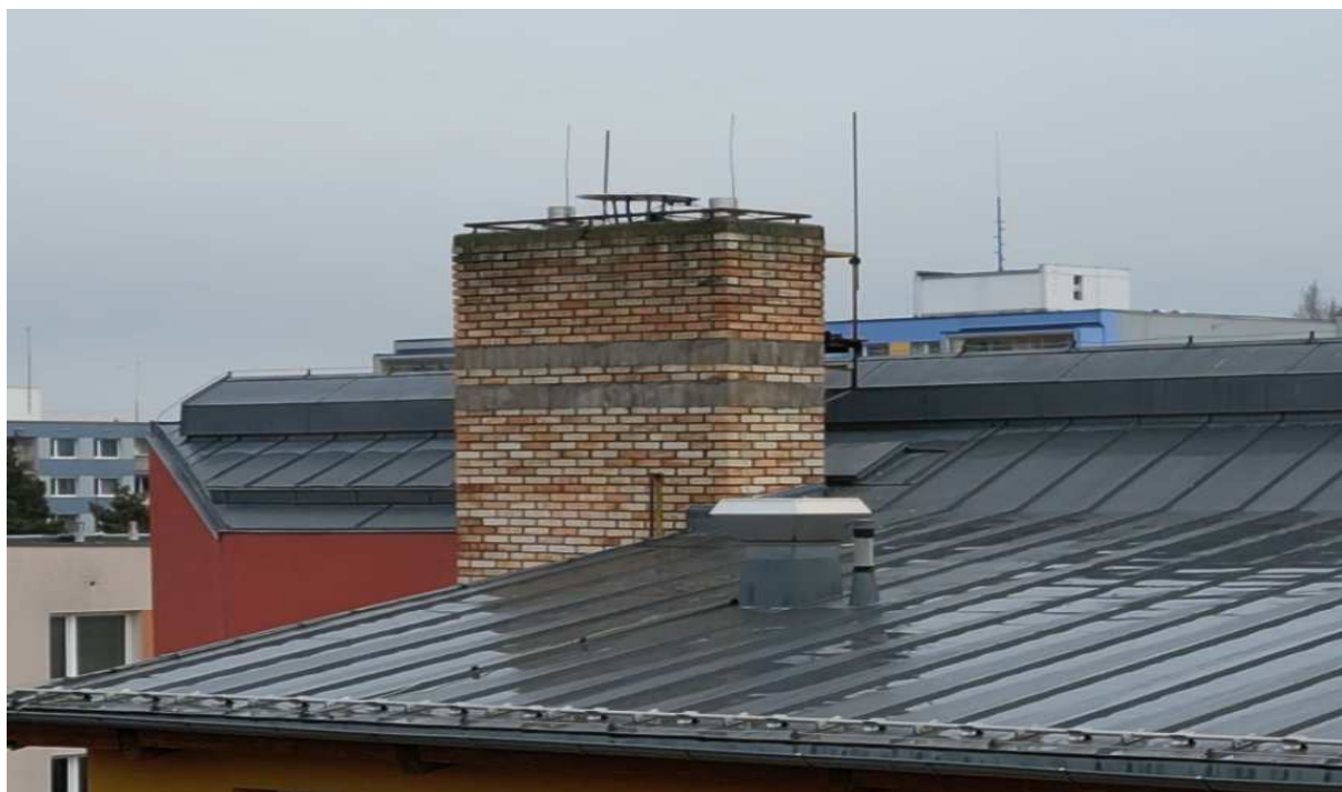
Obr. 1. Hromosvod obj. A vnitřní strana, jímače a vedení hromosvodu – spalínové cesty plynové kotelny.
