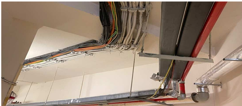
Obr. 21. Nesprávné uložení vodičů zemnicí soustavy objektu.
