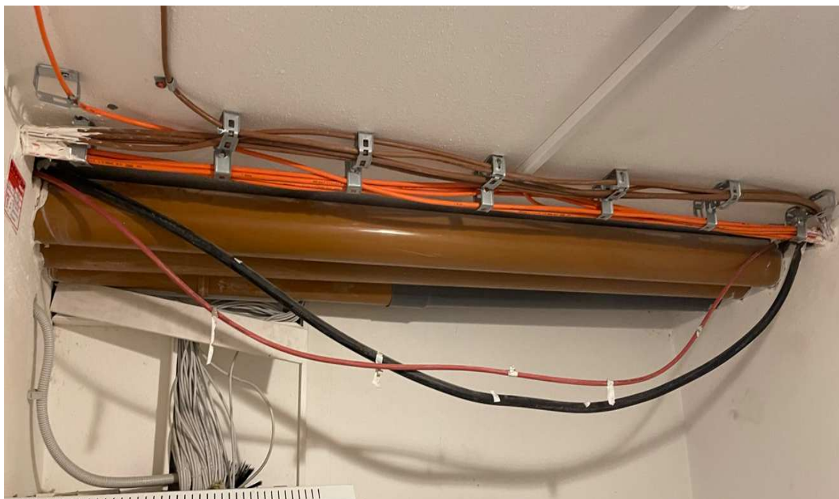
Obr. 31. Závady na uložení kabeláže v technické místnosti s rackem, neošetřený protipožární průstup.
