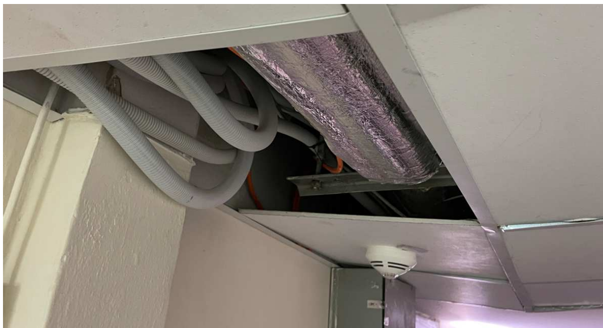
Obr. 30. Uložení kabeláže nad kazetovým stropem v chodbě, mechanicky přetížený kazetový strop na chodbě.
