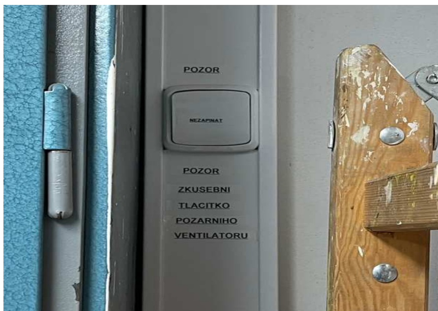
Obr. 64. Normám odporující instalace a provedení zkušební tlačítka požární ventilace.
