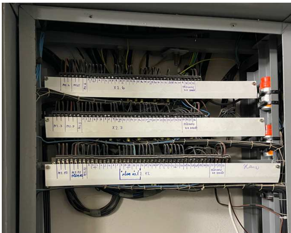
Obr. 46. Původní rozvaděč VZT, vnitřní část.
