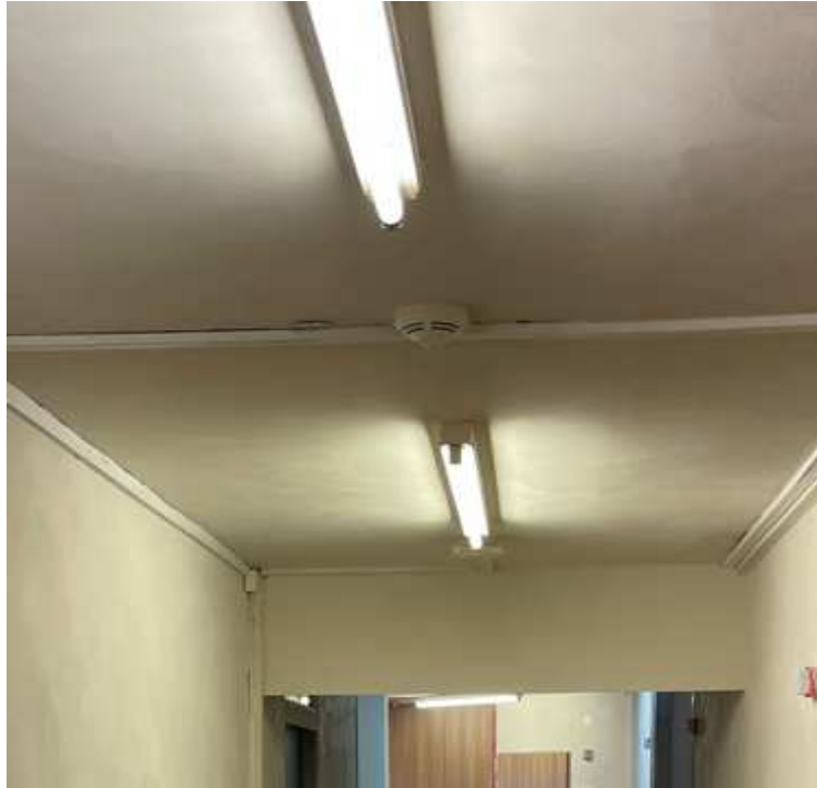
Obr. 49. Osvětlení chodby, svítidlo v případě účinku tepla od vzniklého požáru nezajistí svoji integritu, hrozí uvolnění zářivkové trubice a dalších částí svítidla.
