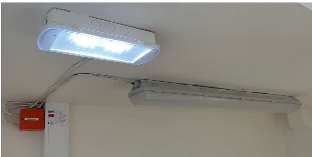
Obr. 50. Osvětlení únikové cesty, svítidlo v případě účinku tepla od vzniklého požáru nezajistí svoji integritu, hrozí uvolnění krytu a dalších částí svítidla.
