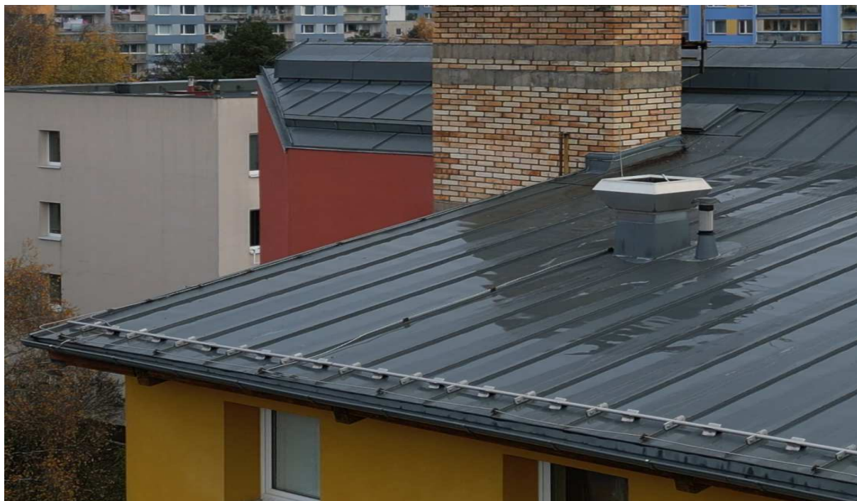
Obr. 2. Hromosvod obj. A vnitřní strana, správné provedení jímače a vedení hromosvodu – výustek zařízení VZT.
