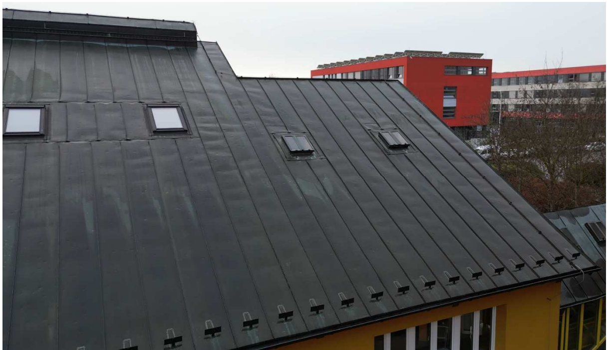
Obr. 16. Hromosvod obj. C vnitřní pravá část střechy.
