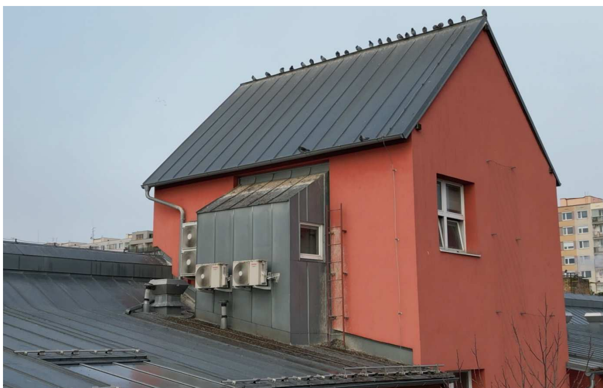
Obr. 7. Hromosvod obj. A vnější strana, provedení hromosvodu na střeše objektu, střední část.
