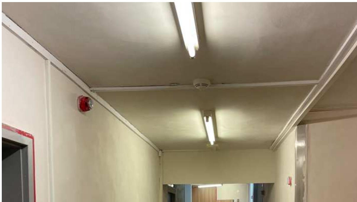
Obr. 34. Kabelová vedení v plastových lištách na únikových cestách.
