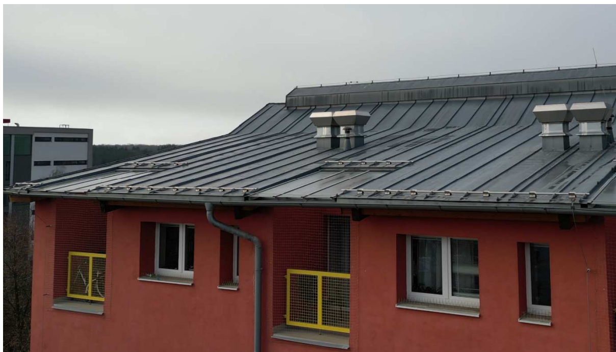
Obr. 6. Hromosvod obj. A vnější strana, provedení hromosvodu na střeše objektu, levá část.
