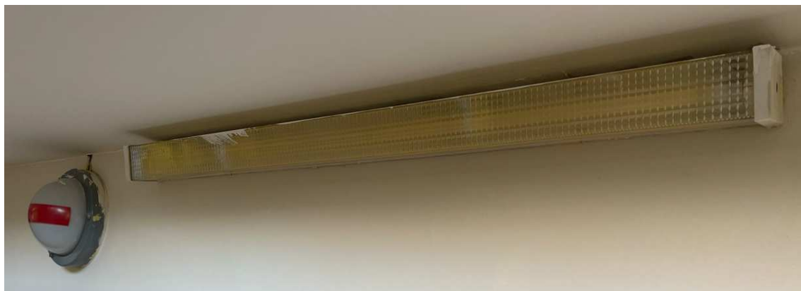
Obr. 52. Osvětlení chodby, špatný technický stav svítidla, svítidlo nesvítí.
