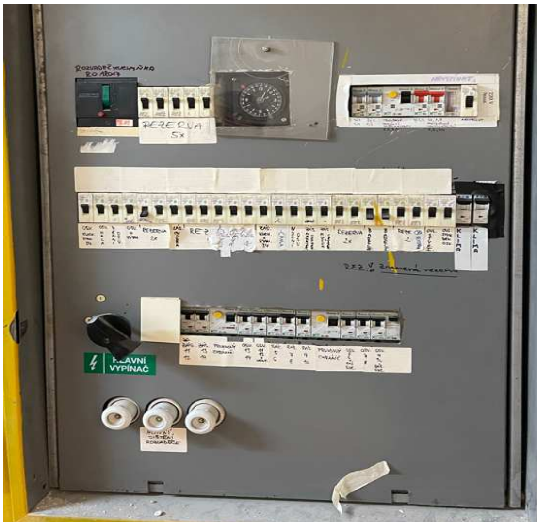
Obr. 35. Původní podružný rozvaděč, zjištěné závady – nevhodná instalace části výzbroje, nedostatečné krytí živých částí, původní výzbroj ve špatném technickém stavu.
