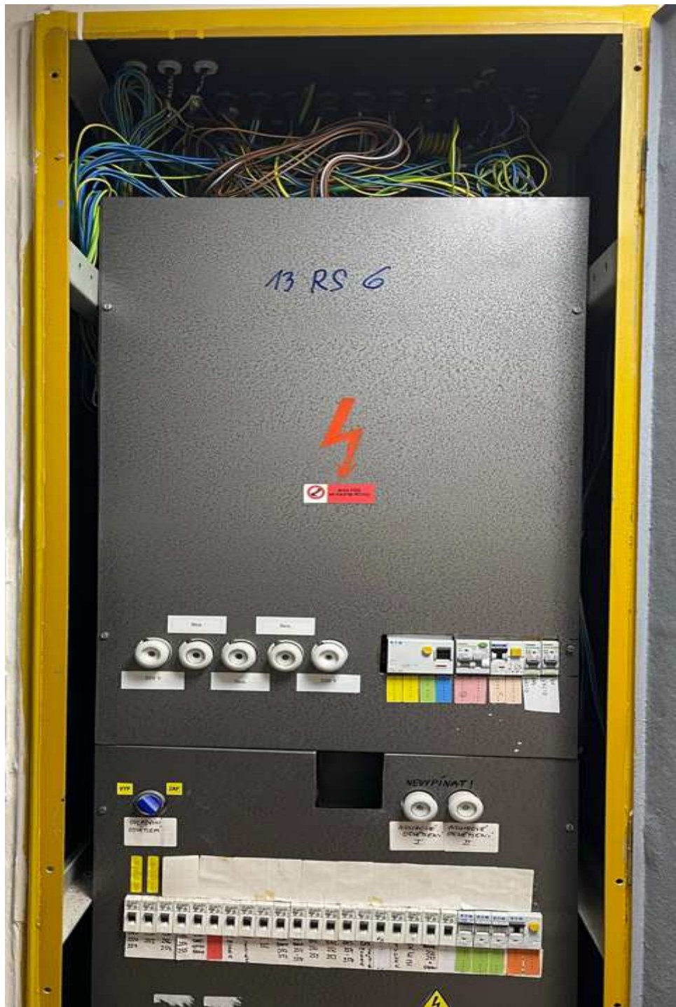
Obr. 36. Původní podružný rozvaděč, zjištěné závady – nevhodná instalace části výzbroje, nedostatečné krytí živých částí, původní výzbroj ve špatném technickém stavu, nevyvázané vodiče a neoznačená kabelová vedení.
