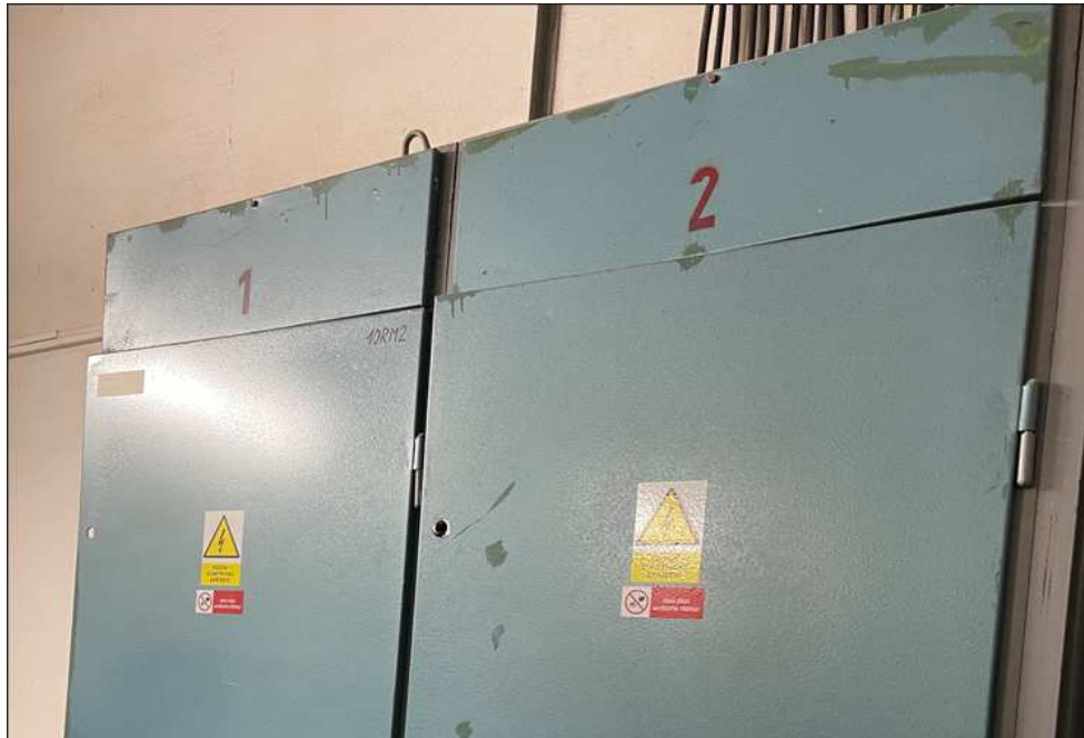
Obr. 45. Původní rozvaděč VZT.
