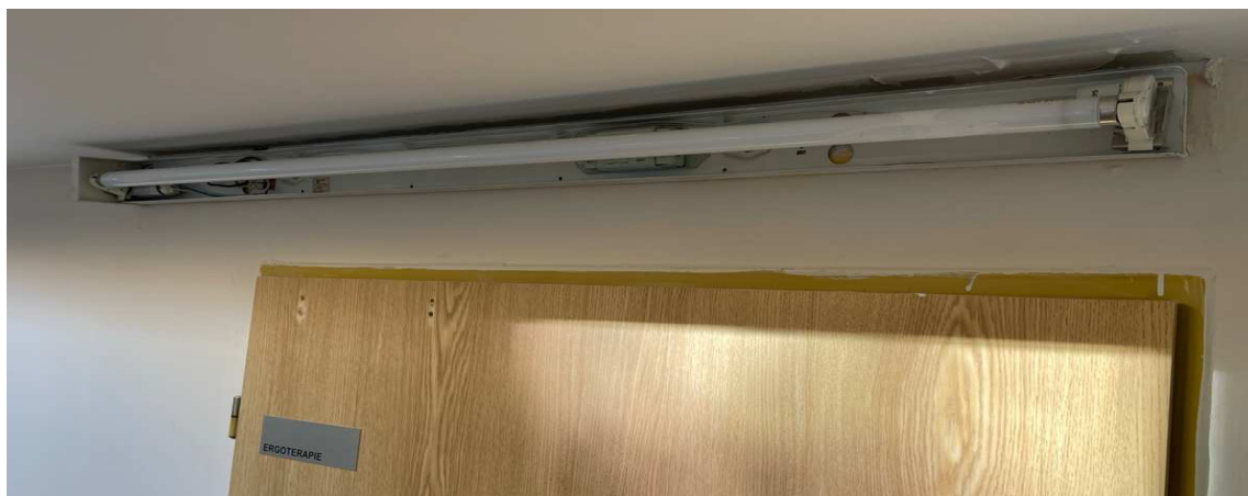
Obr. 51. Osvětlení chodby, špatný technický stav svítidla, chybějící kryt.
