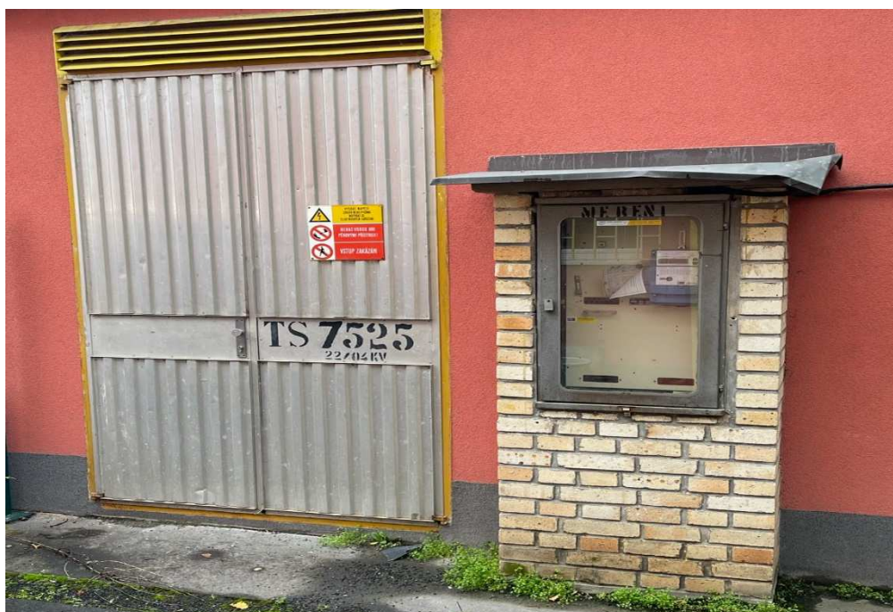
Obr. 22. TS 7225 – 22/0,4kV/630kVA, fakturační měření.
