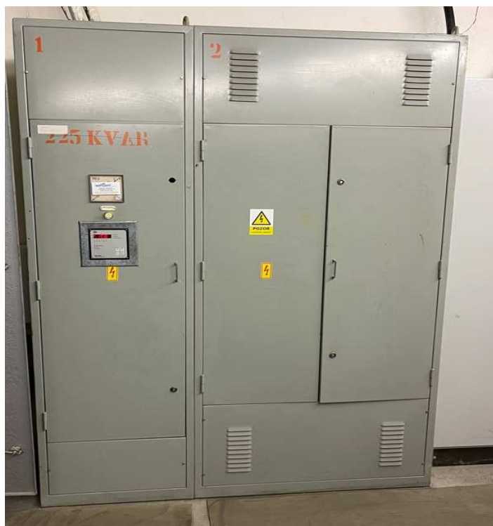
Obr. 24. Kompenzační rozvaděč, rozvodna NN.
