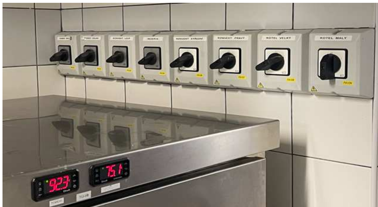
Obr. 41. Kuchyně, technologické elektro, odpovídající technický stav.
