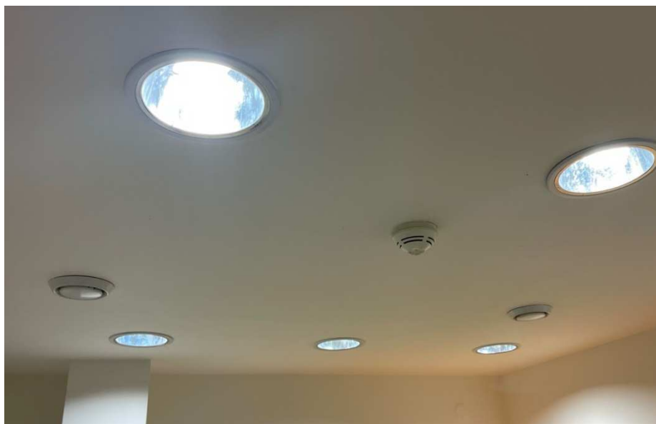
Obr. 51. Osvětlení předsínky WC, svítidla typu down-light se zářivkovými zdroji.
