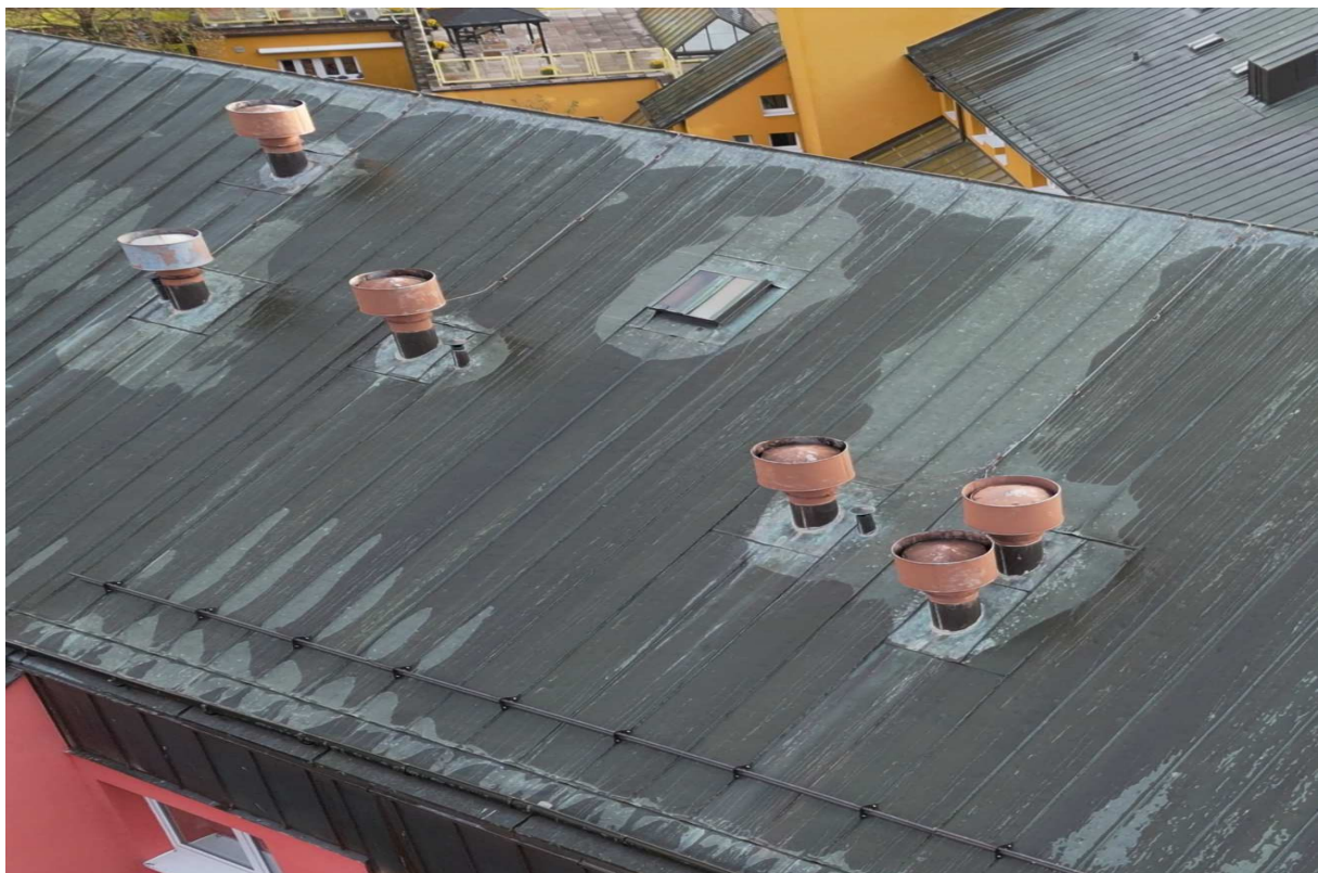
Obr. 13. Hromosvod obj. B vnější strana, zjištěna závada – některé vyústky VZT přesahují hřebem střechy, všechny vyústky jsou nesprávně (do vrchu) pospojeny s hřebenovým vedením hromosvodu na výustcích nejsou instalovány odpovídající jímače. Chybí spodní vodorovné vedení hromosvodu pro připojení chybějících jímačů na výustcích VZT.
