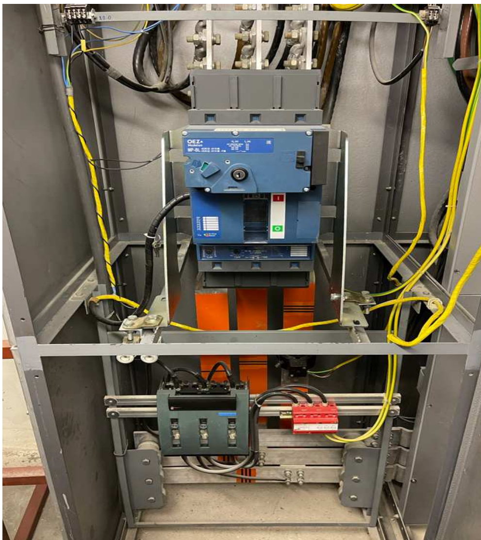
Obr. 25. Chybějící krytí I. pole hl. rozvaděče – rozvodna NN.
