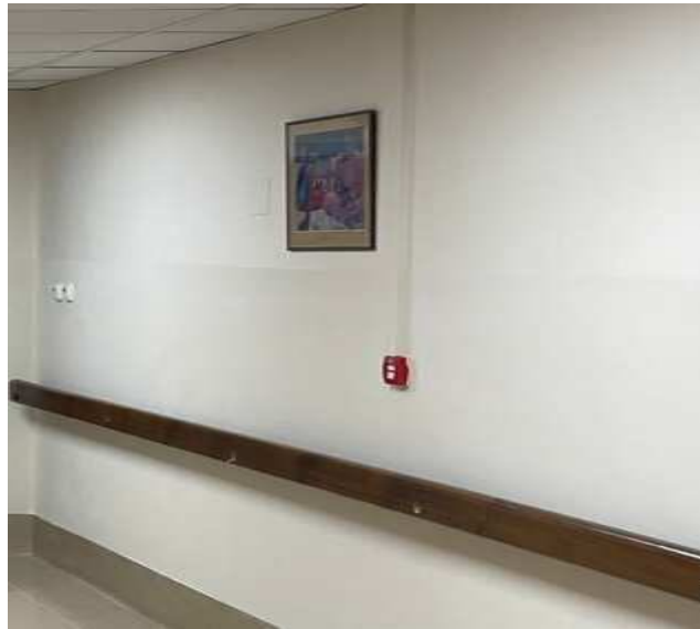
Obr. 69. Tlačítkový hlásič na chodbě.
