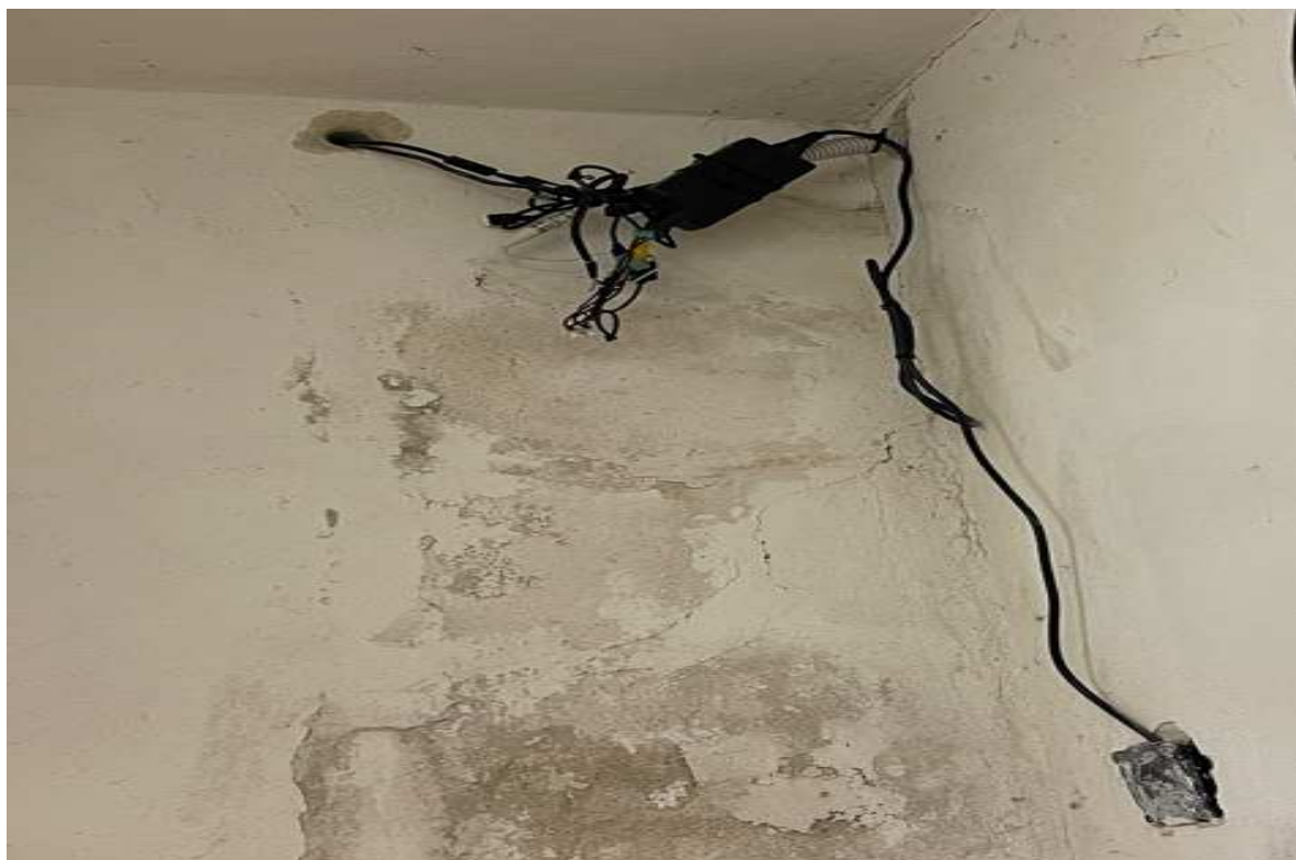
Obr. 28. „Protipožární“ prostup, instalace napájecího zdroje.
