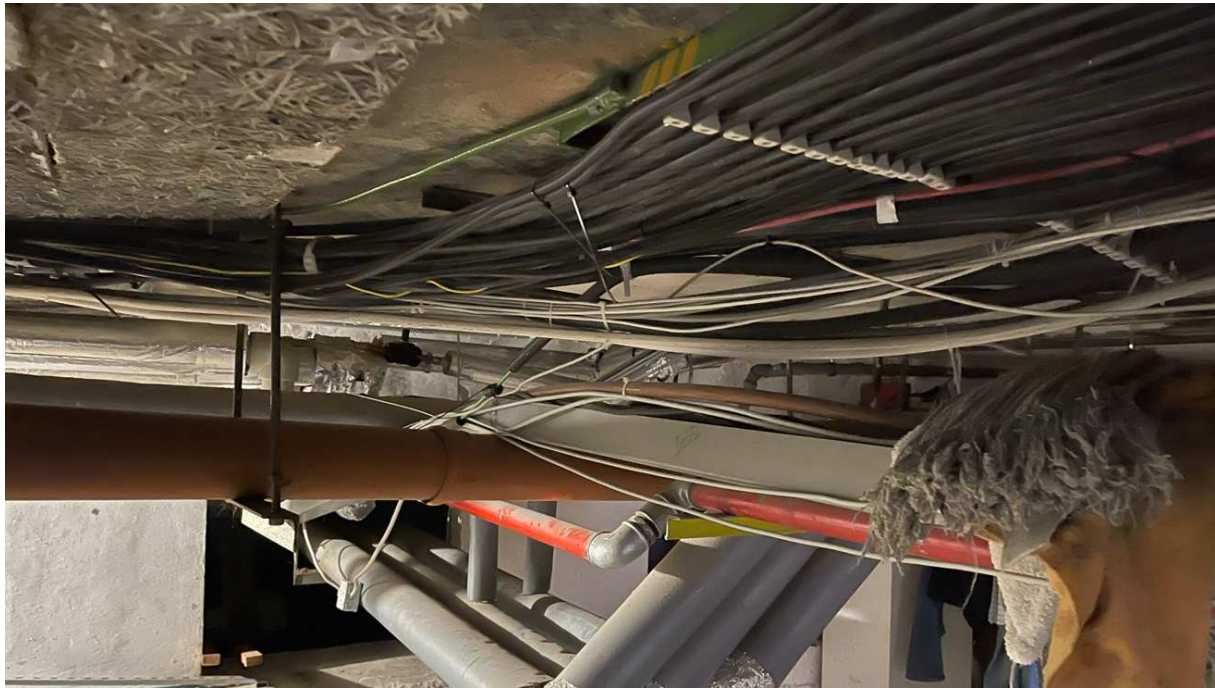
Obr. 32. Normám nevyhovující uložení kabeláže v technických prostorech.
