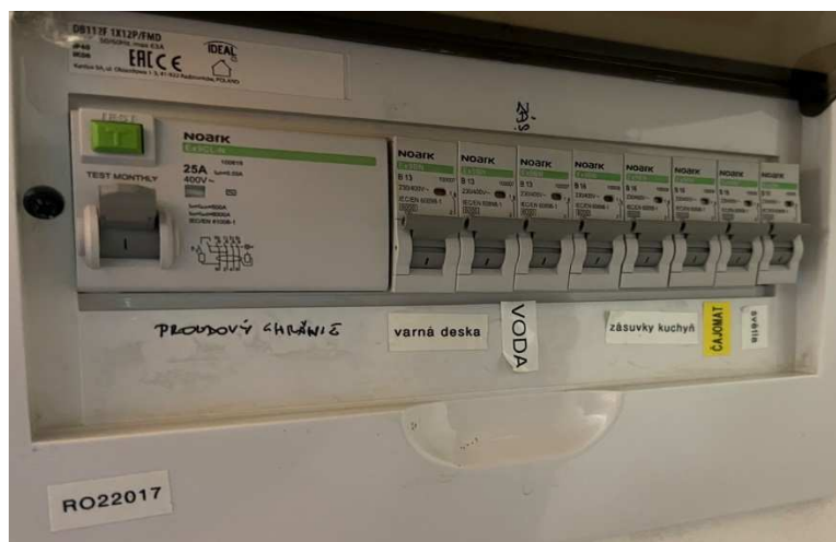
Obr. 38. Nový podružný rozvaděč, nevyhovující popis.
