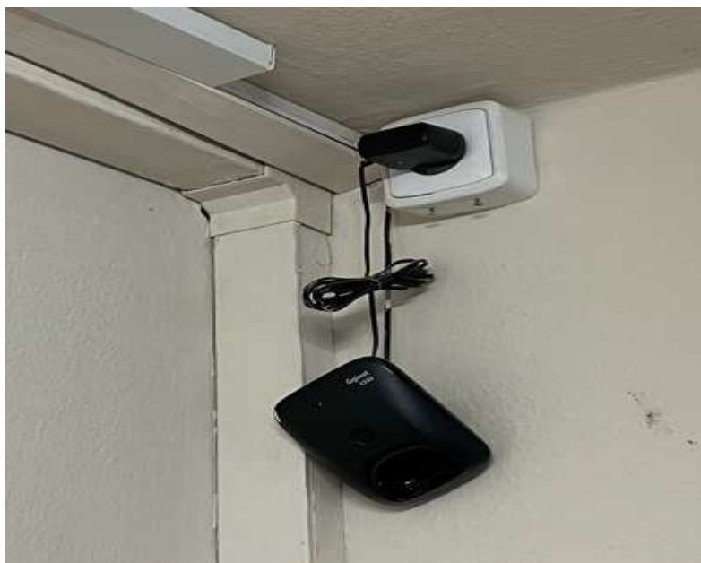
Obr. 62. Nevhodně použitá a instalovaná zásuvka 230VAC.
