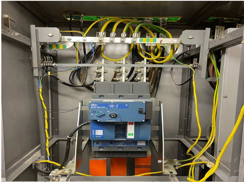
Obr. 20. Hl. rozvaděč NN, pole I. Hl. uzemňovací přípojnice.
