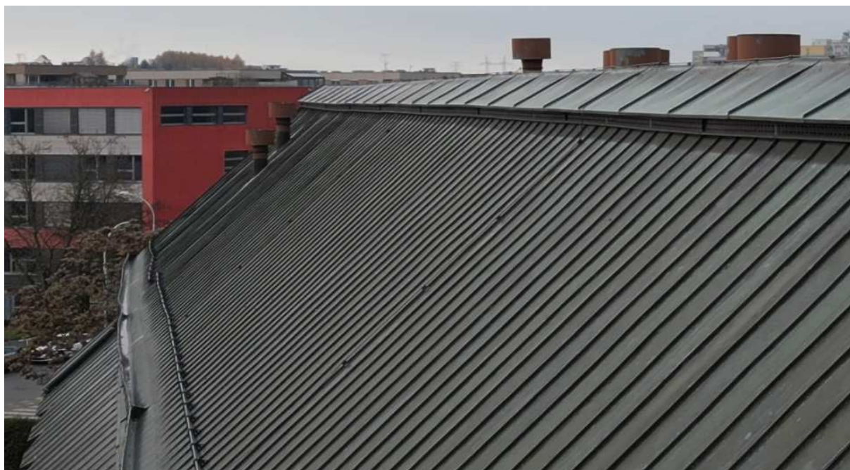
Obr. 10. Hromosvod obj. B vnitřní strana, zjištěna závada – vyústky VZT přesahují hřebem střechy, jsou nesprávně (do vrchu) pospojeny s hřebenovým vedením hromosvodu na výustích nejsou instalovány odpovídající jímače.
