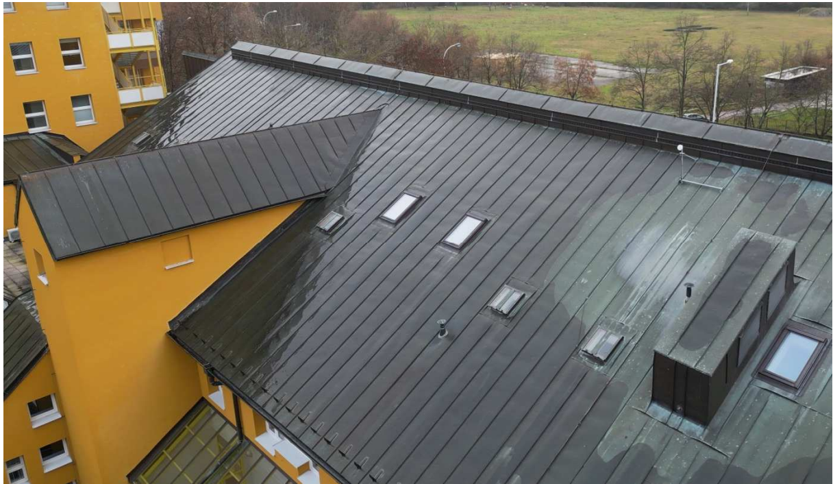
Obr. 15. Hromosvod obj. C vnitřní levá a střední část střechy.
