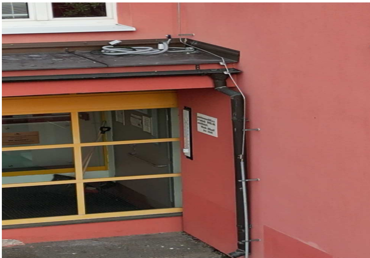
Obr. 18. Hromosvod obj. C vnější část, vnější svod, zjištěná závada – v blízkosti svodu je kabeláž, v případě zásahu bleskem hrozí indukce či průraz vysokého napětí do podružných el. rozvodů.
