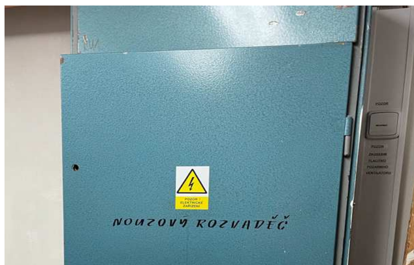
Obr. 58. Rozvaděč původního systému NO.
