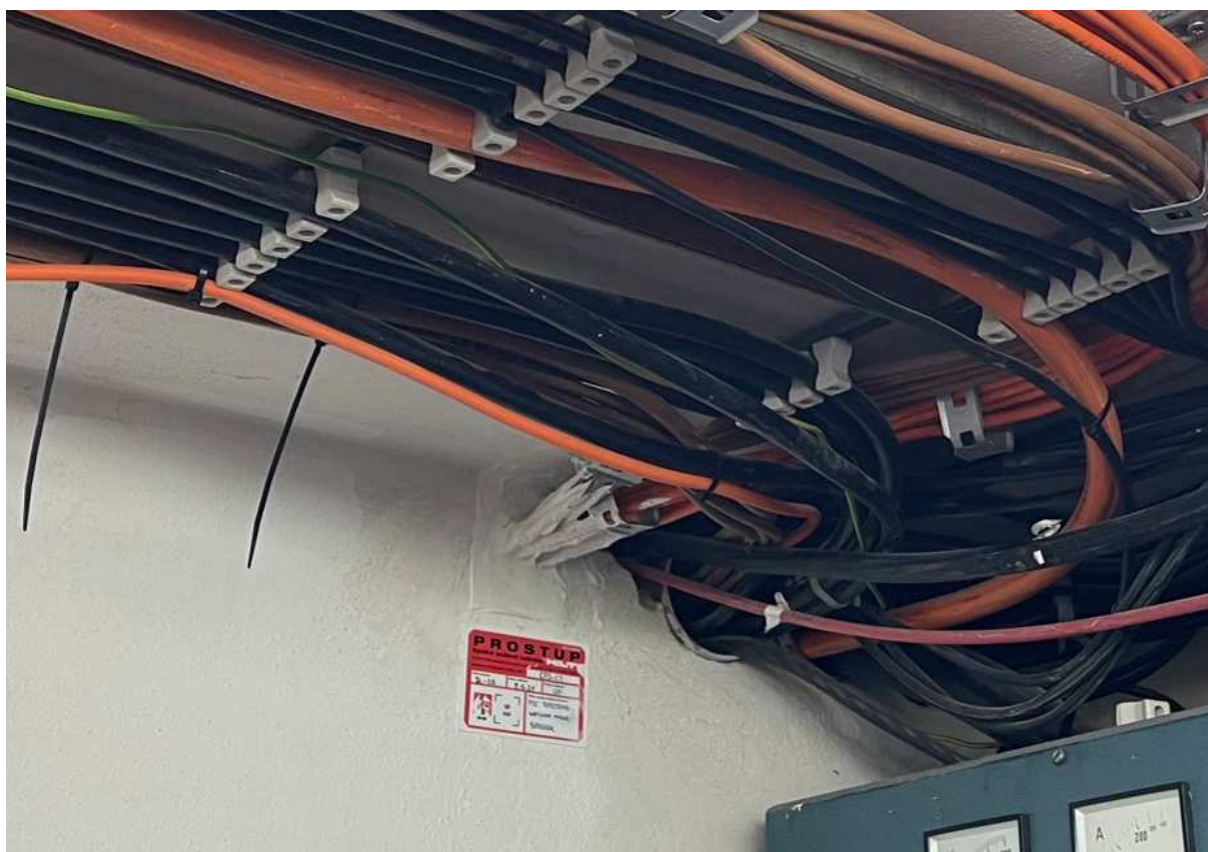
Obr. 26. Správně provedený vstup vedle nesprávně provedeného prostupu.
