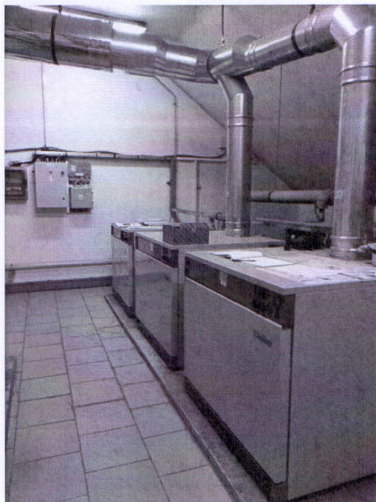
Plynové kotle na ohřev topné vody v kotelně ve 5.NP
