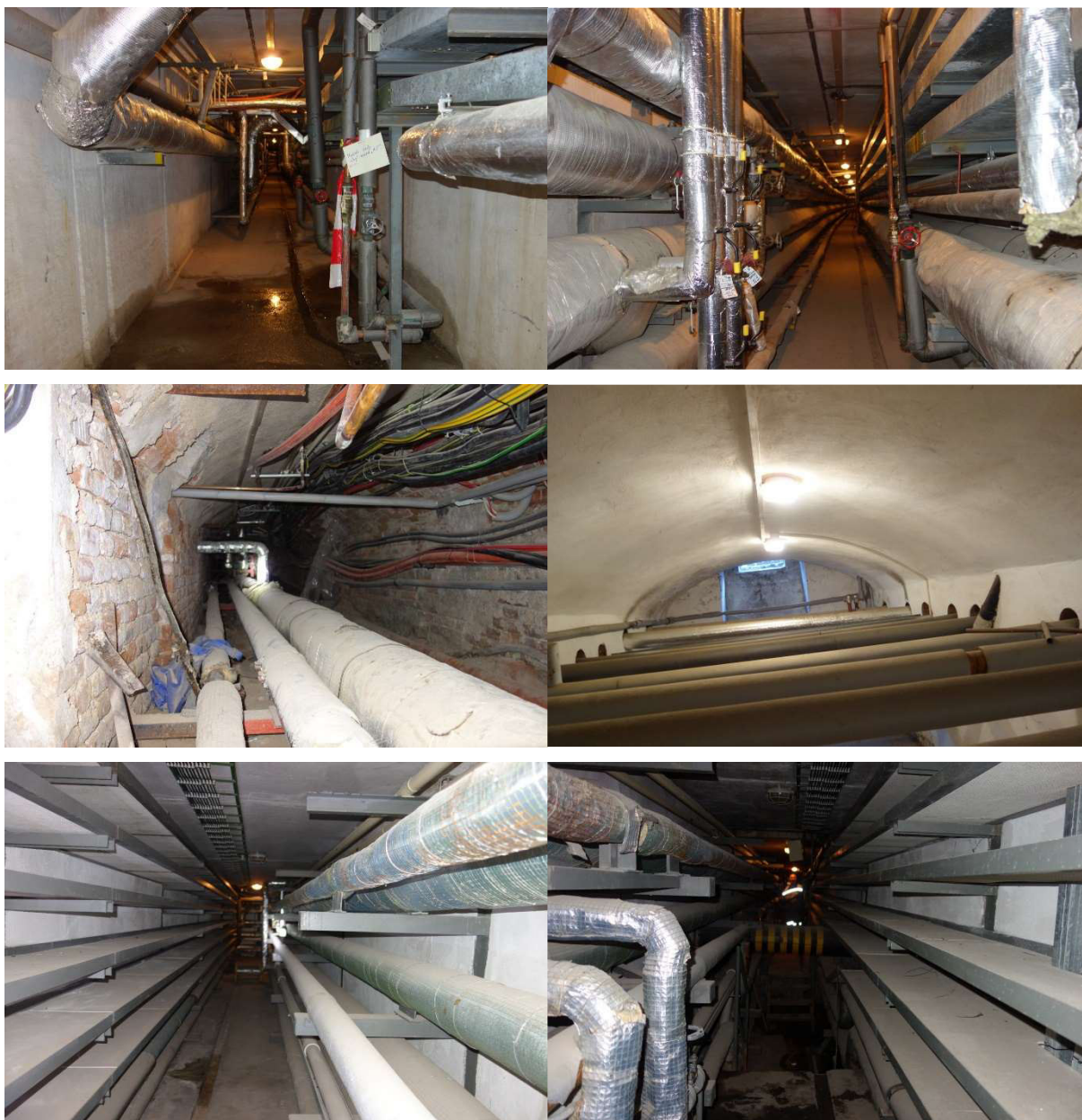
Instalační kolektory v objektech A1-A2-A4-A5
