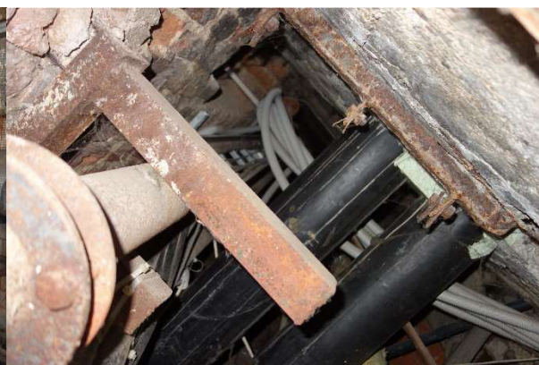
Instalační kanál propojující objekty C-D-D3
