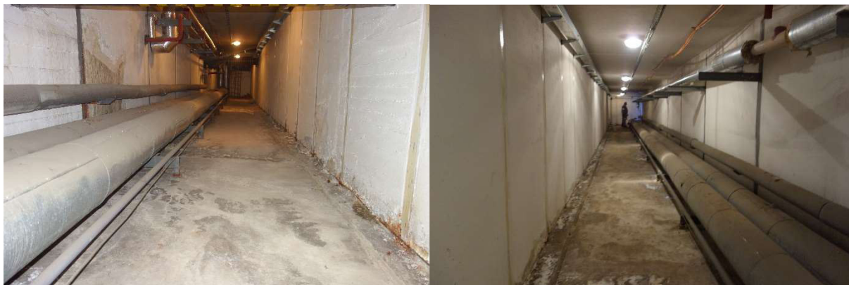
Instalační kolektor mezi objekty S a V
