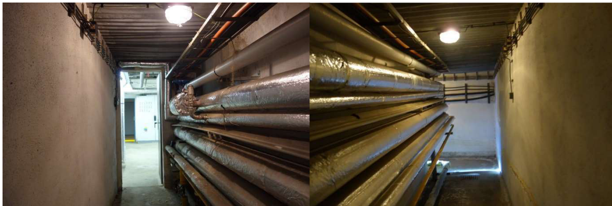
Instalační kolektory v objektech M-M1-A4
