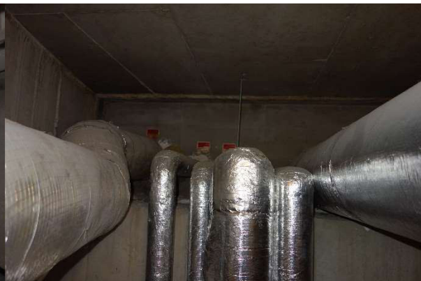
Vstup do chráničky u objektu D1
