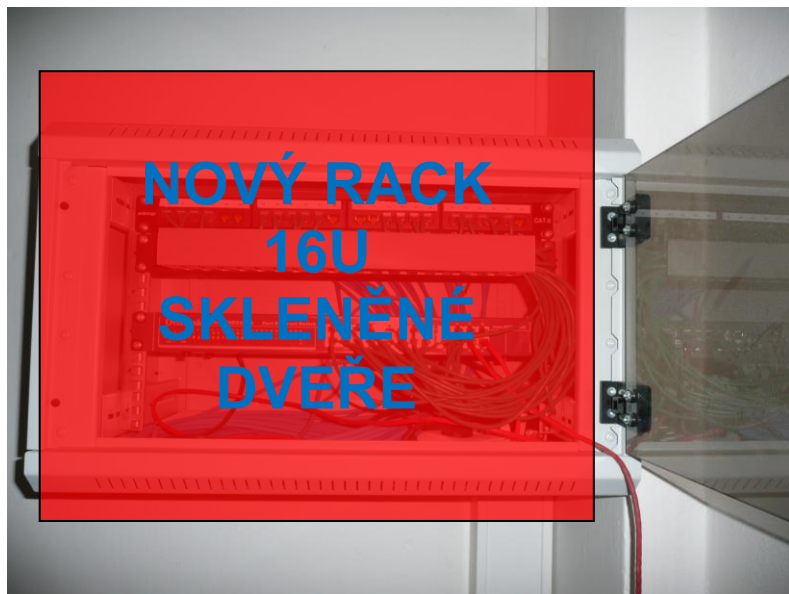
Umístění nového rozvaděče v místnosti 15 – PC učebna (1.NP část C)
