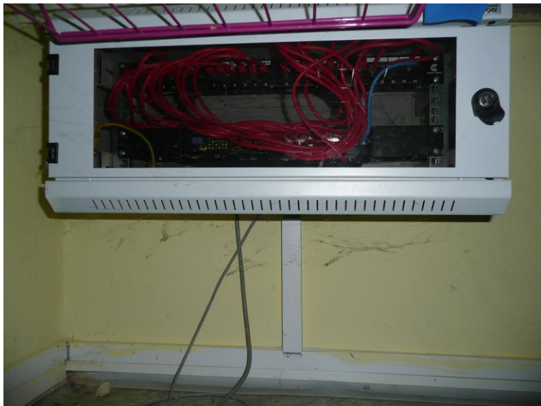
Rozvaděč v místnosti 94 – PC učebna (1.NP část A+B)
