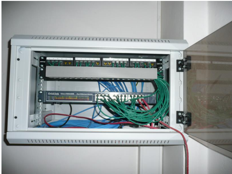
Rozvaděč v místnosti 15 – PC učebna (1.NP část C)
