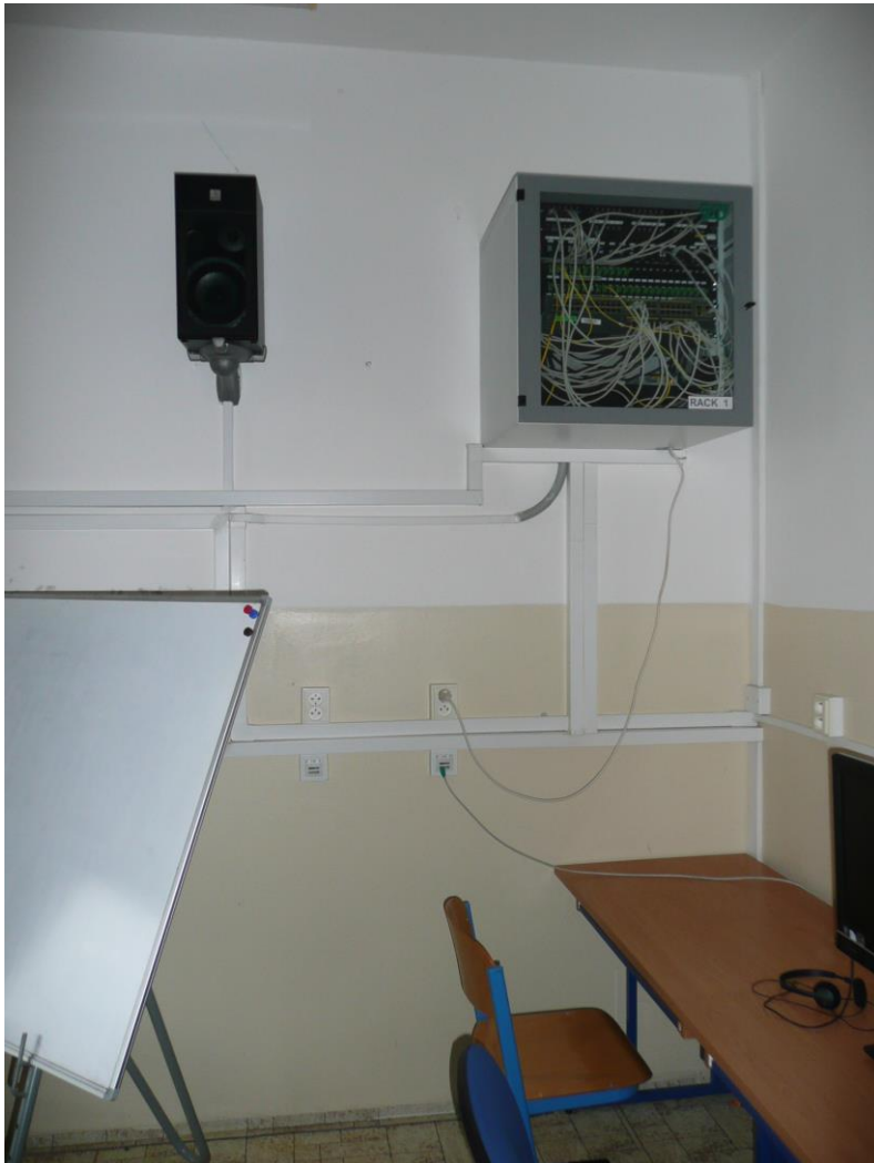
Rozvaděč v místnosti počítačové učebny INDOŠ č. 2.03 v pavilonu 431 - 2.NP
