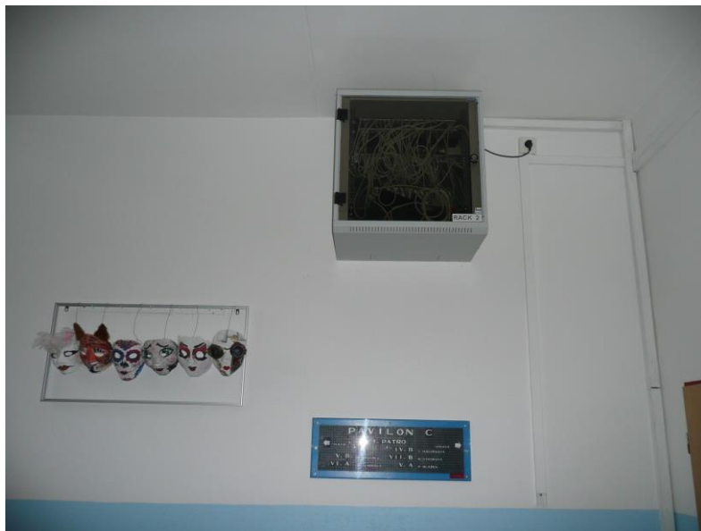
Rozvaděč na chodbě v pavilonu 420 na schodišti 2.NP
