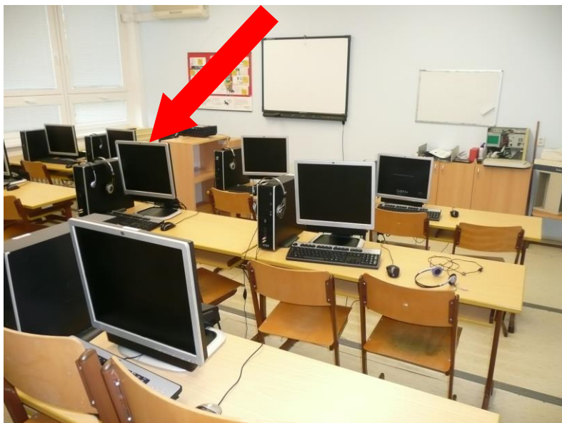
Umístění switche v místnosti počítačové učebny č. 1.30 (28) v pavilonu 431 - 1.NP
