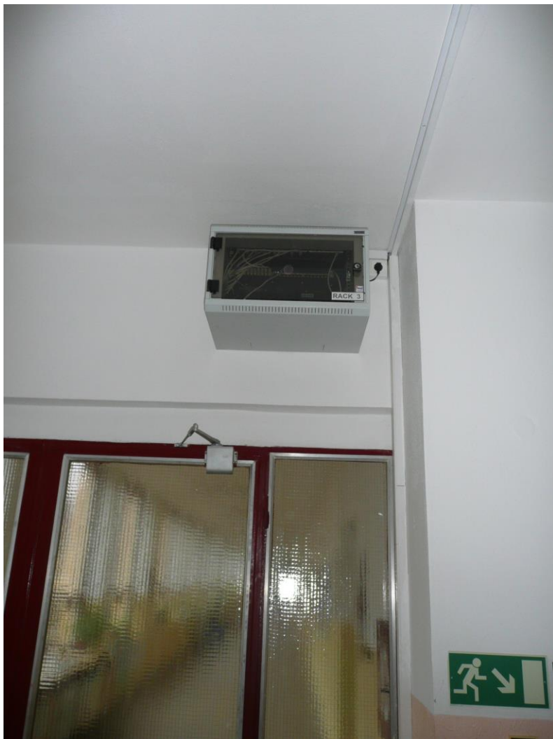
Rozvaděč na chodbě v pavilonu VJ 1-9 na schodišti 2.NP
