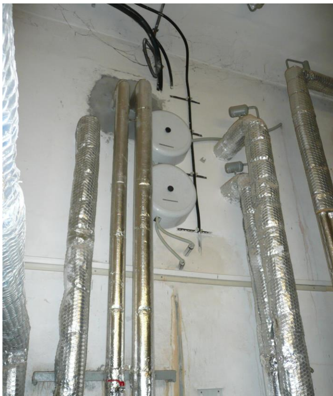
Rezervy optických kabelů v suterénu pavilonu 440 – místnost měření tepla
