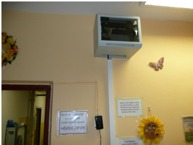
Rozvaděč v místnosti Vedoucí ŠJ č.15 v pavilonu 41 - 1.NP
