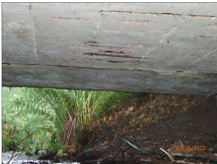
Podhled NK u P boku mostu, poruchy krycí vrstvy.
