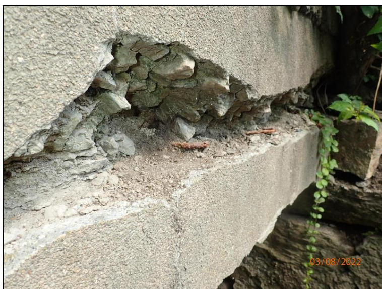
P bok mostu, hluboký mrazový rozpad betonu v horizontálním pruhu, nejspíše podél prosakující pracovní spáry.
