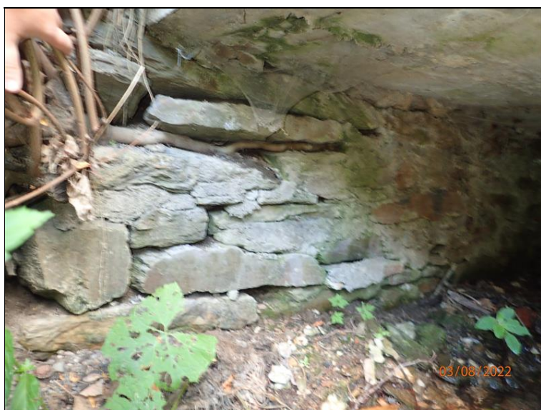
Detail rozvolněného zdiva O1 u P boku mostu.
