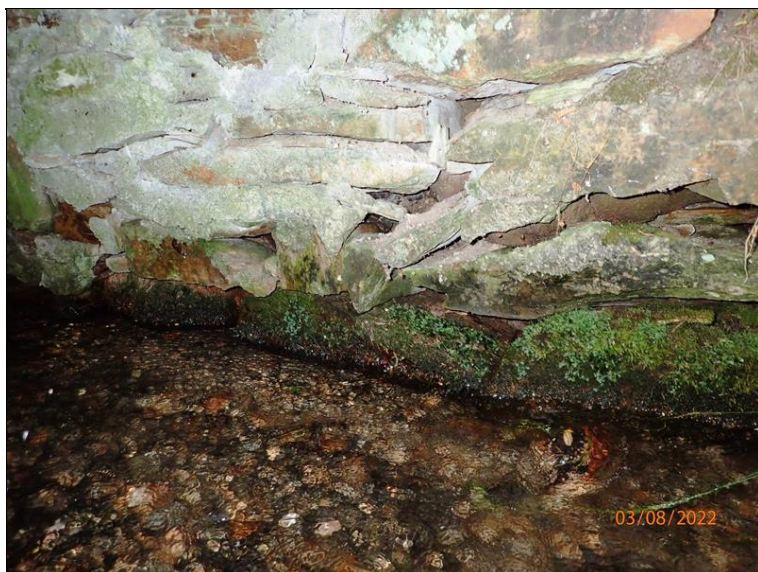
Detail rozvolněného zdiva v líci O1 u L boku mostu.
