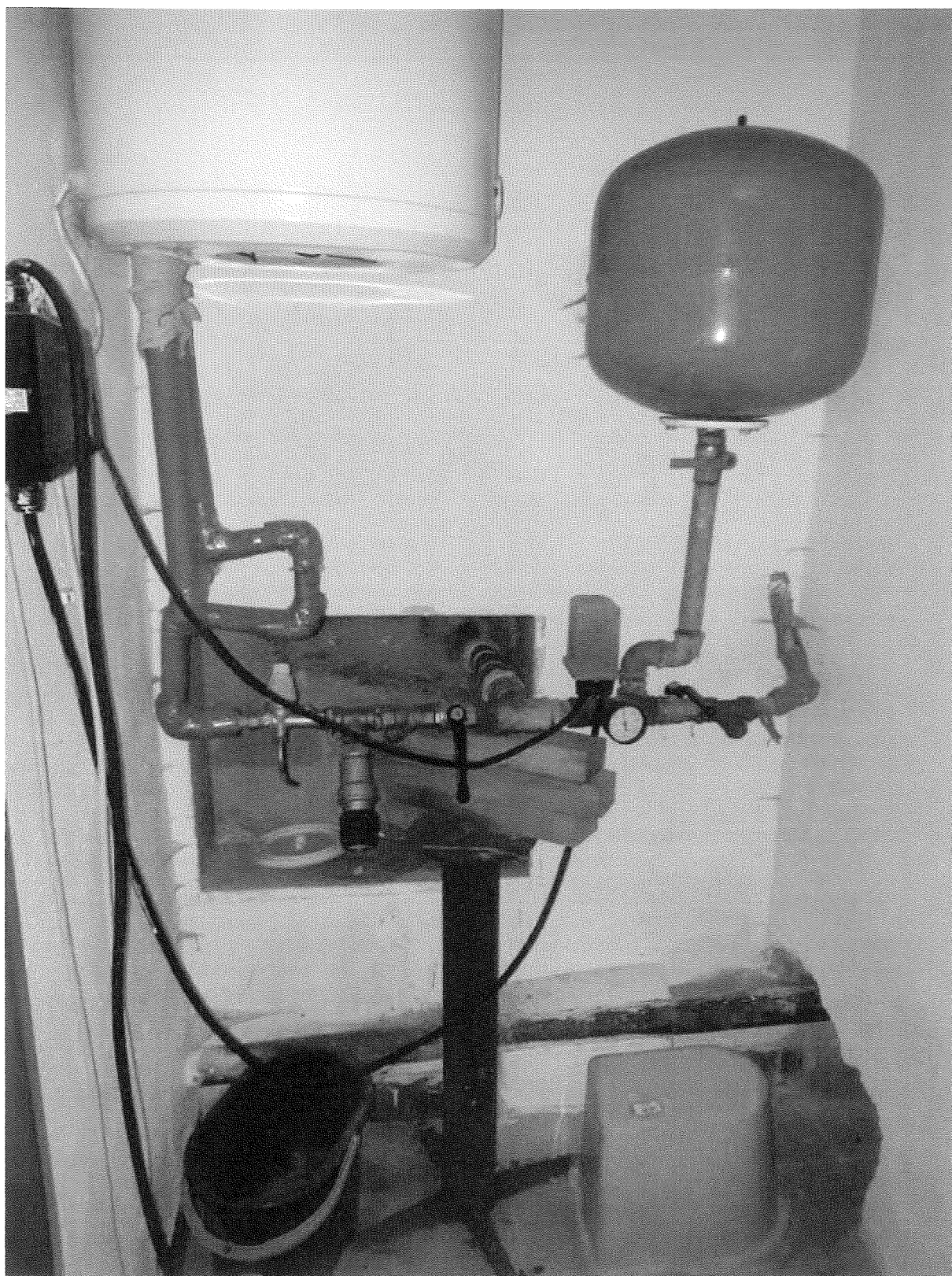
Pohled na rozvod vody
