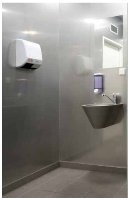
▲ ilustr. foto: sociálne zariadenie v antivandál. prevedení (foto: KOMA)
