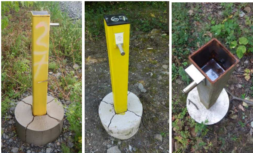
Obrázek 19 Popraskané betonové základy zajišťovacích značek ŽPSV
