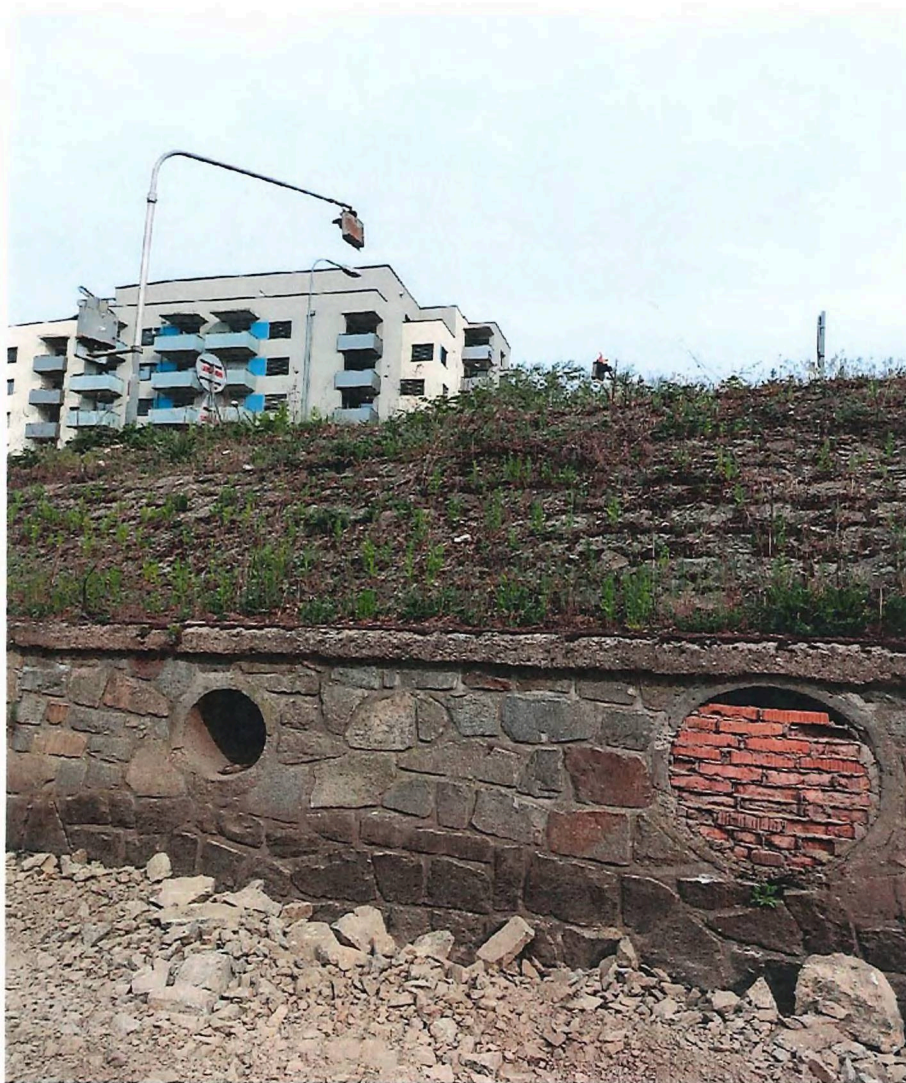
Výust 2 - nefunkční výusti kanalizace - zalití potrubí jílocementovou směsí
