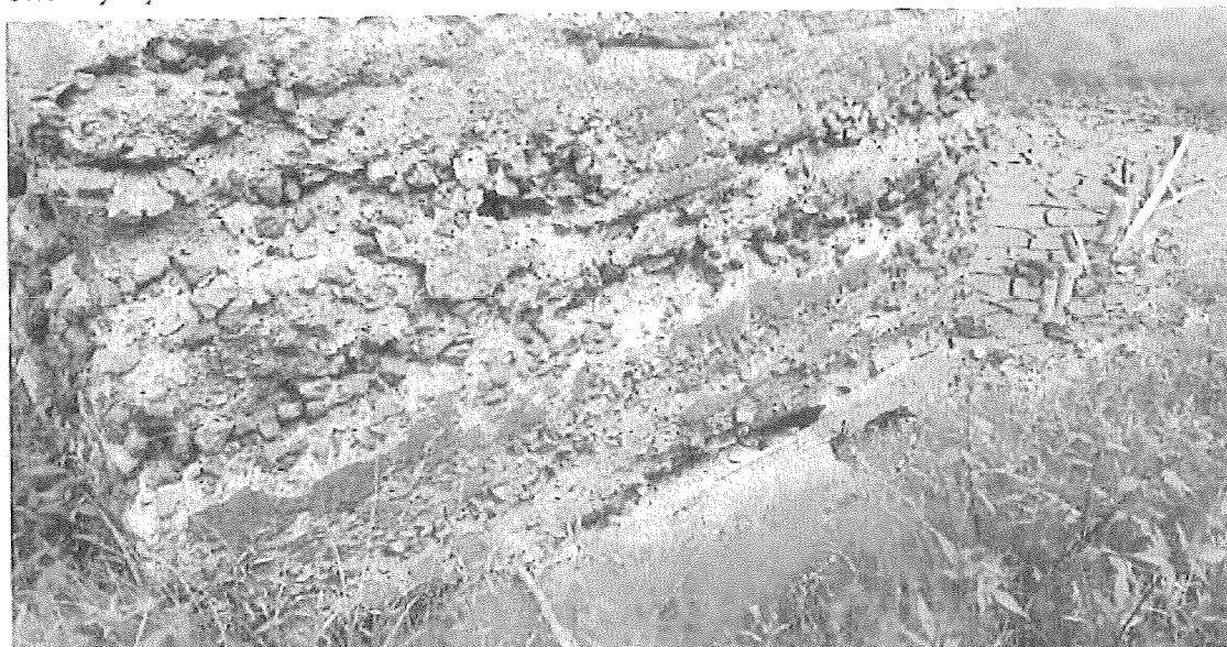
Sdružený objekt – narušené zdivo
