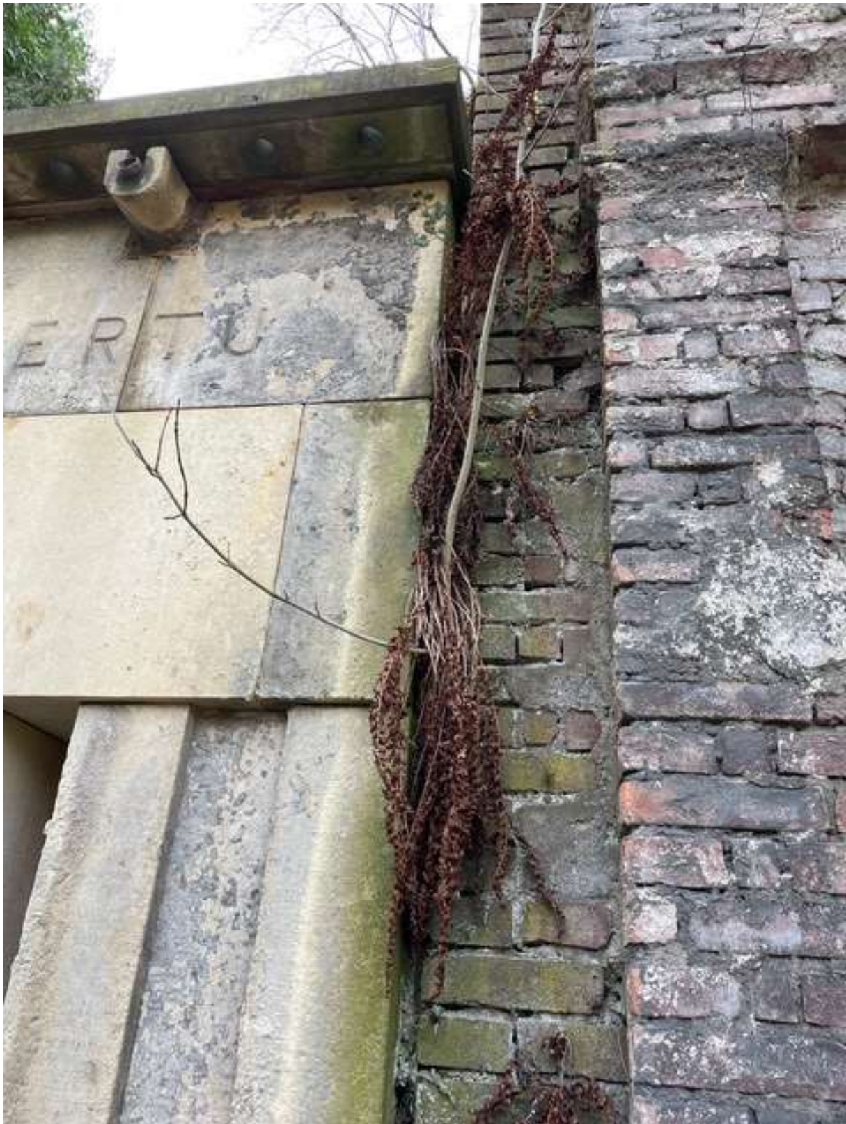
6./Jižní strana sousedící na východní straně s kaplovou hrobkou – do spáry zatéká, usazeny náletové dřeviny, kámen vlhkostí degraduje, tvoří se krusty a je napaden řasami
