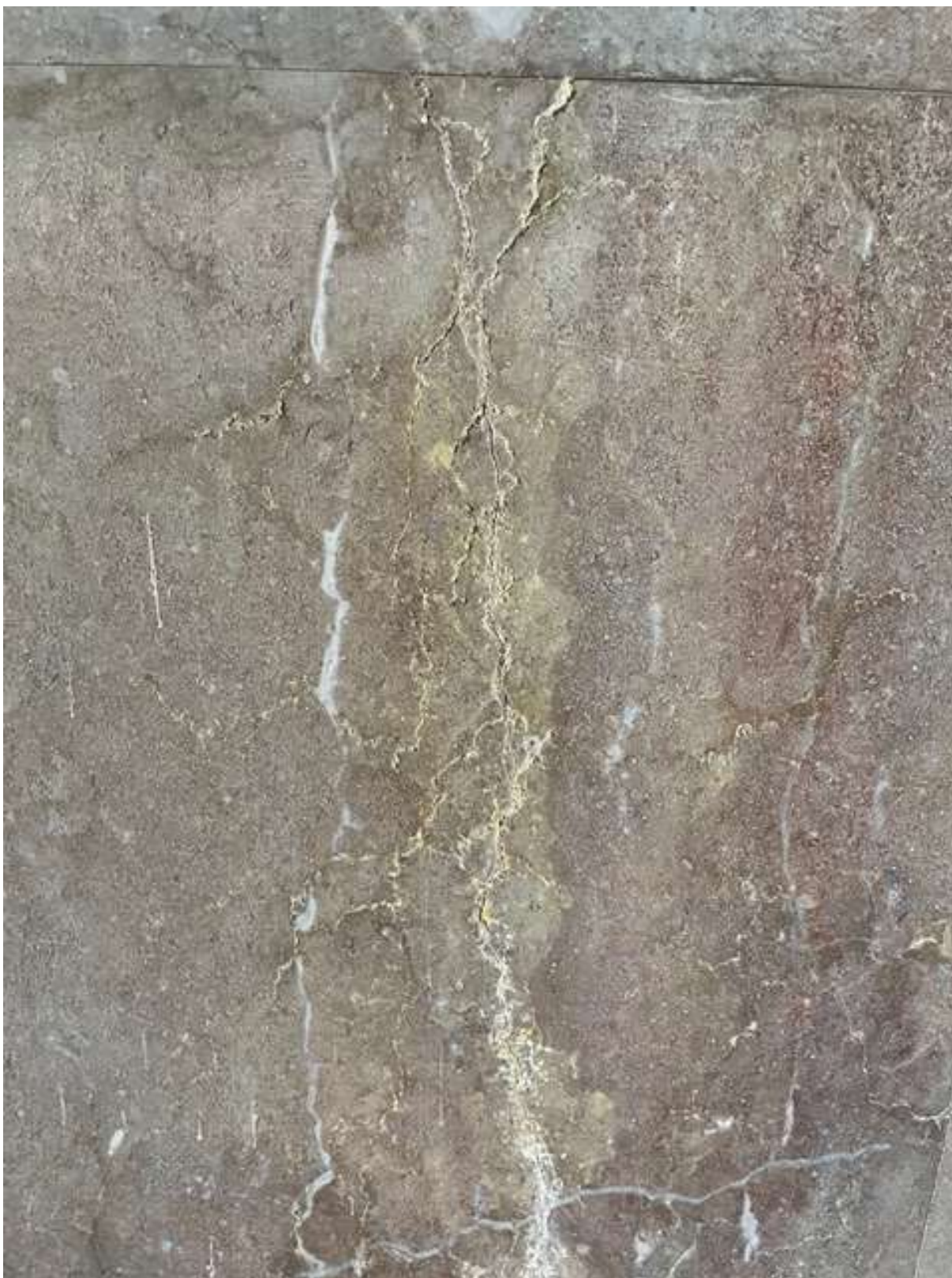
11./západní a východní stěna obložené sliveneckým mramorem, místy poškozené vystouplými sedimenty.
