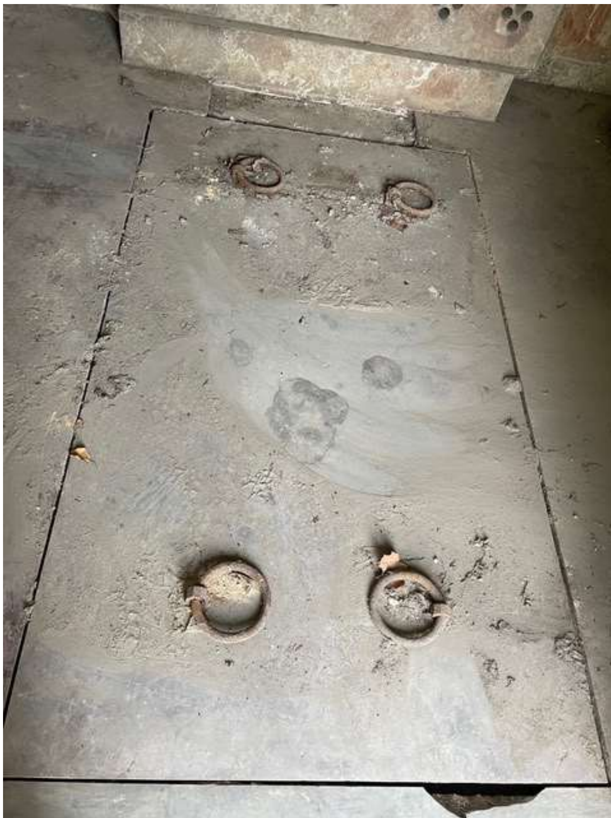
12./ krycí deska krypty, olejové skvrny, vylomená a chybějící část podlahy
