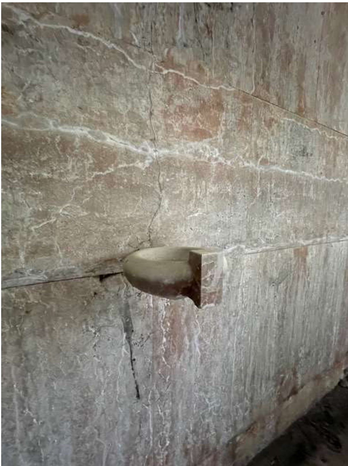
12./ umístění kropenky na východní straně, mechanické poškození mramoru, ztráta lesku na obkladových deskách.
