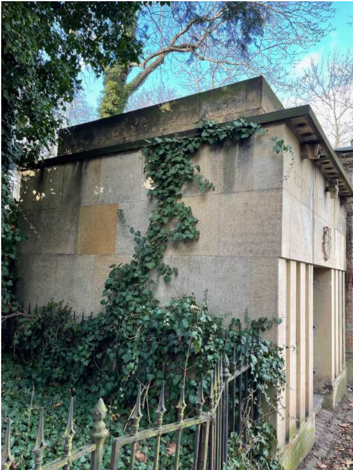
7./ západní stěna napadena břečťanem a řasami, na atice je vidět povrchová degradace kamene
