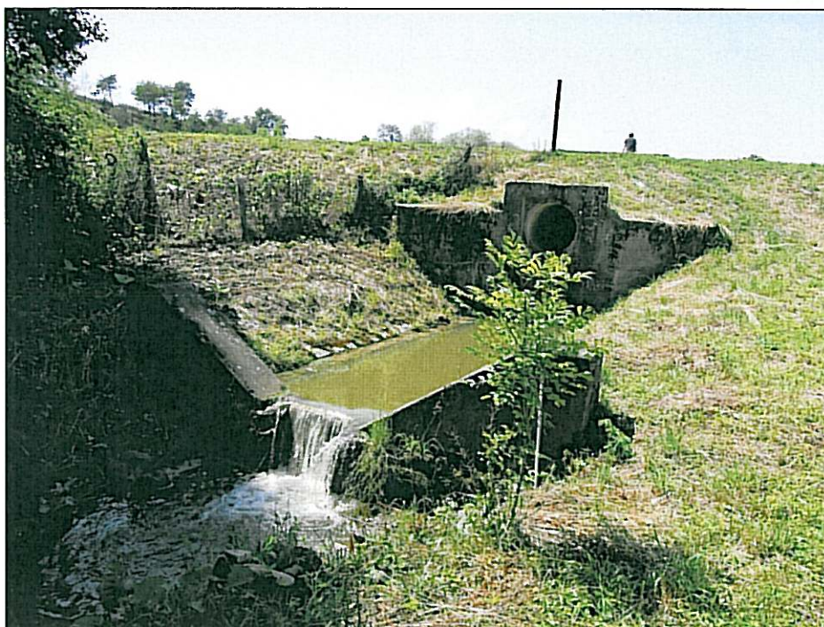
Pohled na vývar u odpadu koryta
