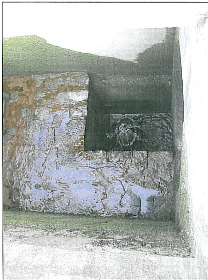
Uzávěr v šachtě sdruženého objektu
