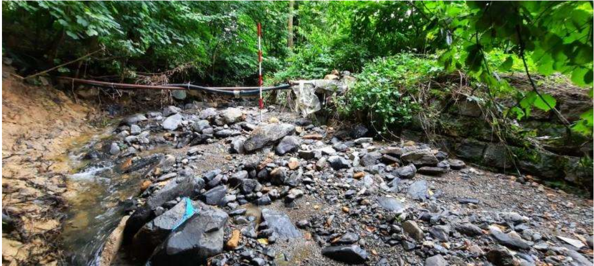
Zanesený průtočný profil sedimentem v ř.km 2,700
