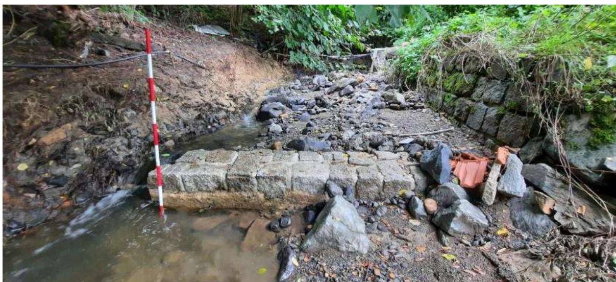
Poškozené zavázání prahu na PB v ř.km 2,690
