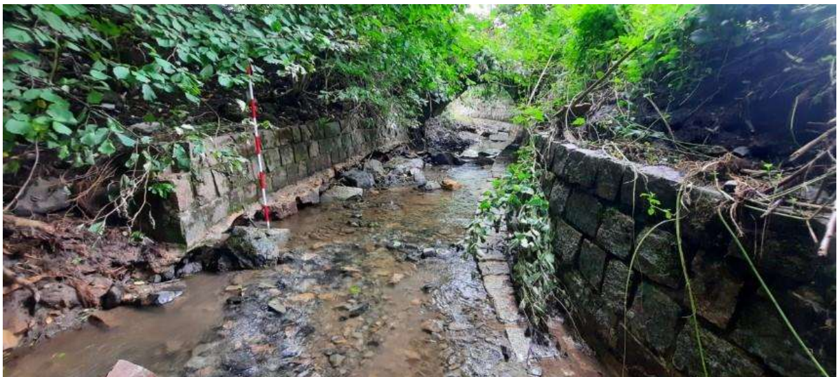
Chybějící zavázání opěrné zdi, podemleté základové patky v ř.km 2,720
