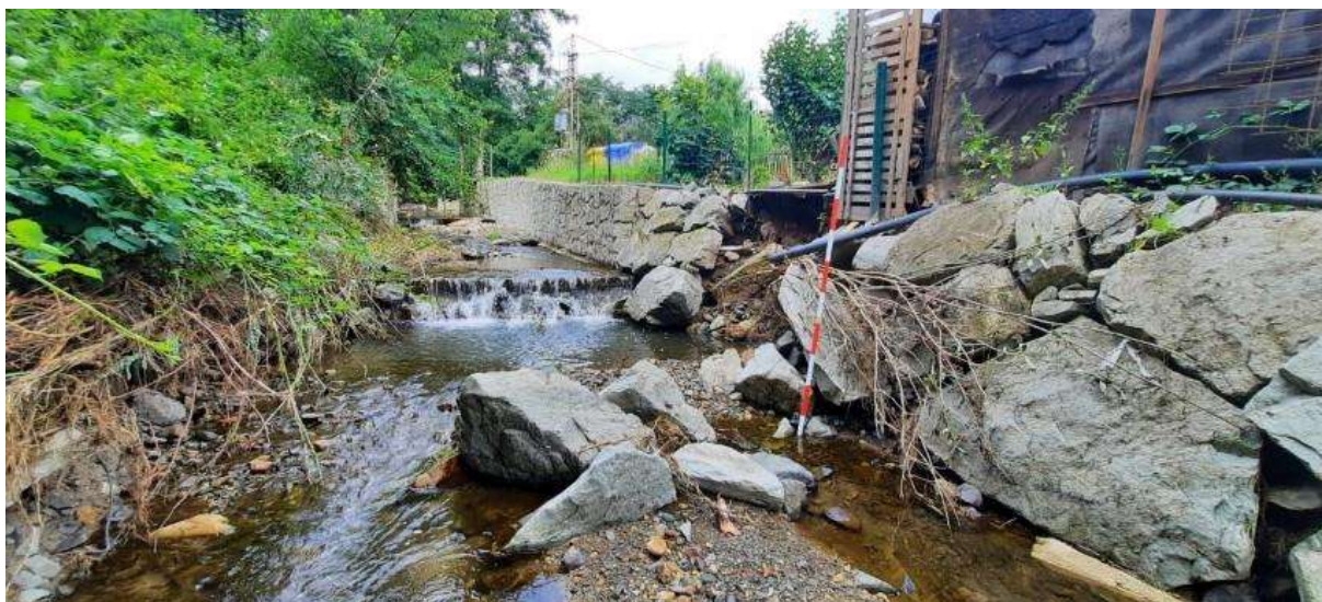
Poškozené opevnění z kamenné rovnaniny v ř.km ř.km 2,320 – 2,396
