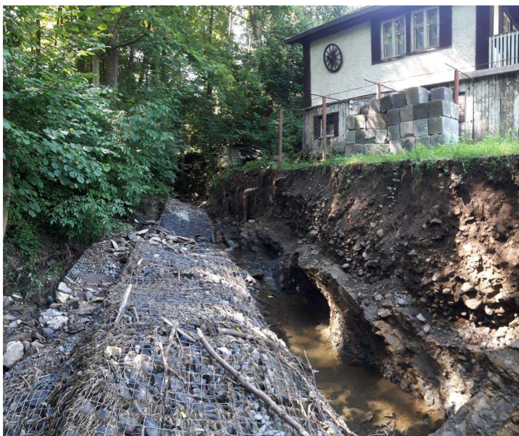
Spadlá gabionová zeď v průtočném profilu v ř.km 2,790 – 2,830
