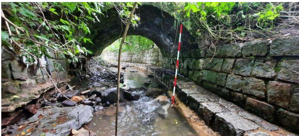
Zahloubené koryto, podemleté základové patky v ř.km 2,750
