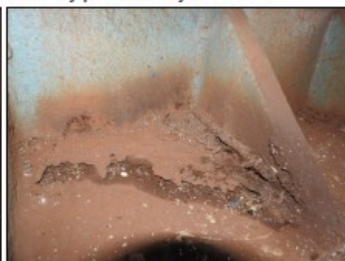
foto č. 2 - ložisko na P 01 vpravo - plátková koroze
