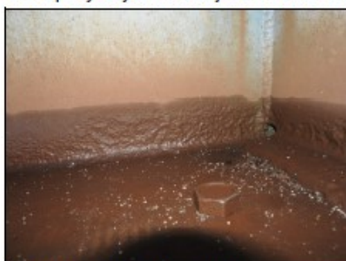
foto č. 1 - P. HL. N. nad O 01 - oslabení
