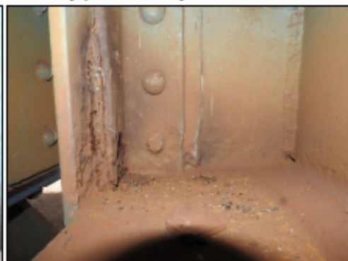
foto č. 6 - P. HL. N. horní pásnice nad P 02 - oslabení nýtů
