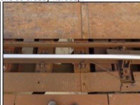
foto č. 17 - K 03 - popraskané mostnice
