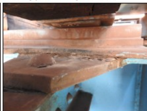
foto č. 4 - P. HL. N. horní pásnice nad P 01 - štěrbin. koroze
