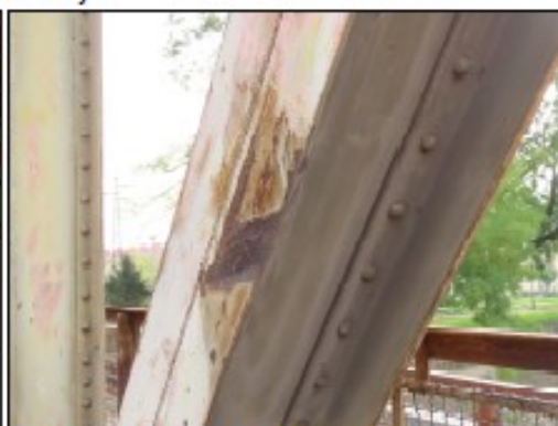
foto č. 6 - L. HL. N. mezi 4. a 5. svislicí - deformace
