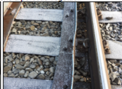
foto č. 14 - pravá kolej zač., pravý poj. úhelník - deformace
