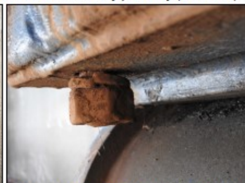
foto č. 12 - L. HL. N. ložisko na O 02 vlevo - povolený šroub
