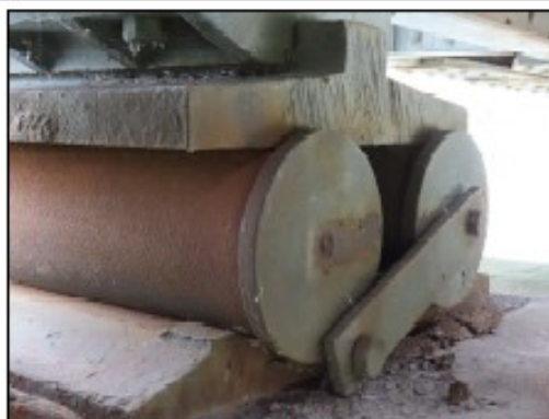
foto č. 7 - K 02 pravé ložisko na P 02 - ushřezžený šroub
