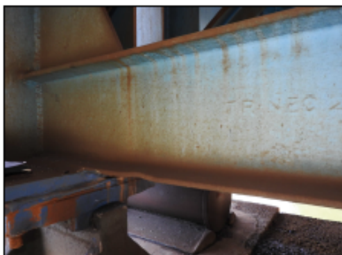
foto č. 7 - K 05 poslední příčné ztužení - deformace
