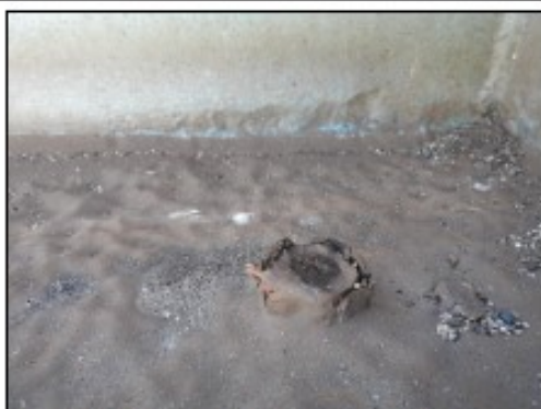
foto č. 9 - K 08 L. HL. N. nad L ložiskem - štěrbin. korozí
