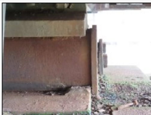
foto č. 8 - K 02 levé ložisko na P 02 - posunutý válec
