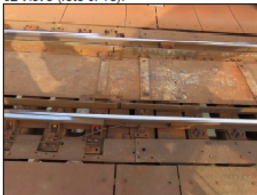
foto č. 15 - K02/K03 - chybějící podkladnice, vrtule
