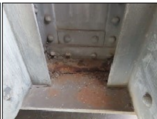
foto č. 2 - P. HL. N. nad P 02 - oslabení
