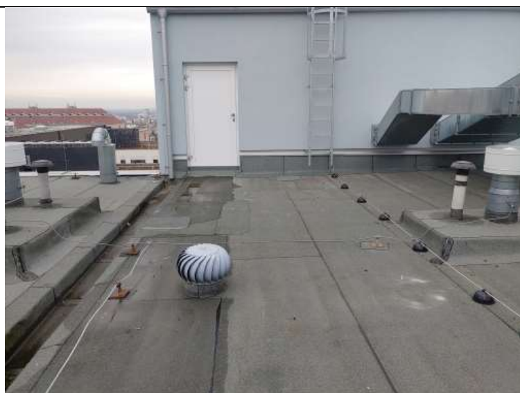
KONEC LÁVKY U DVEŘÍ DO STROJOVNY
