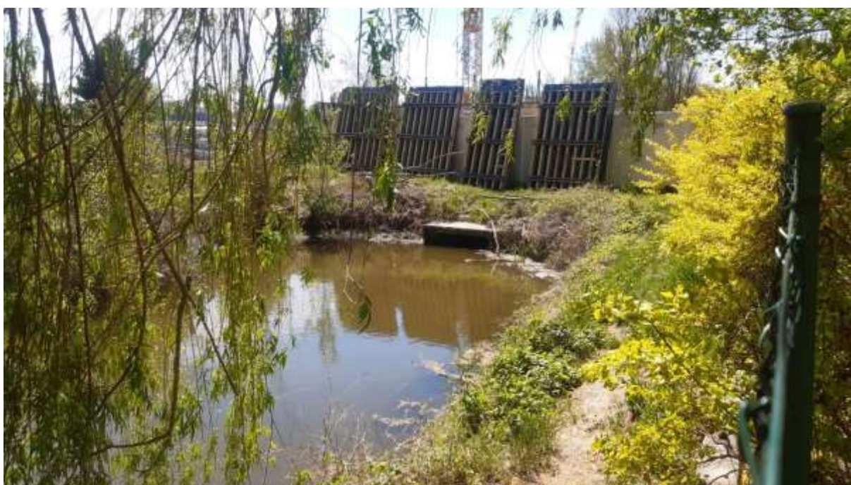
Obr. č. 10: Ústí do druhého zatrubněného úseku, na čele možnost osazení dlužové stěny, dle rekognoskace v terénu zatrubnění částečně zadluženo.
