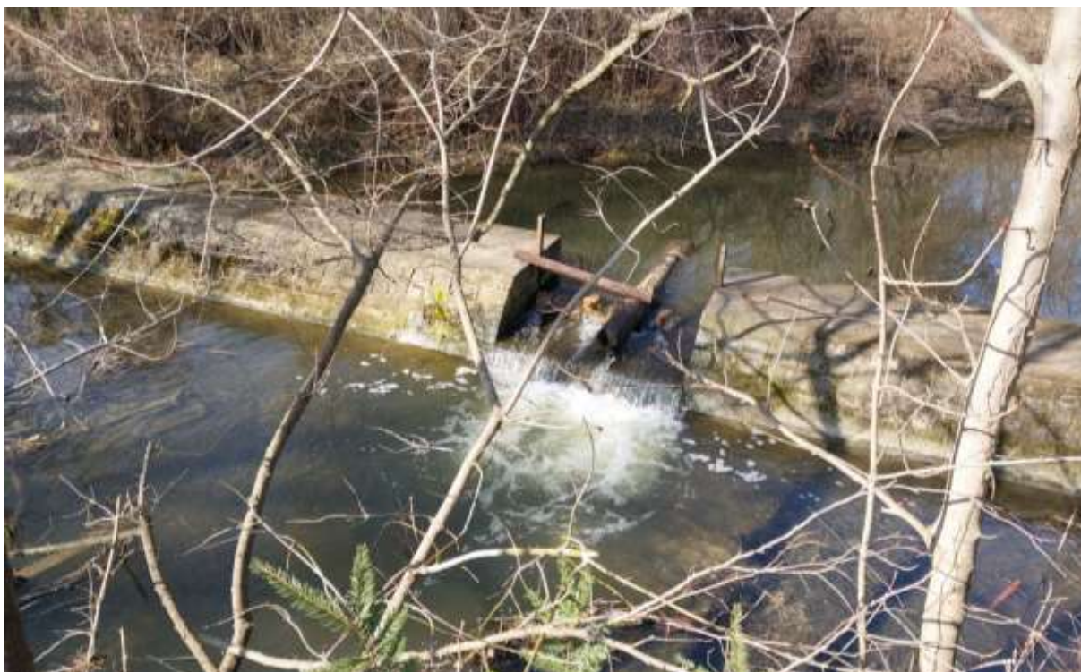
Obr. č. 5: Manipulační objekt u Vranova mlýna - monolitická přehrážka s výřezem pro běžné průtoky s možností osazení dlužové stěny
