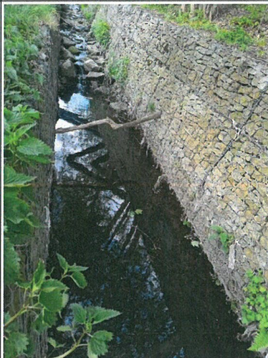
Poškozená gabionová zeď
