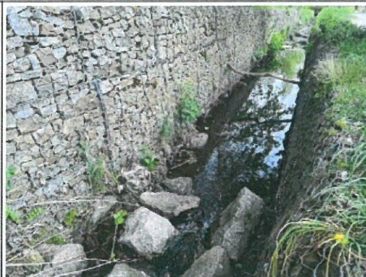
Poškozená gabionová zeď
