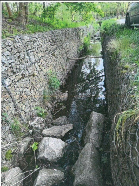
Poškozená gabionová zeď
