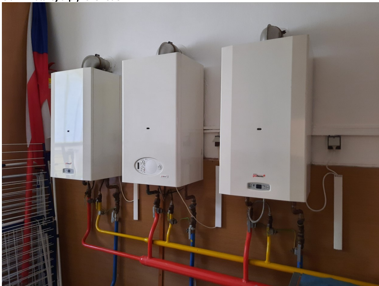
Obr. 1 – Stávající plynové kotle
