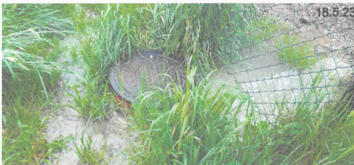
Foto 1: Výron vody u Š-1
