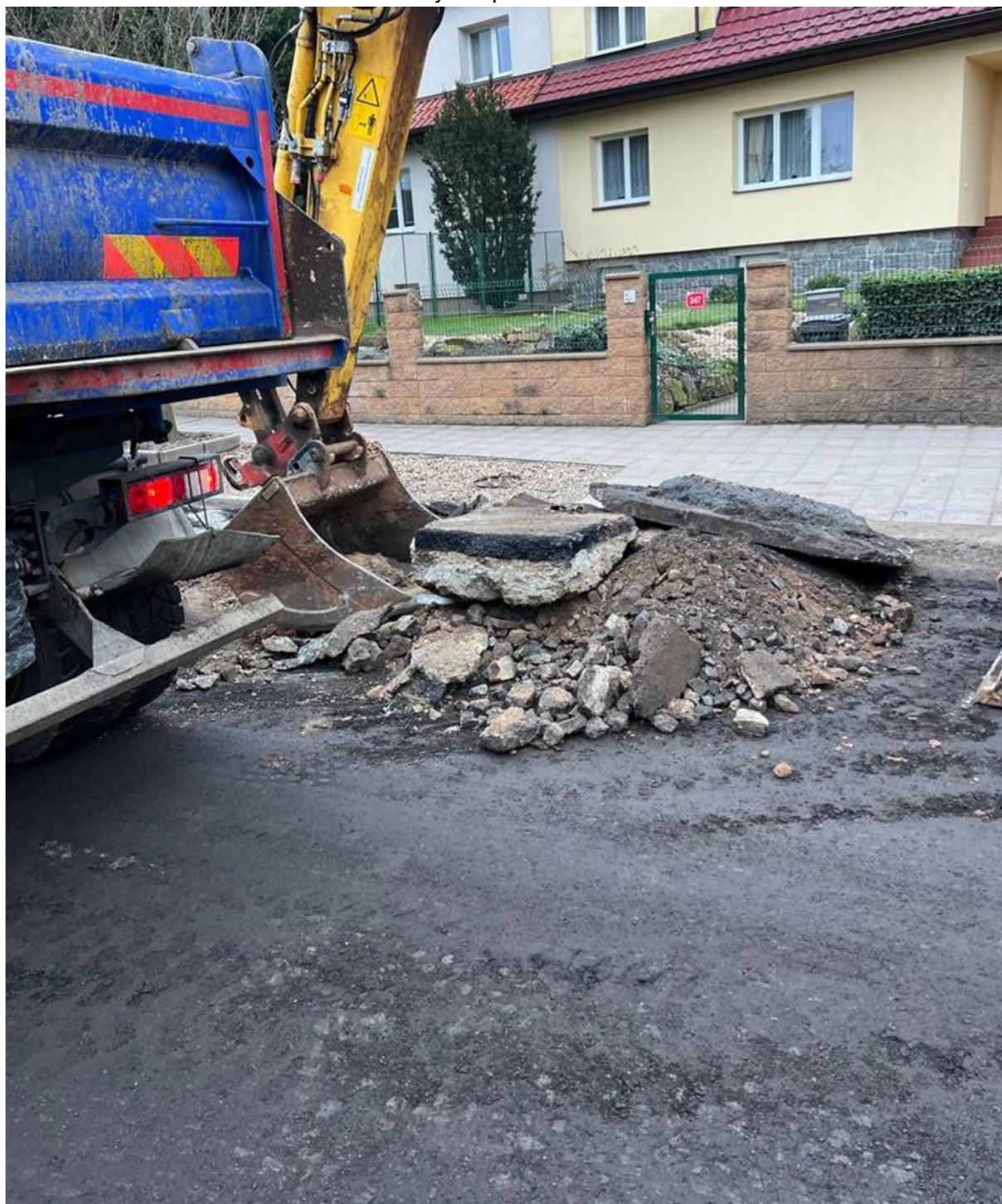
Příloha č. 3 – Fotodokumentace stavu stávajících podkladních vrstev
