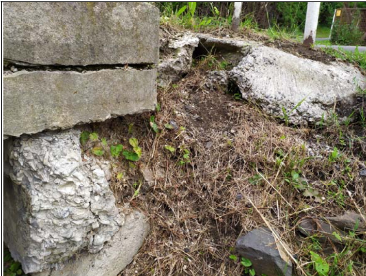
Eroze za opěrou 1 vlevo
