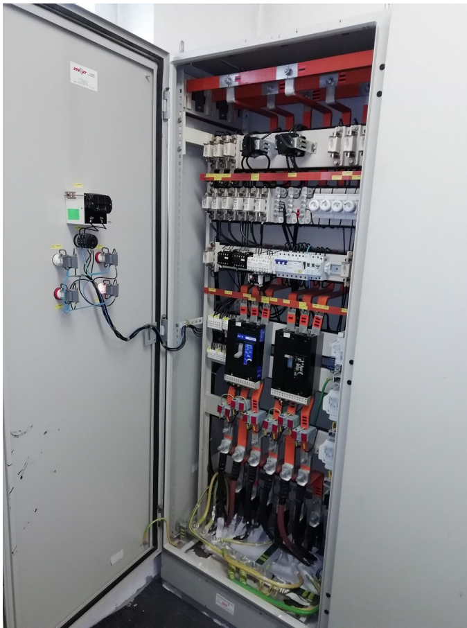
Foto rozvaděče RM6234 pole 1
