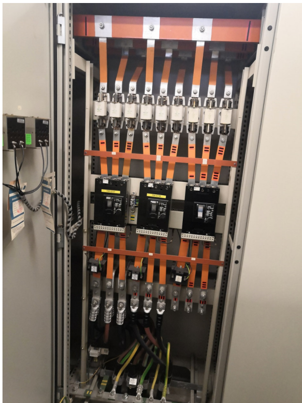
Foto rozvaděče RMH7 pole 4 (pole 3 je obdobné)
