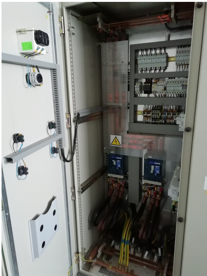
Foto rozvaděče RM6715 pole 1
