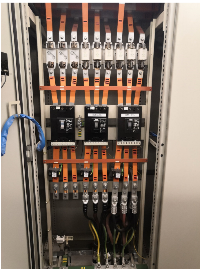
Foto rozvaděče RMH6 pole 4 (pole 5 je obdobné)
