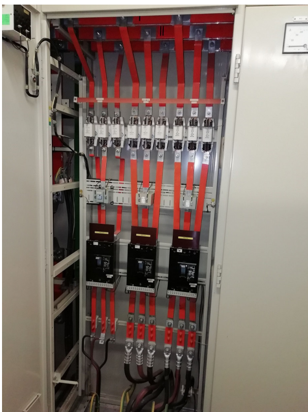
Foto rozvaděče RMH4 pole 3 (pole 4 a pole 5 jsou obdobná)
