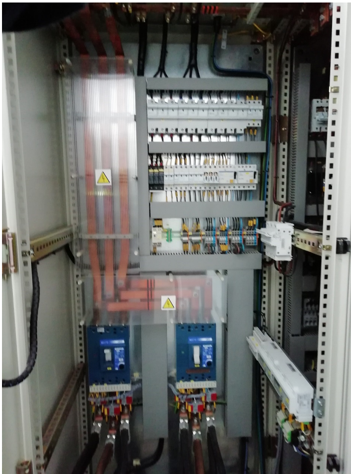
Foto rozvaděče RM6717 pole 1
