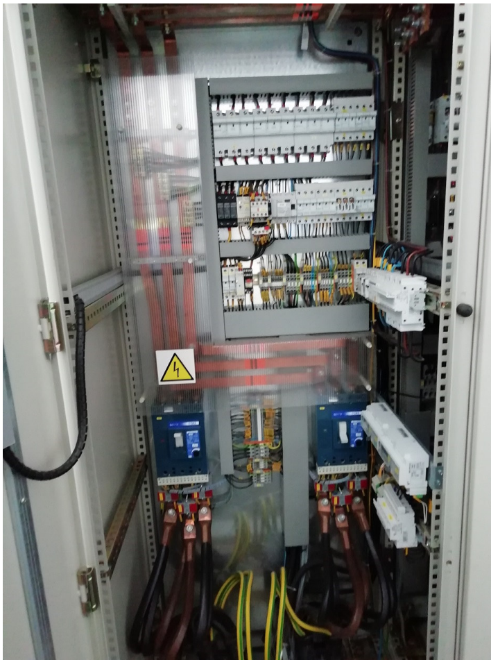
Foto rozvaděče RM6716 pole 1
