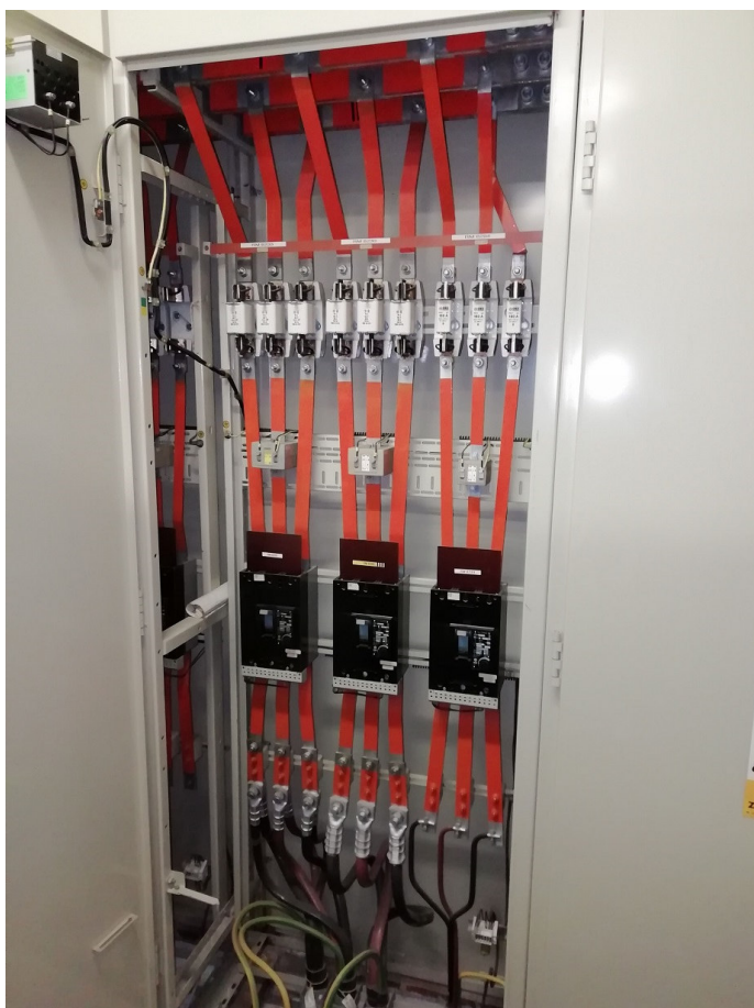
Foto rozvaděče RMH5 pole 5 (pole 3 a pole 4 jsou obdobná)
