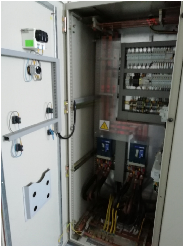
Foto rozvaděče RM6718 pole 1
