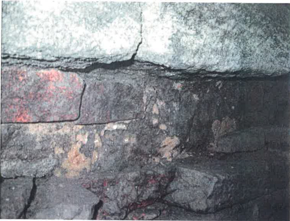
Foto – detail degradace zdiva a pojiva
