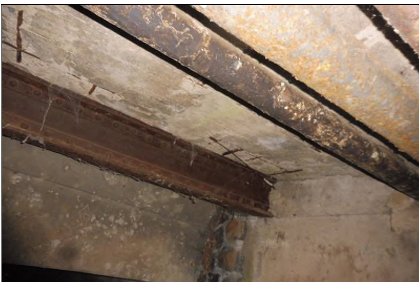
Koroze oc. nosníků.
