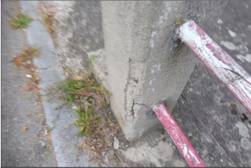
Degradace bet. sloupku, deg. nátěru zábradlí.
