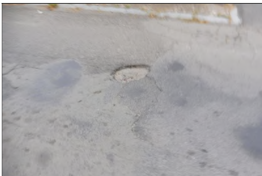
Výtluky na vozovce.
