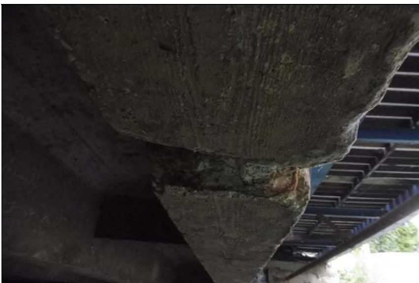
Odhalená korodující výztuž na spodku trámu.
