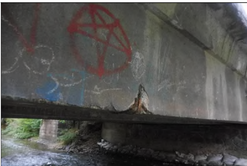
Poruchy na boku trámu.
