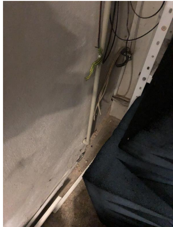
Obr. 21 FOTO Střední zdivo zkušební hala x vstupní schodiště – vlhkostní poruchy, instalace
