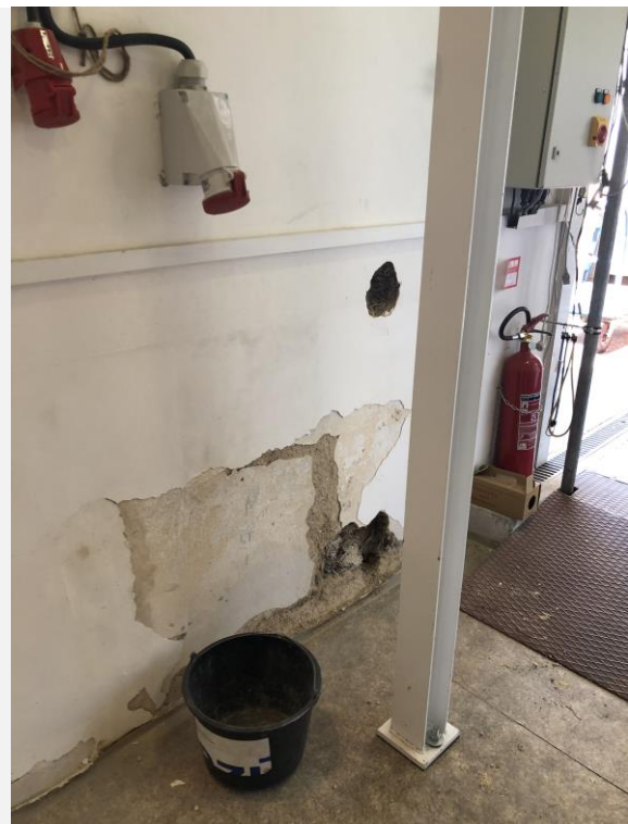
Obr. 15 FOTO Interiér zkušební haly vlhkostní poruchy - sondy
