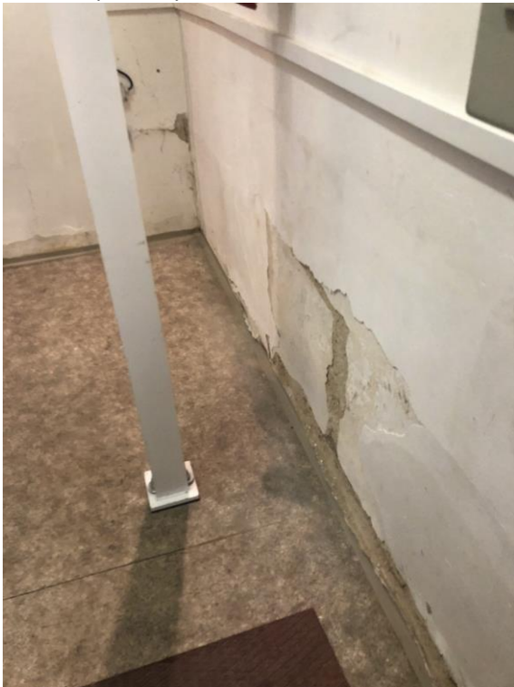
Obr. 12 FOTO Interiér zkušební haly vlhkostní poruchy zdiva
