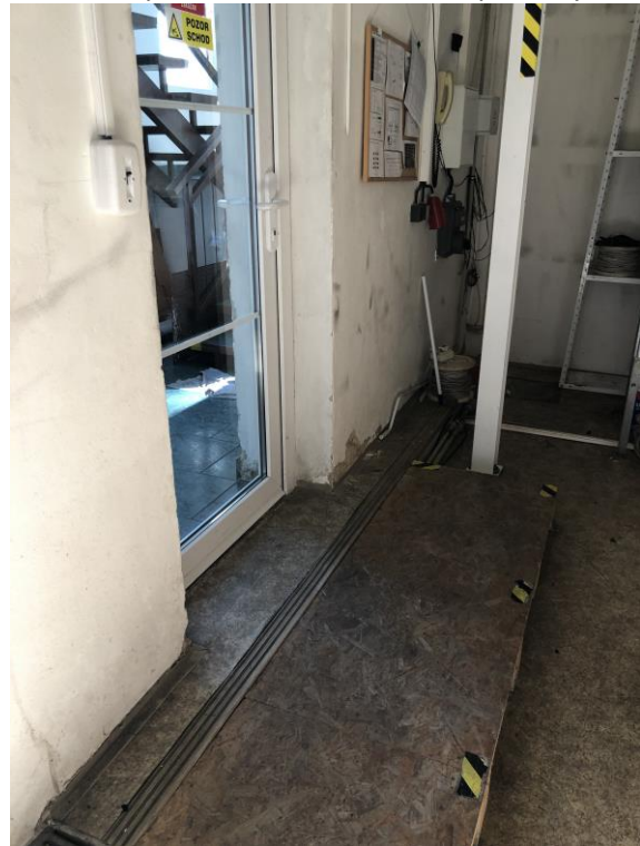
Obr. 17 FOTO Střední zdivo zkušební hala x vstupní schodiště – vlhkostní poruchy
