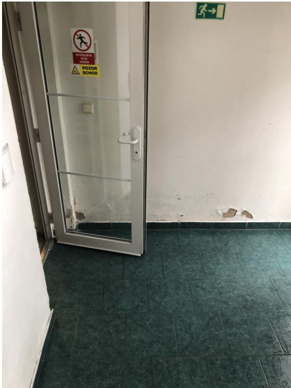
Obr. 20 FOTO Interiér schodiště vlhkostní poruchy obv. zdiva
