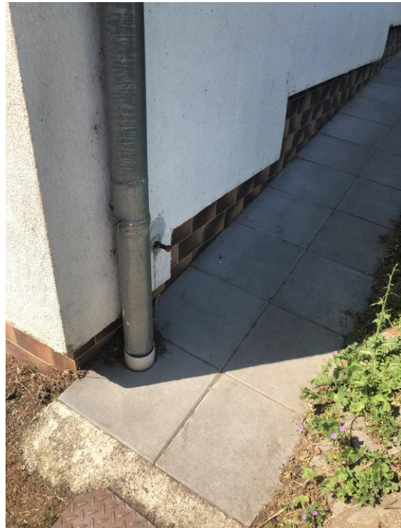
Obr. 9 FOTO Jihovýchodní nároží, dešťový svod – absence gajgru, ukončená KZS východní fasáda
