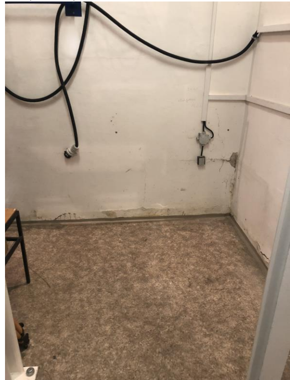
Obr. 13 FOTO Interiér zkušební haly vlhkostní poruchy zdiva
