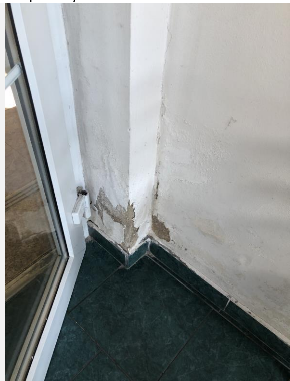
Obr. 19 FOTO Interiér schodiště vlhkostní poruchy obv. zdiva
