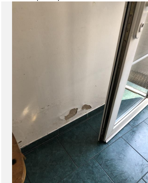
Obr. 18 FOTO Interiér schodiště vlhkostní poruchy obv. zdiva
